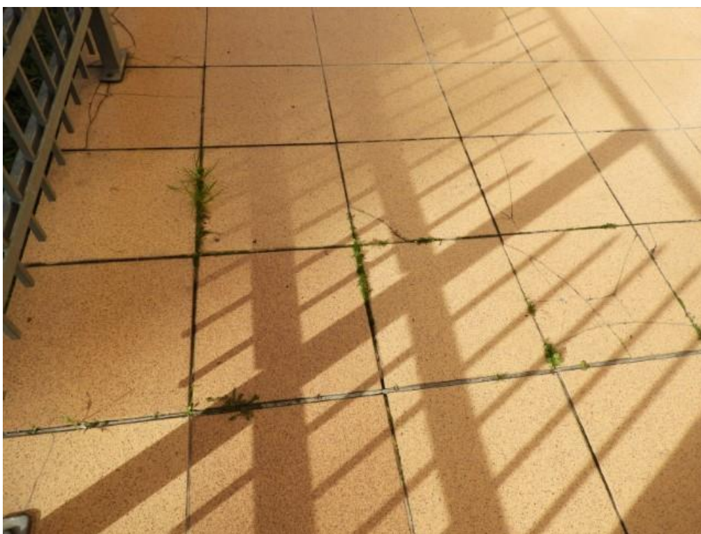
8. Spękane i odspojone płytki na tarasie zewnętrznym.
