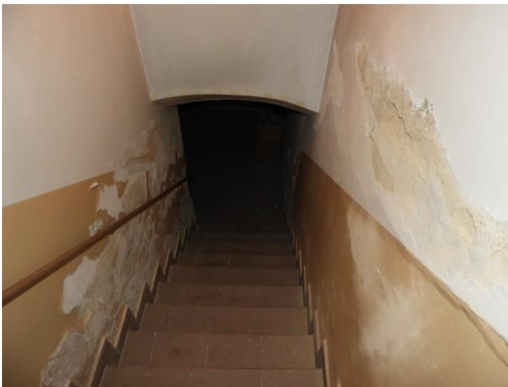
3. Zawilgocenia ścian w piwnicy.
