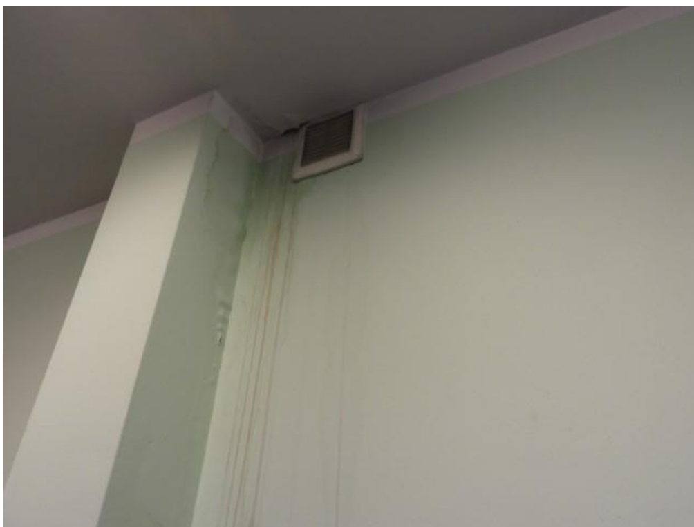
7. Bawialnia – zawilgocenia przy kratce wentylacyjnej.
