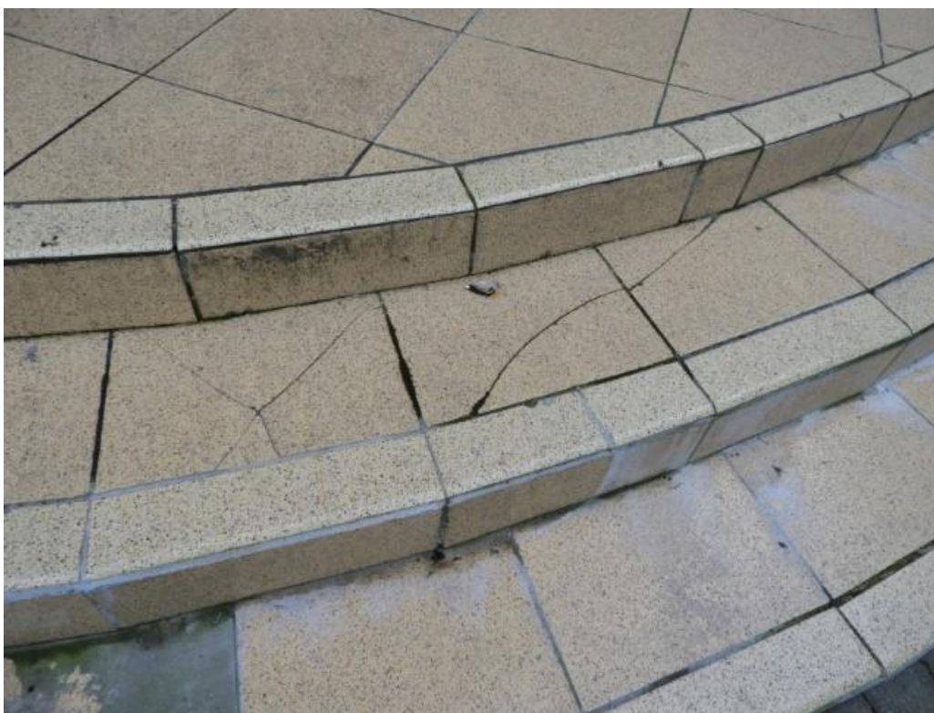
2. Spękane i odspojone płytki podestu wejściowego do budynku.
