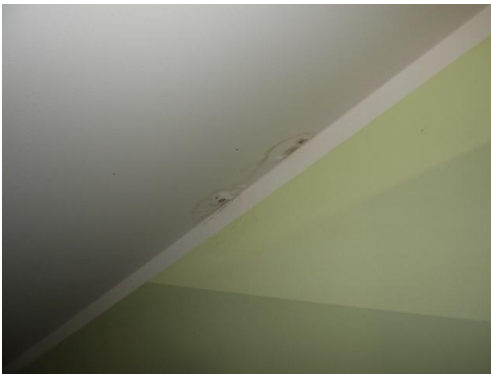
5. Zawilgocenia w pokoju na drugim piętrze.
