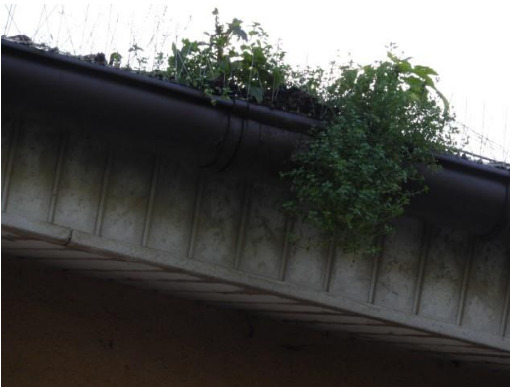
1. Zanieczyszczenia w rynnie.
