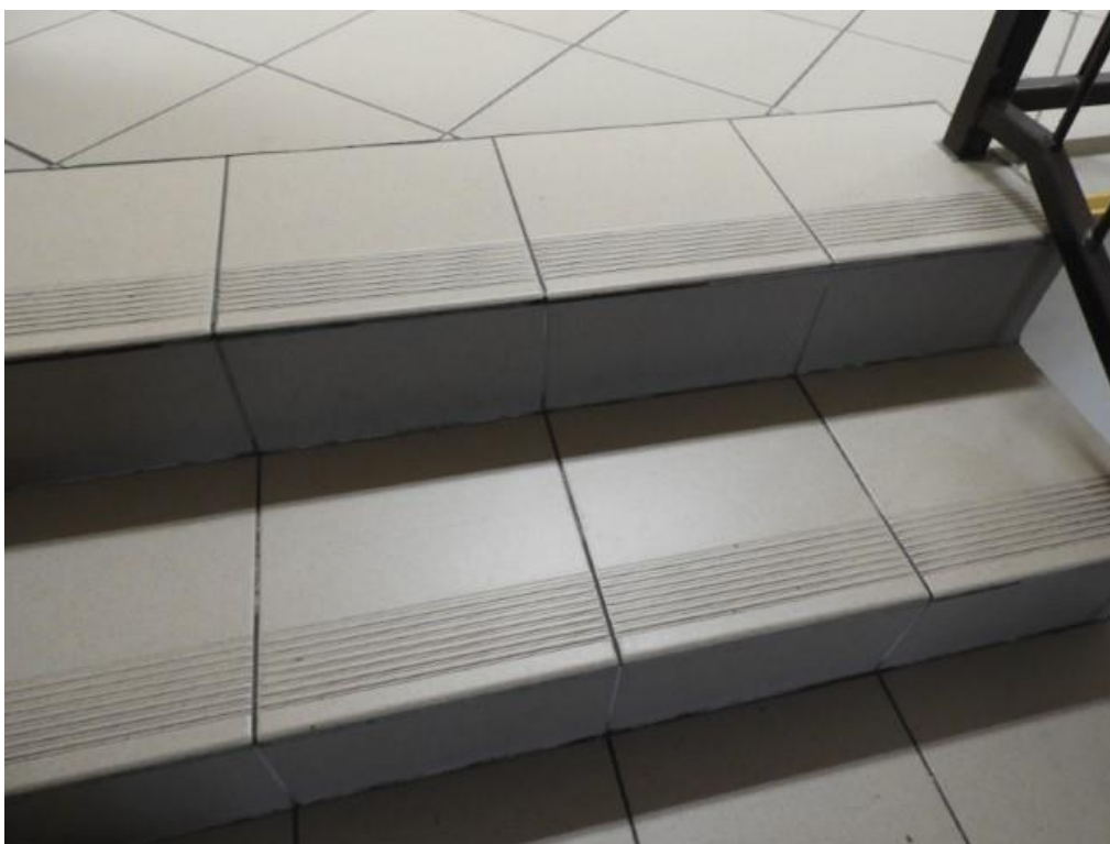
6. Odspojone płytki na schodach.
