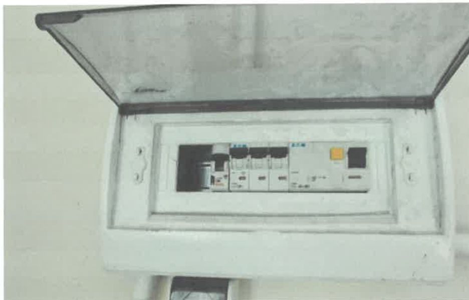
Zdjęcie nr 4. Rozdzielnica RG - widok
