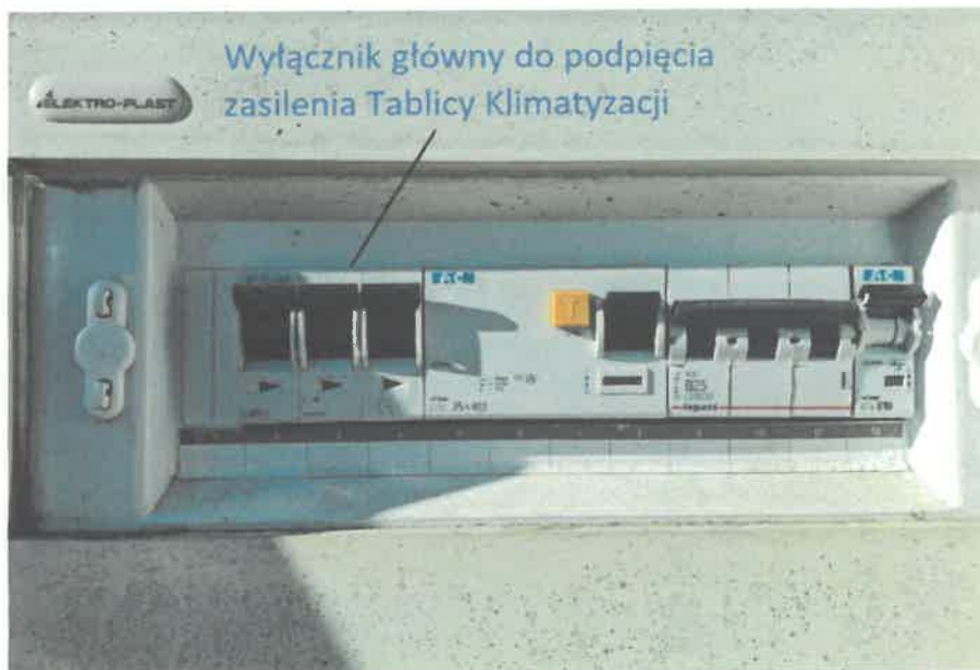
Zdjęcie nr 5. Rozdzielnia RG - miejsce do podpięcia zasilania Tablicy Klimatyzacji.
