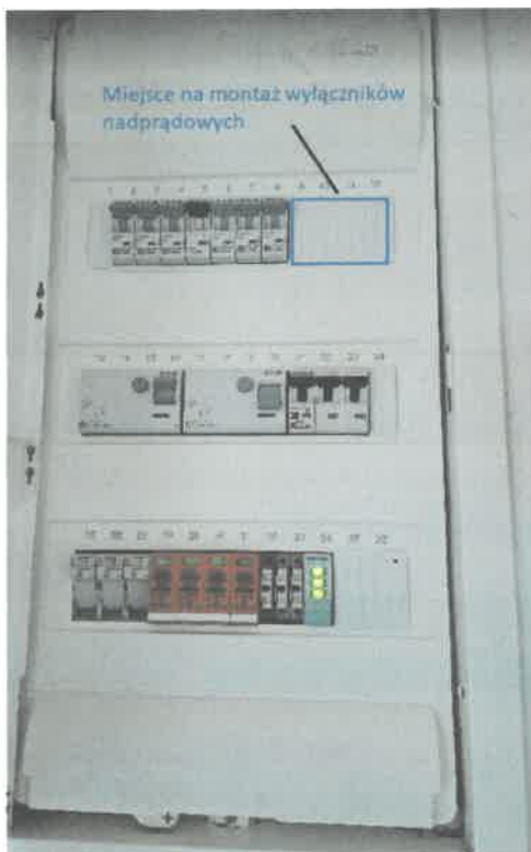
Zdjęcie nr 2. Rozdzielnica RG - wolne miejsce na dodatkowe 4 sztuki wyłączników nadprądowych.
