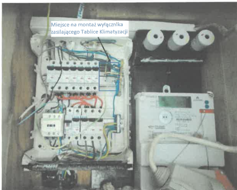
Zdjęcie nr 3. Rozdzielnica RG - wolne miejsce na wyłącznik zasilania Tablicy Klimatyzacji.
