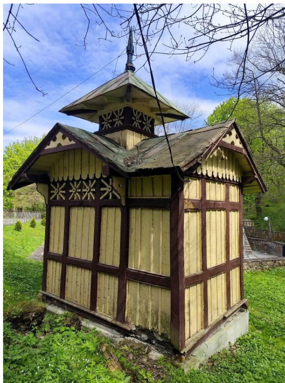
Fot.5. Widok ogólny na pawilon „Józia” od strony zachodniej. Widoczne znaczące zniszczenia podwaliny i dolnej partii ściany bocznej elewacji. Po lewej stronie dłuższa elewacja północno-zachodnia pawilonu, po prawej stronie krótka tylna elewacja południowo-zachodnia.
