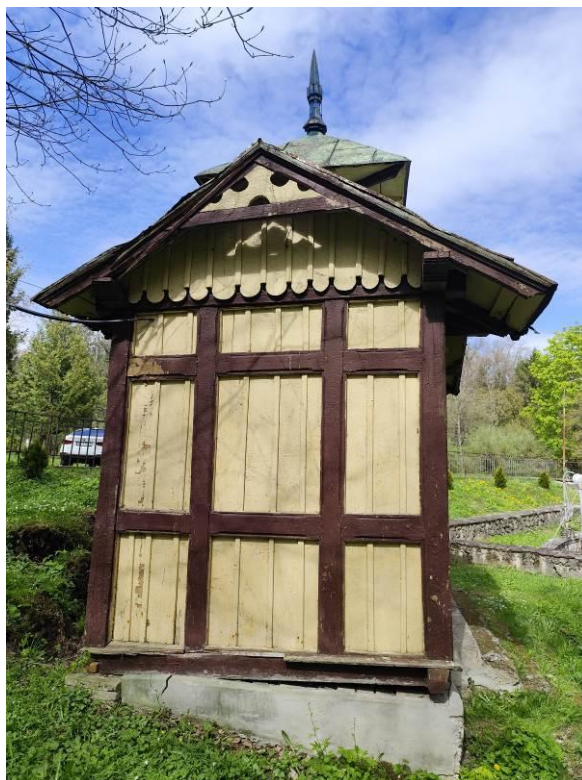
Fot.6. Widok ogólny na pawilon „Józia” od strony południowo-zachodniej. Tylne elewacja pawilonu, całkowicie wtórna, zbudowana współcześnie w wyniku rozbudowy o część zaplecza.
