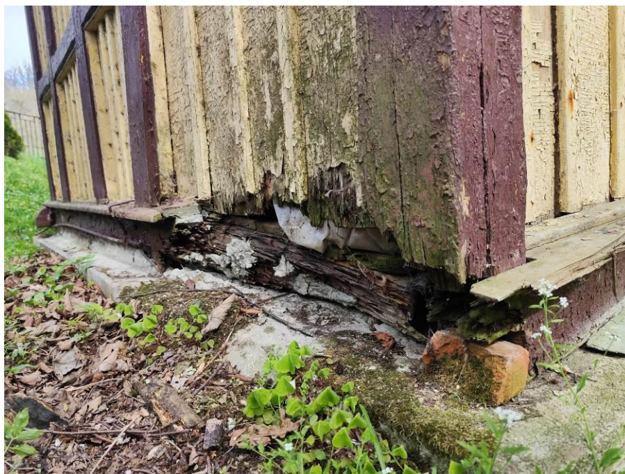
Fot.10. Widok ogólny na zachodni narożnik z podwaliną w bocznej elewacji, pawilonu „Józia”. Opadnięte fundamenty wtórnej dobudówki zachodniej, kompletnie zniszczona podwalina i fragment deskowania ściennego.
