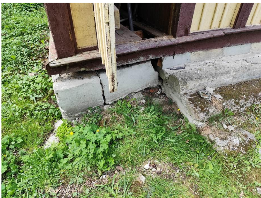
Fot.9. Widok ogólny na południowy narożnik z podwaliną pawilonu „Józia”. Opadnięte fundamenty wtórnej dobudówki zachodniej.
