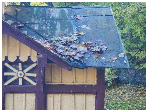
Fot. 71. Korozja desek wiatrowych i liście zalegające w koszach dachu.
