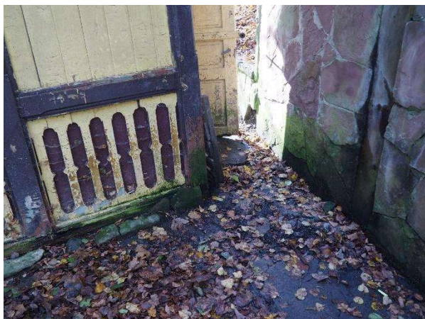
Fot.30. Spękania i zapadnięte fundamenty. Podwaliny i fragmenty słupów zniszczone w wyniku działania grzybów domowych. Brak izolacji poziomej. Duże skupiska liści i gruntu przykrywające fragmenty podwalin i fundamentów
