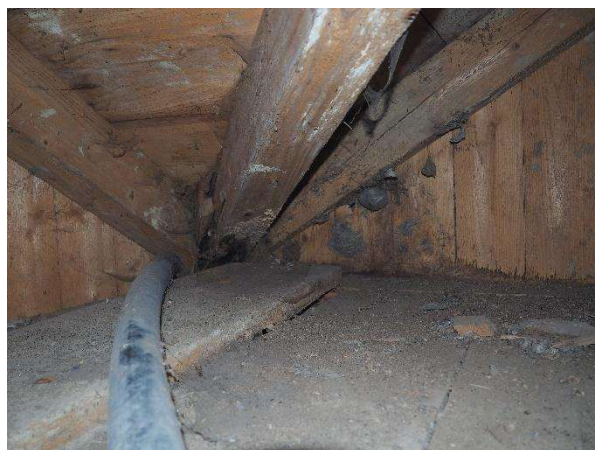
Fot. 97. Styk krokwi narożnych porażony przez grzyby domowe. Widoczny brunatny rozkład drewna.
