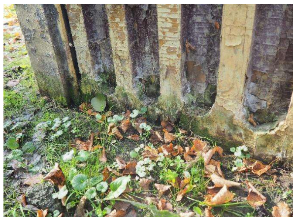
Fot. 35. Podwalina i fundament zanurzone w podmokłym gruncie. Niska roślinność wyrastająca z podwaliny i w otoczeniu budynku. Ubytki i spękania warstw malarskich.
