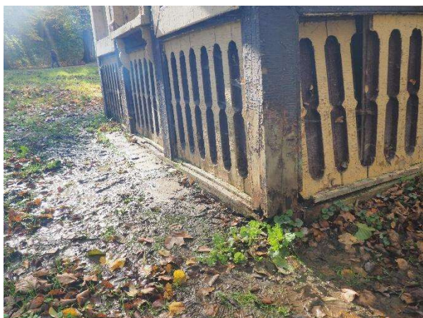
Fot.32. Podwaliny i fundamenty schowane w podmokłym gruncie. Niska roślinność wyrastająca spod podwaliny. Rozkład brunatny elementów drewnianych w strefie przyziemia. Ubytki i spękania warstw malarskich. Panel drewniany zapadnięty do wnętrza budynku w wyniku biokorozji drewna.
