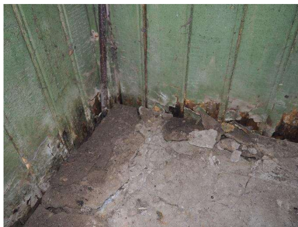
Fot. 91. Dolne strefy szalunku porażone przez grzyby domowe. Spękania posadzki betonowej w wyniku korozji mrozowej.
