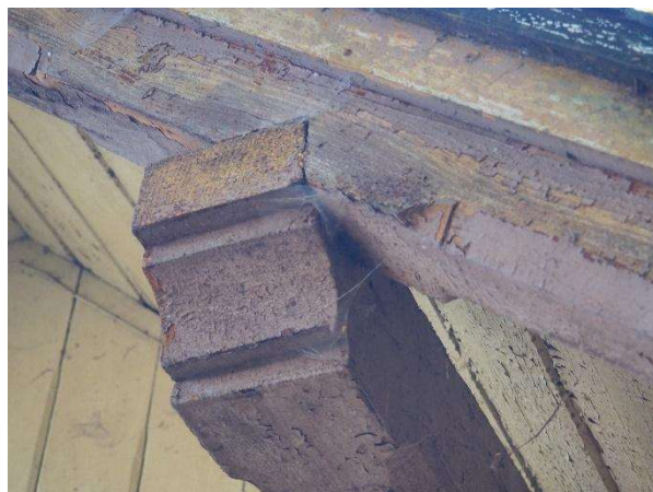
Fot. 19. Spękania i ubytki warstw malarskich. Szary rozkład drewna na licu rysia. W górnym, prawym rogu widoczna biała grzybnia.
