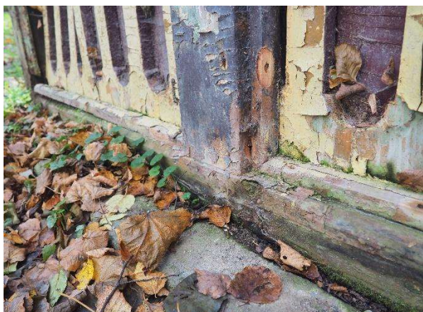
Fot. 34. Podwalina i część fundamentu zanurzone w podmokłym gruncie, częściowo przykryte warstwą liści. Niska roślinność wyrastająca z podwaliny. Spękania i ubytki warstw malarskich. Rozkład brunatny podwaliny drewnianej.
