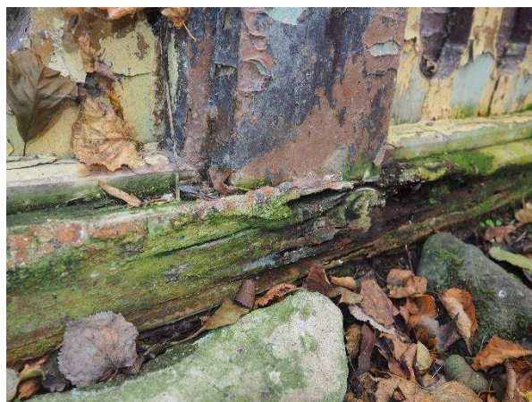
Fot. 33. Brak izolacji poziomej. Rozkład brunatny podwaliny. Popękane fundamenty, które utraciły właściwości konstrukcyjne i nośne. Spękania i ubytki warstw malarskich. Resztki fundamentów zakryte częściowo liśćmi i błotem.
