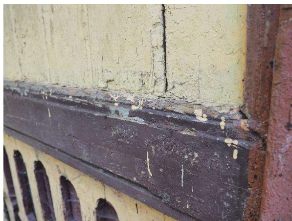
Fot. 45. Spękania i ubytki warstw malarskich.
