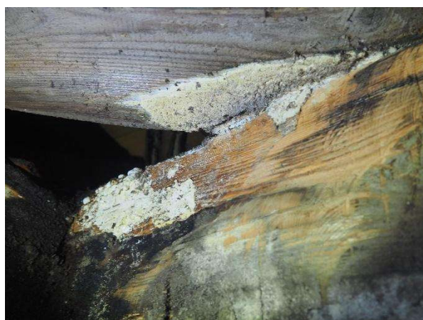
Fot. 89. Biała grzybnia na belkach stropowych i deskowaniu stropu.
