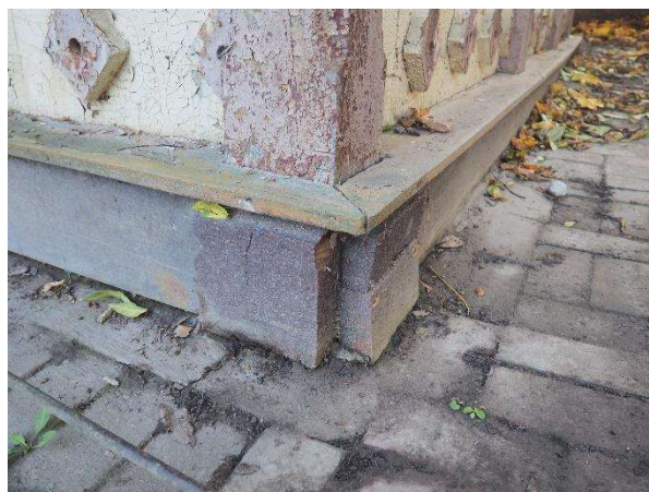
Fot. 11. Brak izolacji poziomej. Nawarstwienia gruntu na styku podwaliny drewnianej z kostką brukową. Ubytki i spękania warstw malarskich.
