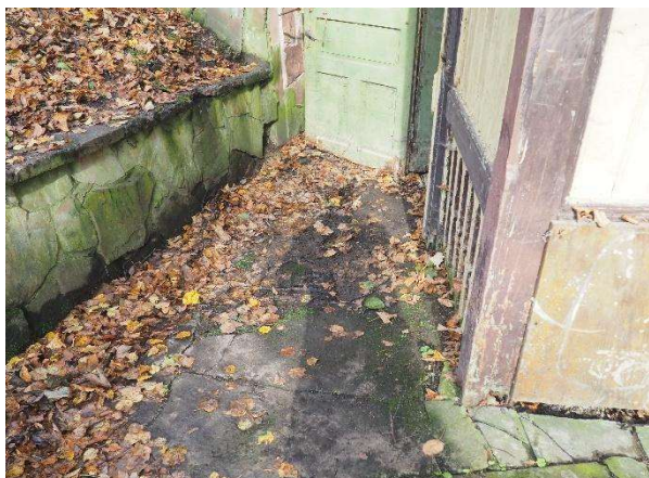
Fot. 36. Spękania opaski betonowej wokół kiosku i załamanie w kierunku elewacji. Zalegająca warstwa błota i liści dochodząca do elewacji kiosku. Mur na krawędzi skarpy popękany i porażony glonami, porostami i mchami. Panel zniszczony korozją biologiczną zakryty drewnianą płytą. Rozkład brunatny drewna w strefie przyziemia.
