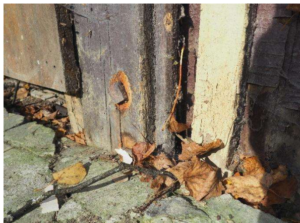
Fot. 37. Strefa wejścia do budynku. zarówno podwalina jak i drewniane elementy konstrukcji stykają się bezpośrednio z betonową posadzką w złym stanie technicznym.
