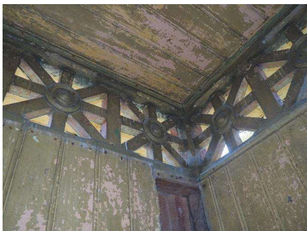
Fot. 96. Detal wnętrza wieży. Spękania i ubytki warstw malarskich na ścianach i suficie.
