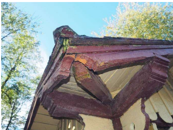
Fot. 74. Korozja krokwi, desek wiatrowych i krawędzi blachy dachowej.
