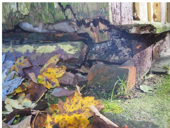
Fot. 59. Rozkład brunatny podwalin i dolnych fragmentów paneli elewacyjnych. Spękania i ubytki warstw malarskich. Niska roślinność wyrastająca przy podwalinie. Brak izolacji poziomej.
