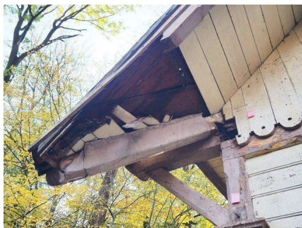
Fot. 27. Widoczna korozja biologiczna podbitki drewnianej. Usztywnienie krokwi przy użyciu blachy. Rozkład brunatny drewna na styku krokwi z murłatą. Widoczne ubytki w szalunku drewnianym. Spękania i ubytki warstw malarskich.
