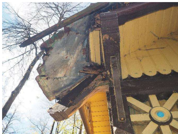
Fot. 49. Ubytki pokrycia połaci dachowej w wyniku korozji blachy na dachu. Rozkład brunatny krokwi i elementów więźby dachowej.
