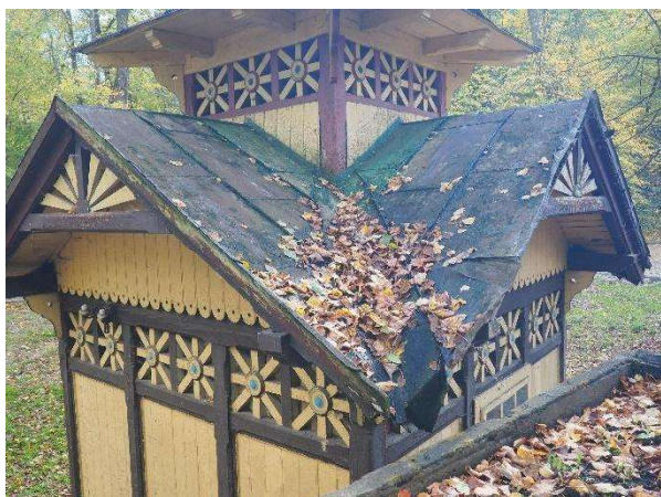
Fot. 46. Ubytki pokrycia połaci dachowej w wyniku korozji blachy na dachu. Warstwa torfu i liści zalegająca w koszu połaci dachowej.
