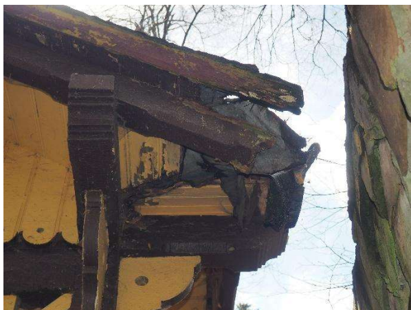
Fot. 48. Ubytki pokrycia połaci dachowej w wyniku korozji blachy na dachu. Rozkład brunatny krokwi i elementów więźby dachowej.
