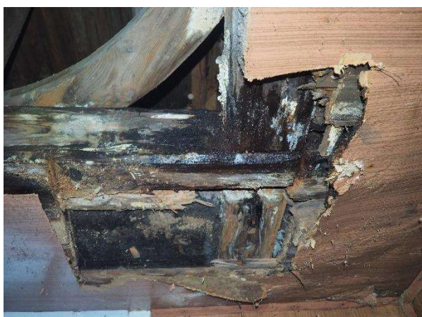
Fot. 88. Rozkład brunatny belek stropowych i deskowania stropu. Drewniane elementy zawilgocone wodami opadowymi przenikającymi przez nieszczelności w poszyciu dachowym.
