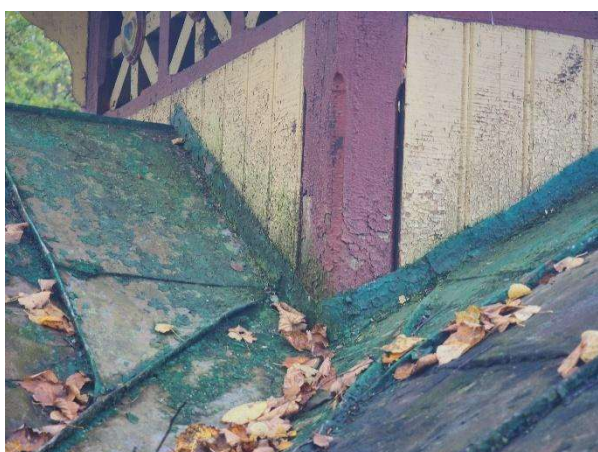
Fot. 52. Korozja blachy dachowej.
