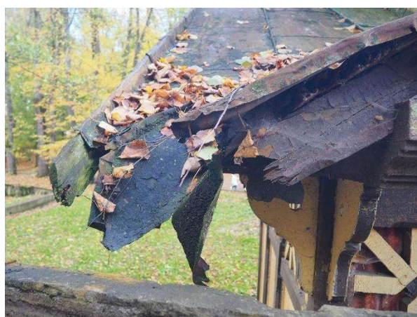
Fot. 53. Ubytki pokrycia połaci dachowej w wyniku korozji blachy na dachu. Rozkład brunatny krokwi i elementów więźby dachowej.
