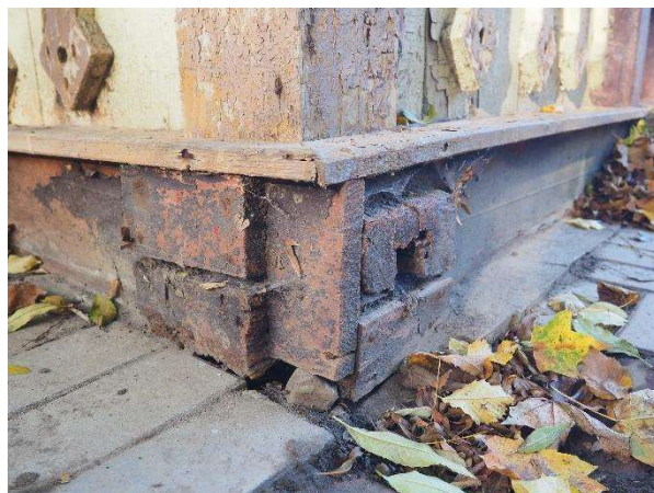
Fot. 13. Brak izolacji poziomej. Widoczne wtórne flekowania fragmentów podwaliny. Podwalina leżąca bezpośrednio na gruncie. Spękania i ubytki warstw malarskich. Wilgotność drewna powyżej 60%
