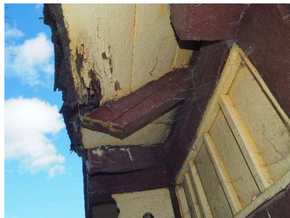
Fot. 75. Korozja biologiczna krokwi i podbitki drewnianej.
