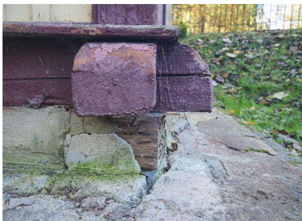
Fot. 66. Spękania opaski betonowej w wyniku korozji mrozowej. Ubytki i spękania warstw malarskich. Podwalina podparta na klocku dębowym zasłoniętym zaprawą cementową.
