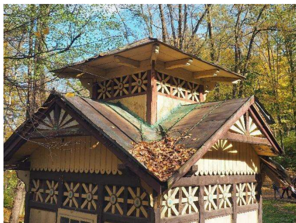
Fot. 47. Ubytki pokrycia połaci dachowej w wyniku korozji blachy na dachu. Warstwa torfu i liści zalegająca w koszu połaci dachowej.
