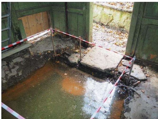
Fot. 92. Niezabezpieczony zbiornik wody źródlanej. Wilgoć migruje w głąb niez izolowanych posadzek betonowych co prowadzi do dużego zawilgocenia dolnych partii budynku i znajdujących się w tej strefie elementów drewnianej konstrukcji budynku.
