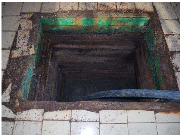
Fot. 78. Niezabezpieczony wjazd do studni.
