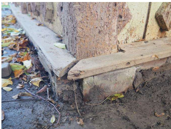
Fot. 12. Podwalina drewniana zagłębiona w gruncie. Rozkład brunatny widoczny na podwalinie drewnianej. Widoczny brak izolacji poziomej. Spękania i ubytki warstw malarskich. Wilgotność drewna powyżej 60%. Niska roślinność wyrastająca z pod podwaliny.
