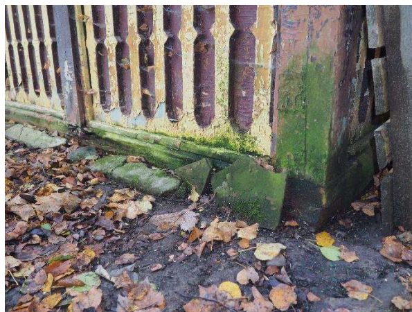
Fot. 31. Podwalina zanurzona w gruncie i przykryta warstwą liści i błota. Brak izolacji poziomej. Widoczne spękania fundamentów. Duże skupiska glonów i porostów.
