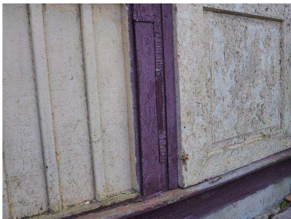
Fot. 68. Spękania i ubytki warstw malarskich. W ościeżnicy flek powstały prawdopodobnie podczas ostatniej konserwacji kiosku.
