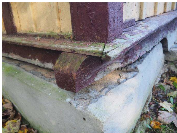
Fot. 61. Fragment oderwanego fundamentu w wyniku osunięcia gruntu pod nim. Widoczne skupiska glonów na okapniku osłaniającym podwalinę. Brak izolacji poziomej
