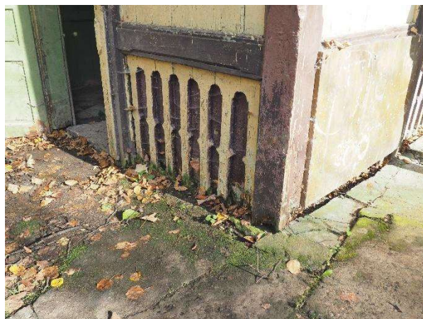
Fot. 43. Spękania opaski betonowej wokół kiosku i załamanie w kierunku elewacji.
