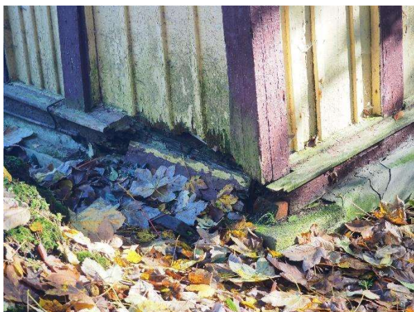
Fot. 58. Podwalina i fundament pograżony w gruncie i przykryty liśćmi. Lewy, dolny panel zniszczony w wyniku biokorozji. Ubytki i spękania warstw malarskich. Niska roślinność wyrastająca przy podwalinie. Brak izolacji poziomej.
