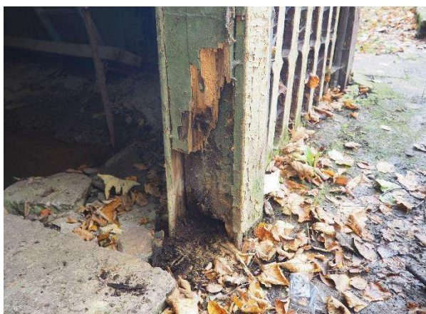
Fot. 38. Podwaliny i fundament zanurzony w gruncie. Warstwa błota i liści przykrywająca ściany w strefie przyziemia. Ościeżnica drzwi zniszczona w wyniku żerowania owadów ksylofagicznych i grzybów domowych.
