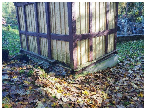
Fot. 57. Podwalina i fundament pograżony w gruncie i przykryty liśćmi. Lewy, dolny panel zniszczony w wyniku biokorozji. Ubytki i spękania warstw malarskich.
