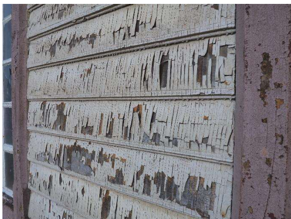
Fot. 16. Widoczne spękania i ubytki warstw malarskich. Niektóre fragmenty elewacji z widocznym rozkładem szarym drewna.
