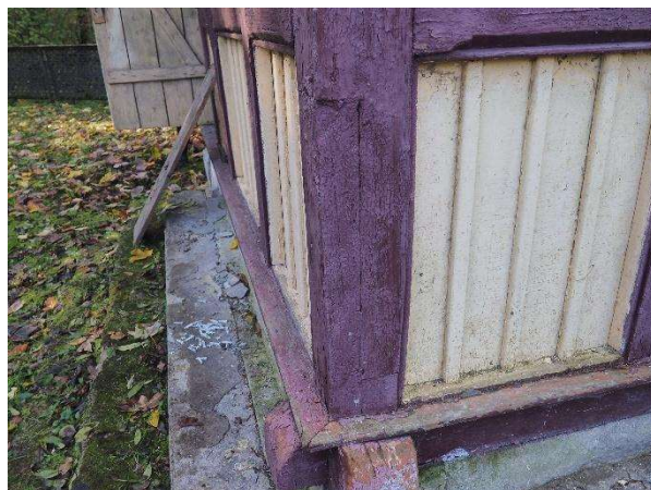
Fot. 69. W słupku narożnym flek zamontowany podczas ostatniej konserwacji kiosku. Ubytki i spękania warstw malarskich.
