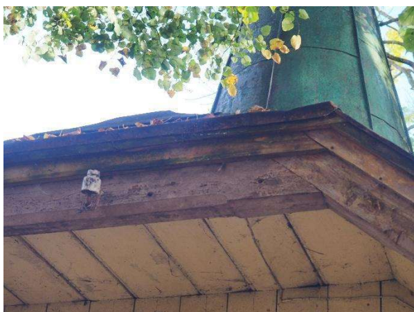
Fot. 26. Widoczna korozja biologiczna strefy okapowej dachu wynikająca ze złego wykonania obróbek blacharskich.
