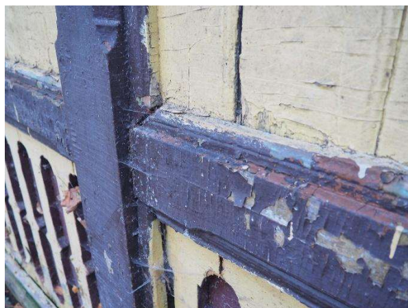
Fot. 41. Ubytki i spękania warstw malarskich.
