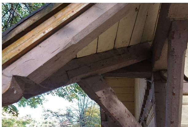
Fot. 22. Widoczne flekowanie i naprawy krokwi.
