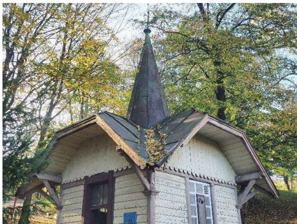
Fot. 20. Na styku dwóch połaci dachu widoczne zalegające liście i zanieczyszczenia. Widoczna korozja blachy pokrycia dachu.
