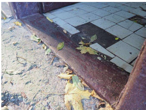
Fot. 80. Płytki ceramiczne oderwane od posadzki. Próg drewniany schowany w betonie. widoczne spękania powierzchni betonu schodów w wyniku korozji mrozowej i czynników abiotycznych.
