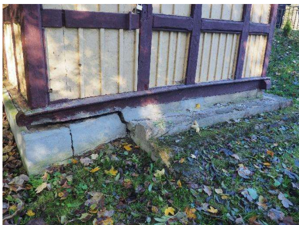
Fot. 60. Fragment oderwanego fundamentu w wyniku osunięcia gruntu pod nim. Brak izolacji poziomej
