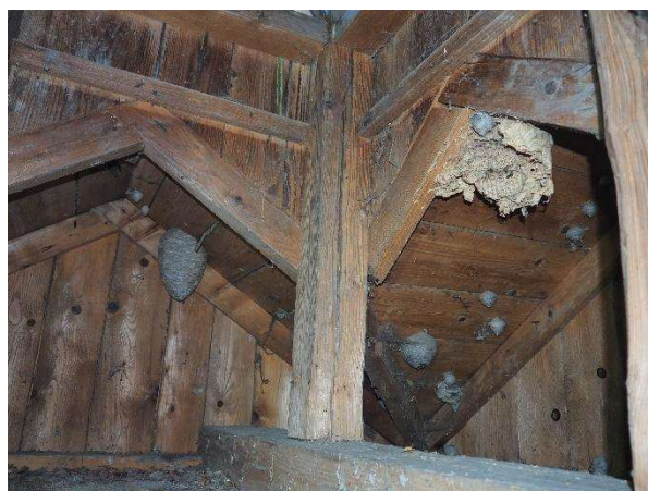
Fot. 109. Sinizna widoczna na deskach pionowych.
