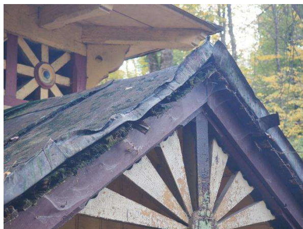
Fot. 51. Ubytki pokrycia połaci dachowej w wyniku korozji blachy na dachu. Rozkład brunatny krokwi i desekowania dachu.
