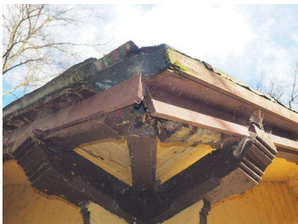
Fot. 50. Ubytki pokrycia połaci dachowej w wyniku korozji blachy na dachu. Rozkład brunatny krokwi i elementów więźby dachowej.
