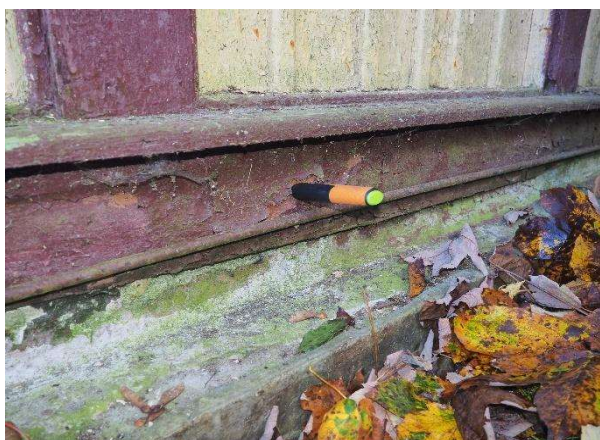
Fot. 64. Fundament zakryty gruntem i liśćmi. Brak izolacji poziomej. Rozkład brunatny podwaliny. Spękania i ubytki warstw malarskich. Nóż o długości 12 cm z łatwością zagłębił się w podwalinę, co świadczy o utracie przez drewno właściwości konstrukcyjnych i nośnych.
