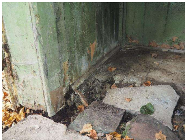
Fot. 93. Zapadnięta posadzka w wyniku osunięcia gruntu pod posadzką.
