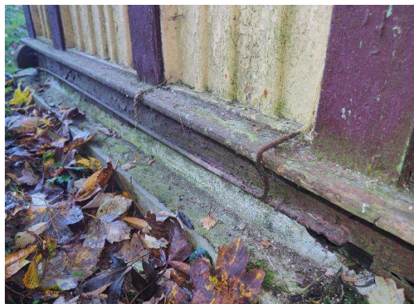
Fot. 63. Fundament zakryty gruntem i liśćmi. Brak izolacji poziomej. Rozkład brunatny podwaliny. Spękania i ubytki warstw malarskich.
