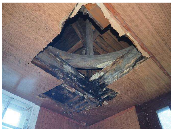
Fot. 83. Strop odsłonięty podczas wykonywania inwentaryzacji. Widoczne owocniki i grzybnia grzyba domowego.
