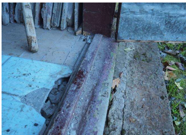
Fot. 102. Spękana posadzka betonowa. Między progiem i schodkiem zewnętrznym brak izolacji pionowej.
