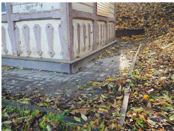
Fot. 10. Brak izolacji poziomej. Rozkład brunatny drewna podwalin. ubytki w warstwach malarskich elewacji. Spadek terenu w kierunku budynku.
