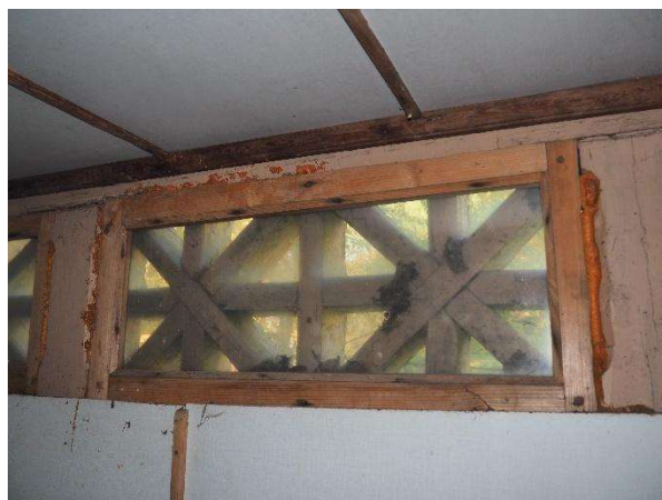
Fot. 103. Wtórne zabezpieczenie okna. Widoczna pianka poliuretanowa.
