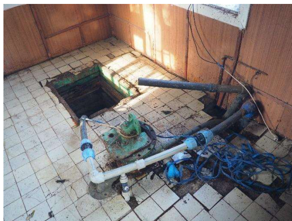
Fot. 81. Niedostateczny stan urządzeń w pomieszczeniu źródła.
