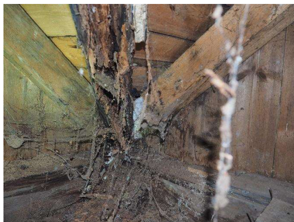
Fot. 87. Rozkład brunatny krokwi dachowej
