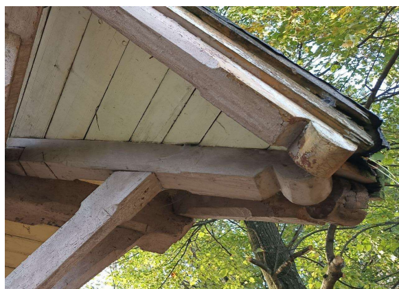
Fot. 23. Widoczne flekowanie i naprawy krokwi.
