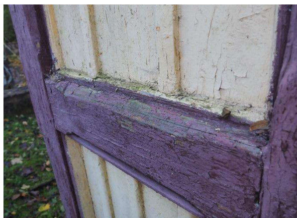
Fot. 65. Ubytki i spękania warstw malarskich.
