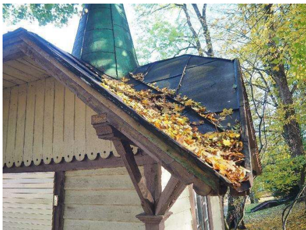
Fot. 24. Liście zalegające na styku połaci dachowych. Widoczna korozja blachy na połaci dachowej.
