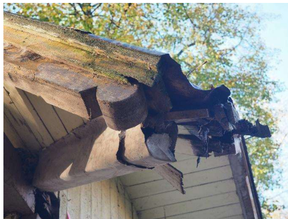
Fot. 21. Widoczne ubytki zakończeń krokwi dachu. Fragmenty krokwi zabezpieczone wtórnie blachą. Na desce wiatrowej widoczny brunatny rozkład drewna. Deska porażona przez glony i grzyby domowe. Widoczna korozja blachy pokrycia dachu. W lewym, dolnym rogu widoczny brunatny rozkład drewna murłaty i rysy.
