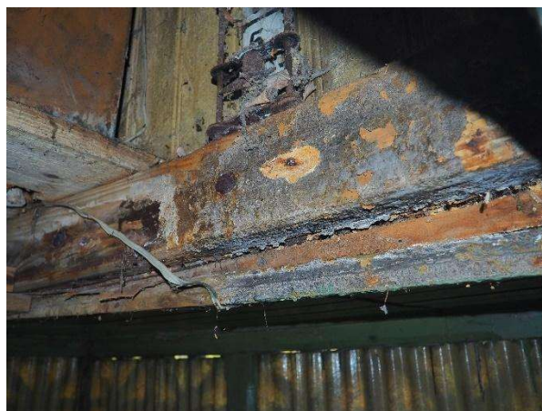
Fot. 95. Belka stropowa porażona przez grzyby domowe.
