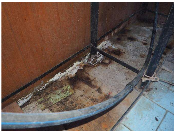
Fot. 100. Na podłodze i dolnej partii ścian widoczna biała grzybnia grzyba domowego.
