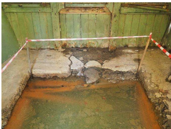
Fot. 94. Osunięcie posadzki betonowej do studni źródła.
