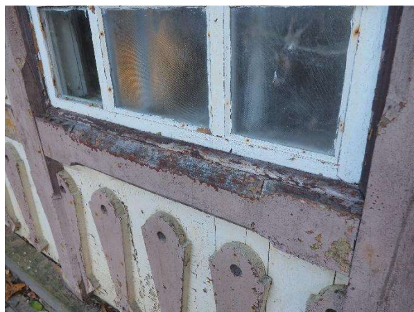
Fot. 17. Widoczne spękania i ubytki warstw malarskich. Ubytki i spękania farb malarskich na ramie okna. Rozkład brunatny drewna na styku okna z ościeżnicą. Brak szyby.
