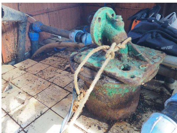
Fot. 82. Niedostateczny stan urządzeń w pomieszczeniu źródła.
