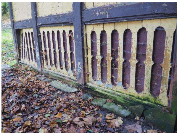
Fot. 40. Podwalina zagłębiona w gruncie i przykryta warstwą liści oraz błota.
