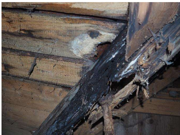
Fot. 84. Belka uległa biokorozji, w wyniku czego utraciła właściwości konstrukcyjne i nośne.
