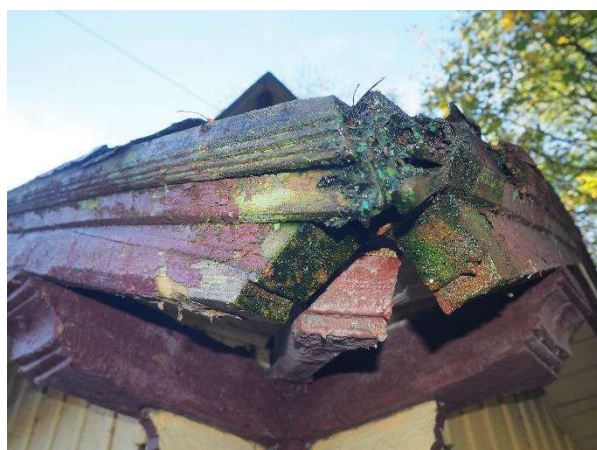
Fot. 73. Korozja krokwi, desek wiatrowych i krawędzi blachy dachowej.
