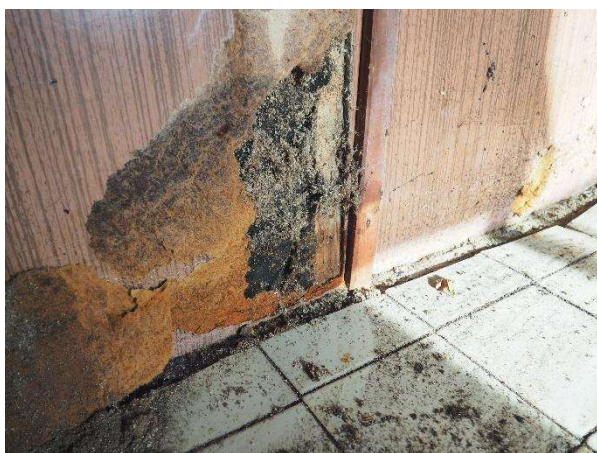
Fot. 76. Zawilgocenie płyty HDF. Brak izolacji pionowej.
