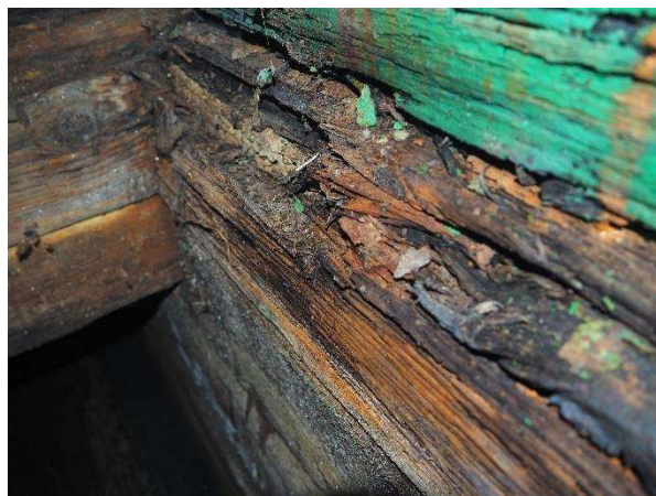
Fot. 79. Rozkład brunatny drewna cembrowiny w studni.
