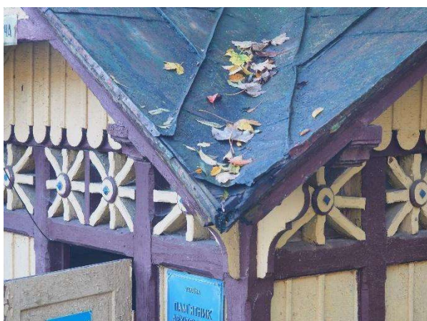
Fot. 72. Korozja desek wiatrowych i krawędzi krokwi. Liście zalegające w koszach dachu.
