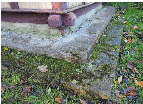
Fot. 62. Schody okrążające kiosk. Spękania powstałe w wyniku korozji mrozowej. Schodek pokryty mchami zatrzymującymi wodę.
