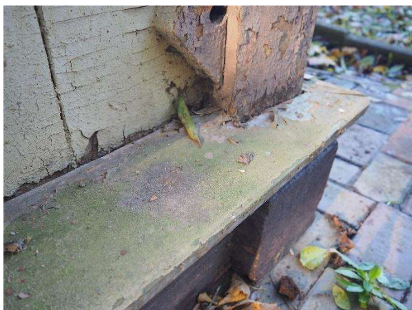
Fot. 14. widoczny okap porażony przez glony. Widoczny rozkład brunatny drewna na styku okapnika ze słupkiem narożnym. Niska roślinność wyrastająca między kostkami brukowymi. Spękania i ubytki warstw malarskich.
