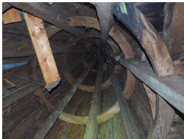
Fot. 85. Więźba dachowa w górnej części zdjęcia widoczna biała grzybnia.
