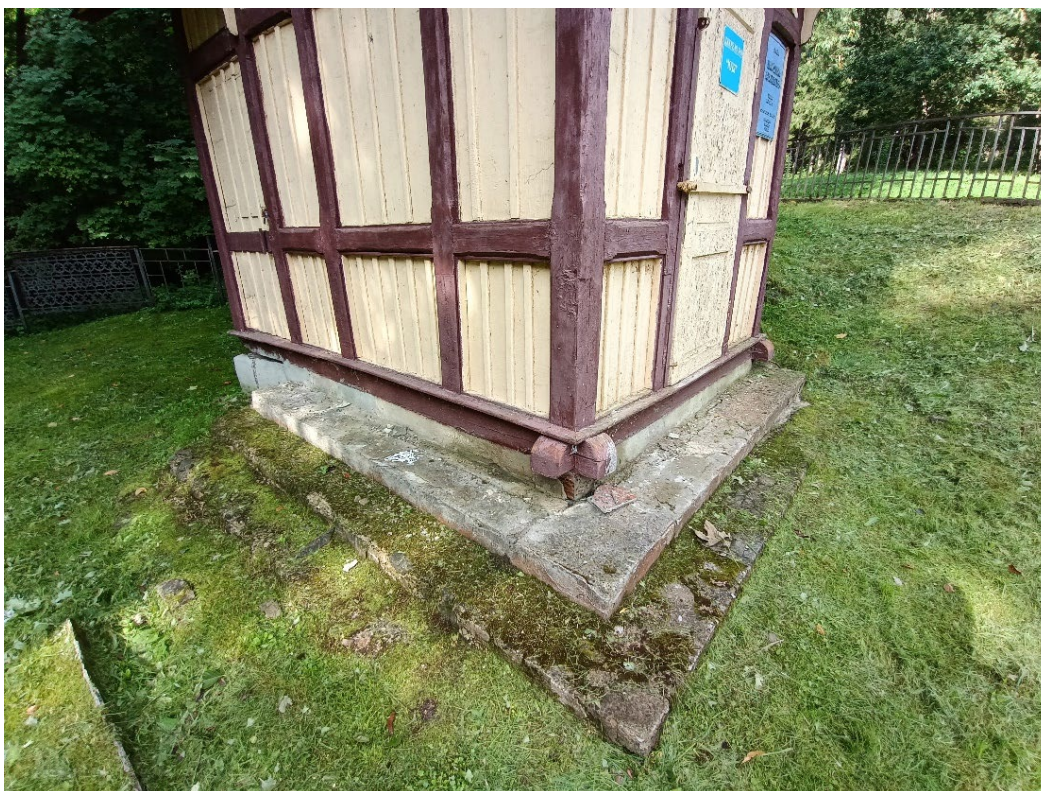
Fot 13. korozja mrozowa schodów betonowych i opaski budynku. fot. E. Wilbik 2023
