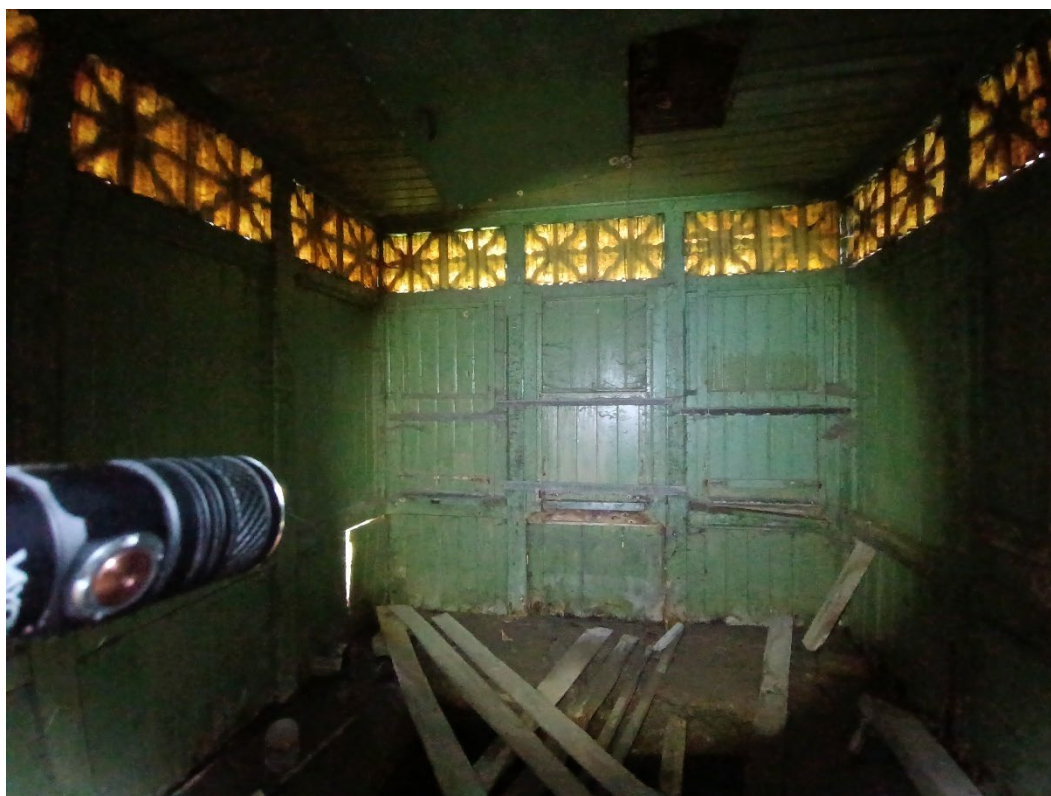
Fot 12. Brak podłogi w obiekcie, widoczna studnia źródła, korozja elementów konstrukcyjnych ścian. fot. E. Wilbik 2023
