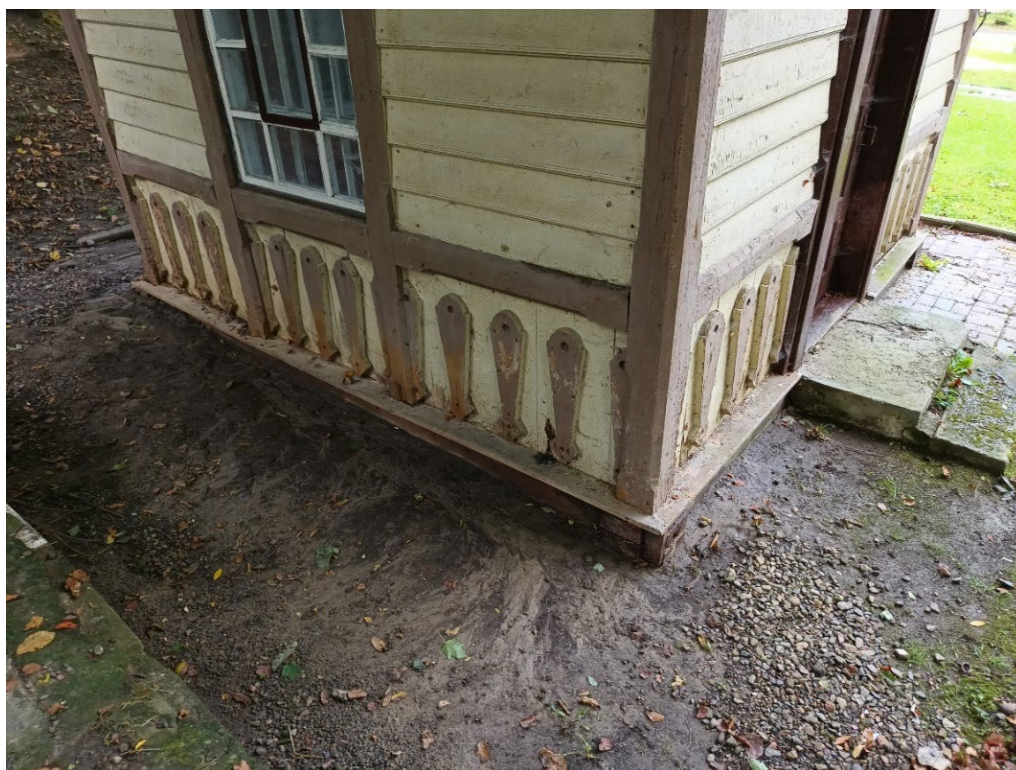
Fot 5. Powalina zalewana wodą i zasłonięta gruntem. fot. E. Wilbik 2023
