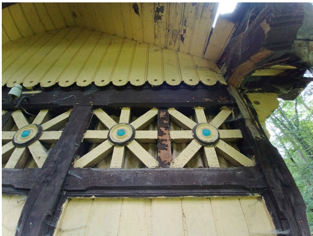
Fot 9. Zniszczenie fragmentu więźby dachowej i ubytki w nawarstwieniu warstw kolorystycznych. fot. E. Wilbik 2023
