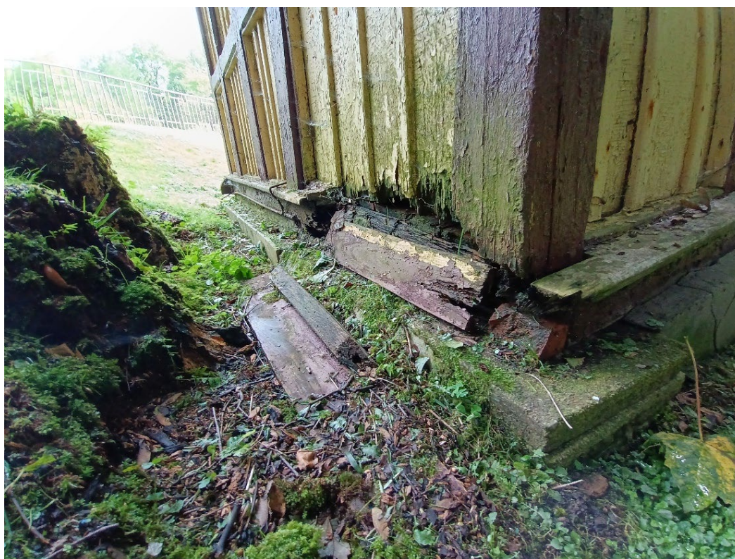
Fot 14. Korozja biologiczna podwaliny budynku, korozja warstw malarskich elewacji. spękania na fundamencie budynku. fot. E. Wilbik 2023
