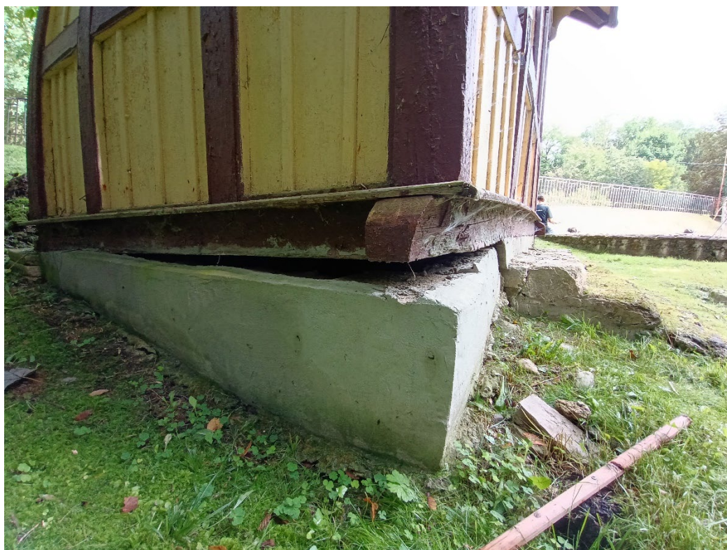
Fot 16. fragment fundamentu zapadnięty w gruncie. Przy schodach widoczne pęknięcia. fot. E. Wilbik 2023
