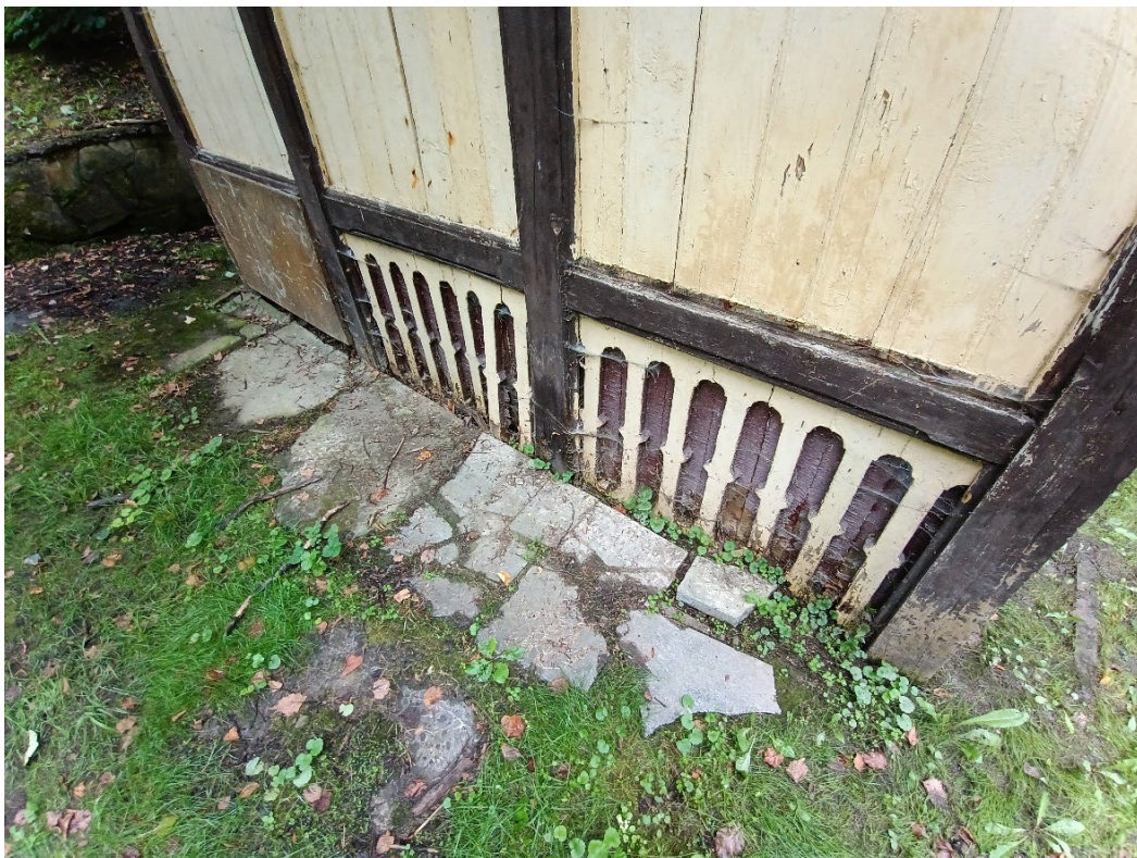
Fot 11. uszkodzenia opaski betonowej, podwalina schowana w gruncie, braki deskowania w polach ścian. fot. E. Wilbik 2023
