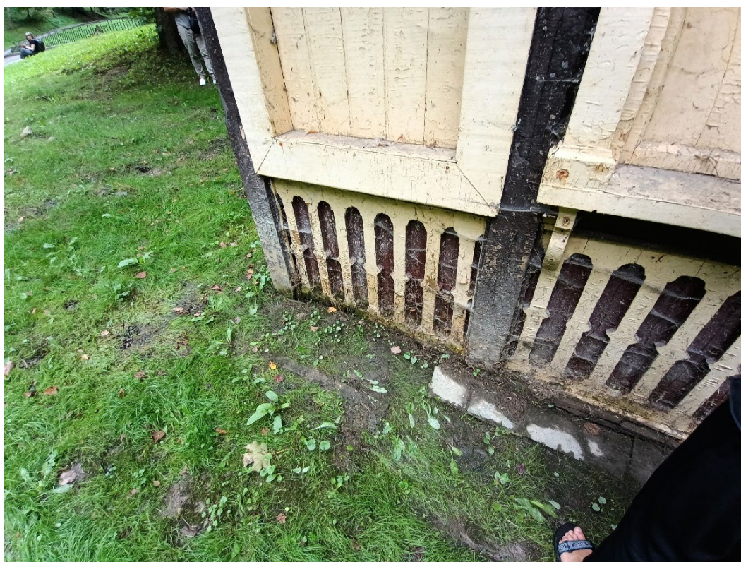
Fot 10. Podwalina zalewana woda i zapadnięta w gruncie. fot. E. Wilbik 2023
