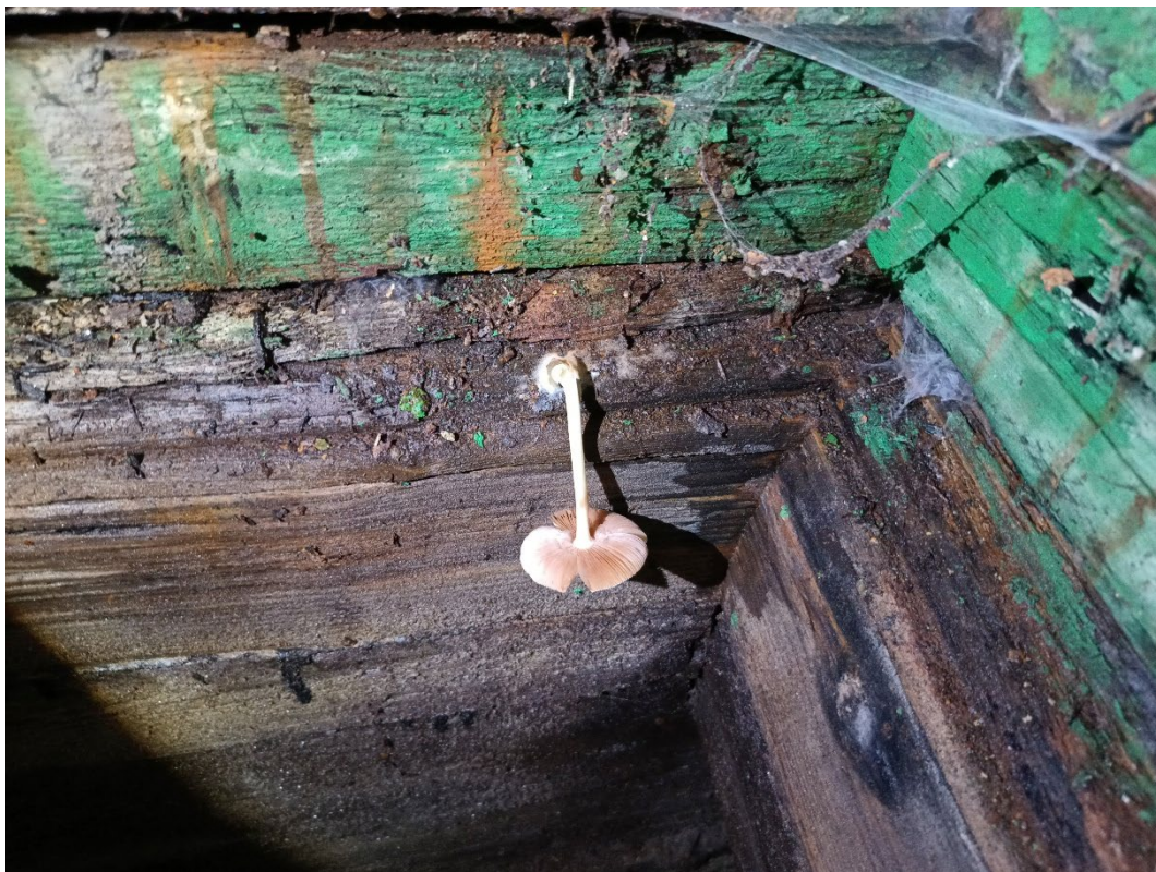
Fot 8. Jeden z gatunków grzyba domowego w drewnianej studni znajdującej się wewnątrz kiosku. fot. E. Wilbik 2023
