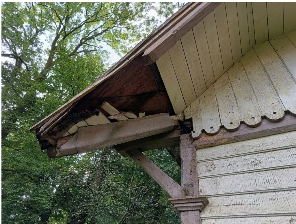
Fot 6. Ubytki więźby dachowej, rysiów i elementów elewacji. fot. E. Wilbik 2023
