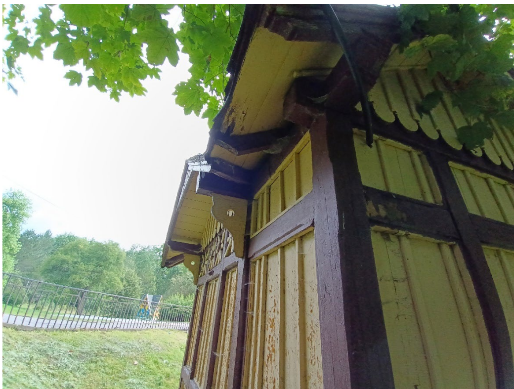
Fot 15. Ubytki więźby dachowej spowodowane korozją biologiczną. fot. E. Wilbik 2023
