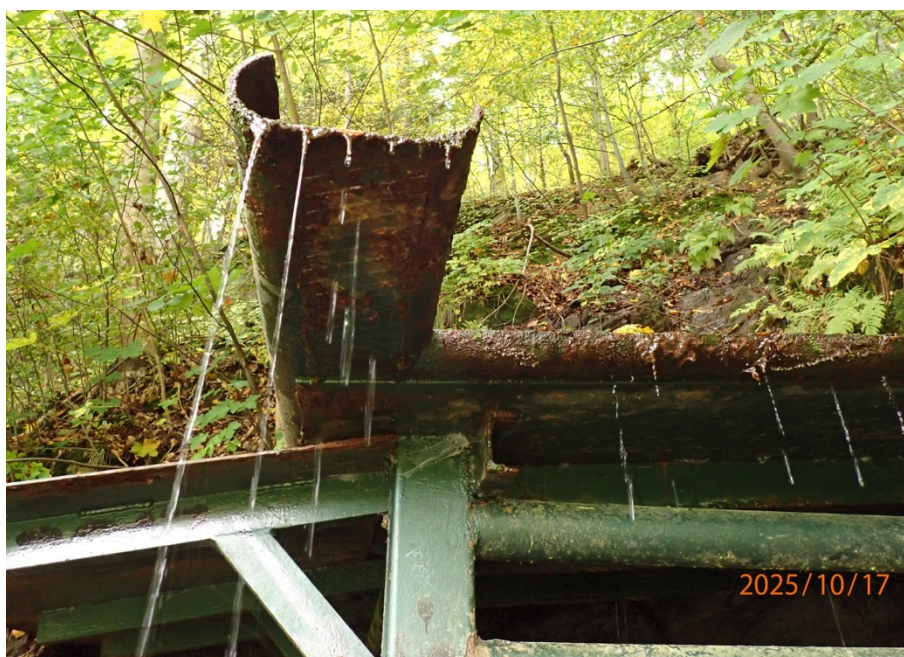
Fot. 3 Wygląd powłoki malarskiej konstrukcji daszku kraty przy Domku Myśliwskim
