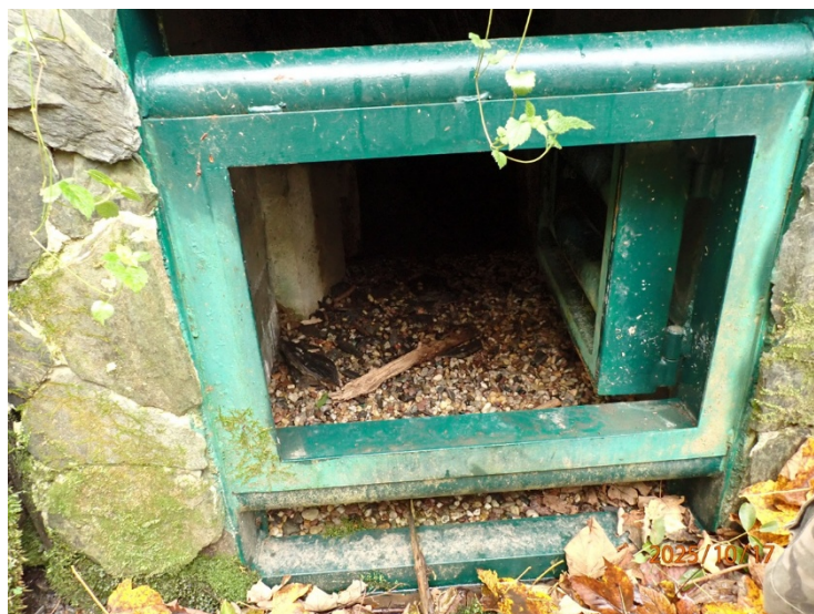
Fot. 8 Wygląd powłoki malarskiej kraty nad Byстрыm Potokiem.
