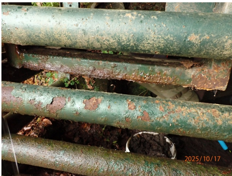
Fot. 2 Stan powłoki malarskiej kraty przy Domku Myśliwskim
