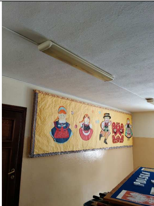
Fot 1. Oświetlenie wtórne w pom. 1.1 Komunikacja
