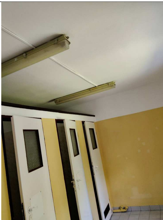
Fot 12. Oświetlenie wtórne w pom. 1.8 Toaleta
