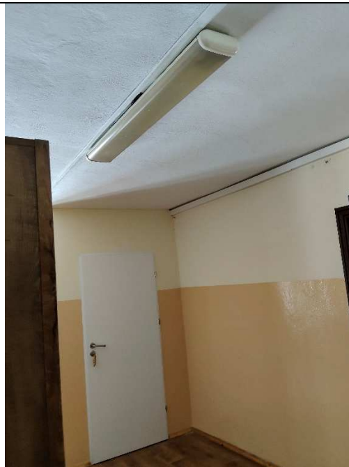
Fot 2. Oświetlenie wtórne w pom. 1.1 Komunikacja
