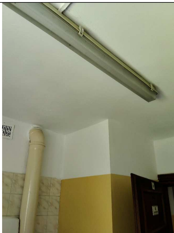
Fot13. Oświetlenie wtórne w pom. 1.9 Umywalnia
