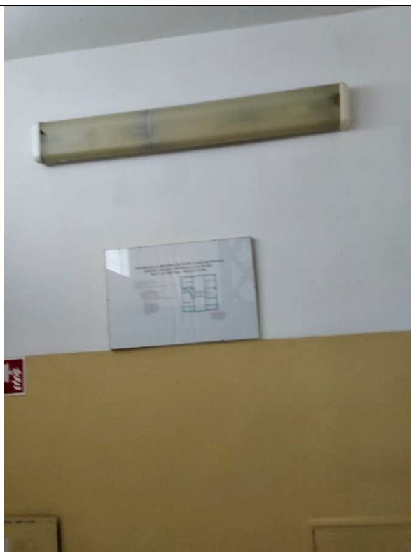
Fot16. Oświetlenie wtórne w pom. 2.1 Komunikacja ( przy klatce schodowej)
