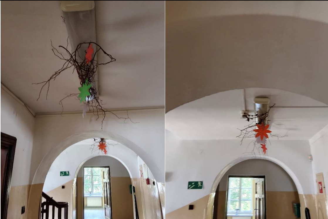
Fot 7. Oświetlenie wtórne w pom. 1.1 Komunikacja ( przy klatce schodowej)
