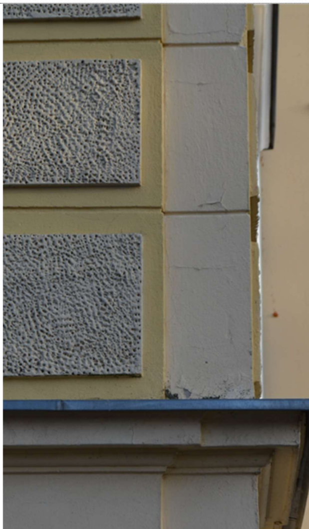
Fot. 39. Elewacja południowo-zachodnia. Widoczne spękania powłoki malarskiej.
