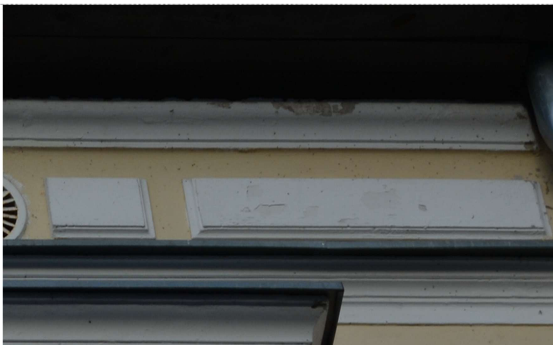
Fot. 43. Elewacja południowo-wschodnia. Widoczne odspojenie powłoki malarskiej.
