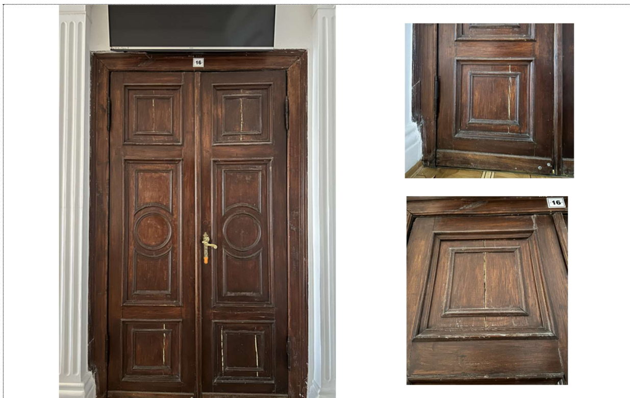
Fot. 79. Drzwi drewniane wewnętrzne, dwuskrzydłowe, połaciowo – ramowe dekoracyjne z klamką dekoracyjną. Znajdują się w pom. 0.7 (do pom. 0.10) na poziomie wysoki parter. Widoczne liczne zarysowania połaci drzwi, pęknięcia spowodowane użytkowaniem, naprawy, prowizoryczne naprawy. Poddane pracom konserwatorskim- renowacji.
