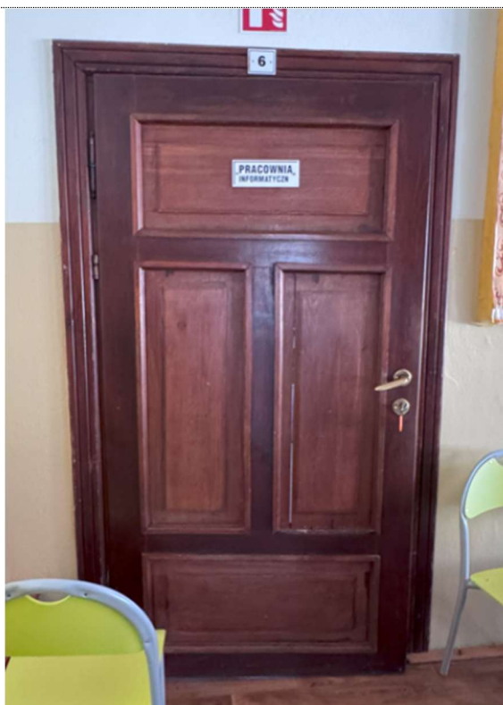
Fot. 113. Poziom „+1” zabytkowej części DR15 – drzwi drewniane renowacja lub rekonstrukcja. Widoczne pęknięcia i uszkodzenia.
