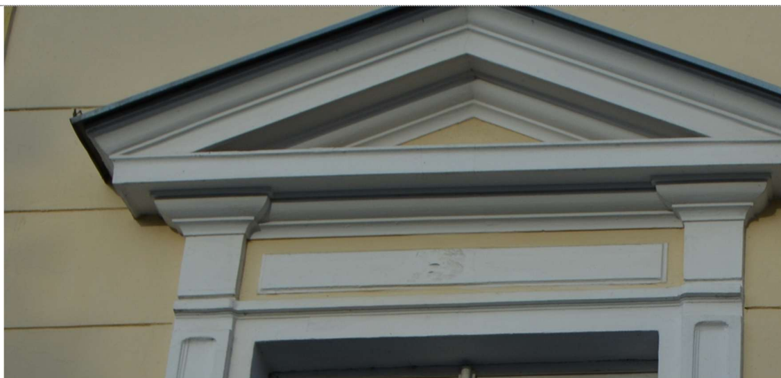
Fot. 41. Widoczne spękania, odspojenia. Elewacja południowo-wschodnia.
