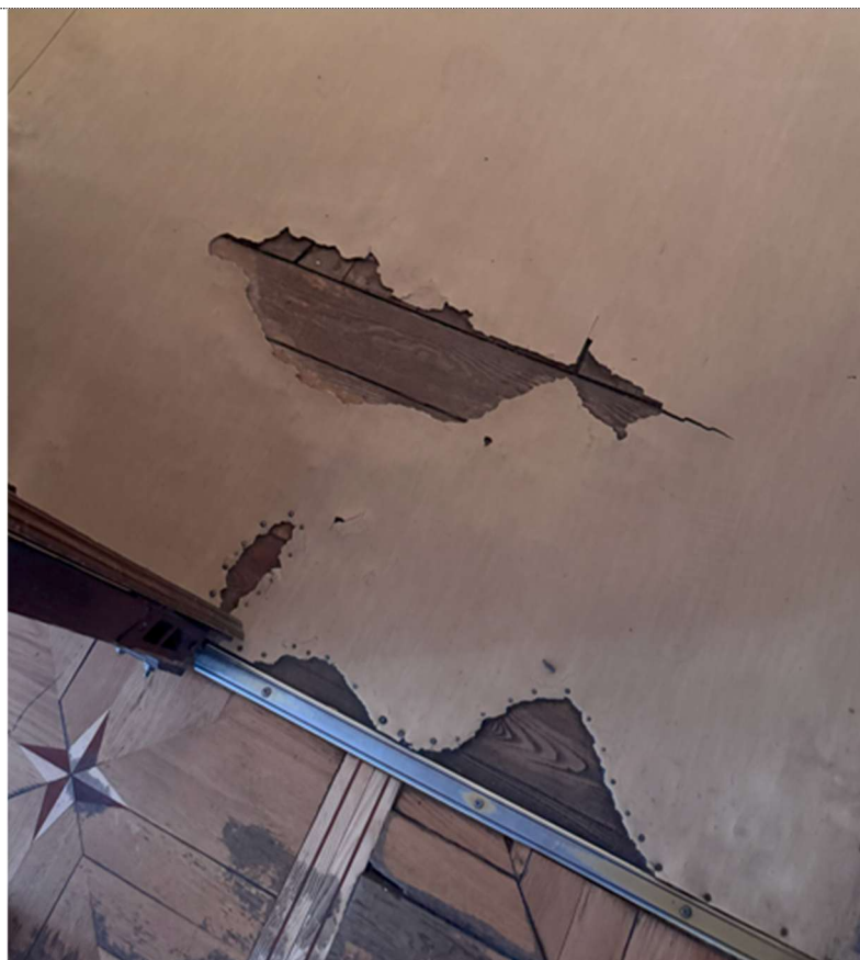
Fot. 86. Posadzka dekoracyjna drewniana – widoczny fragment z dużym uszkodzeniem, wytarciem, ubytkiem – spowodowany użytkowaniem. Wykładzina PCV na posadzce drewnianej zwykłej. Uszkodzenie spowodowane użytkowaniem, prowizoryczna napawa.
