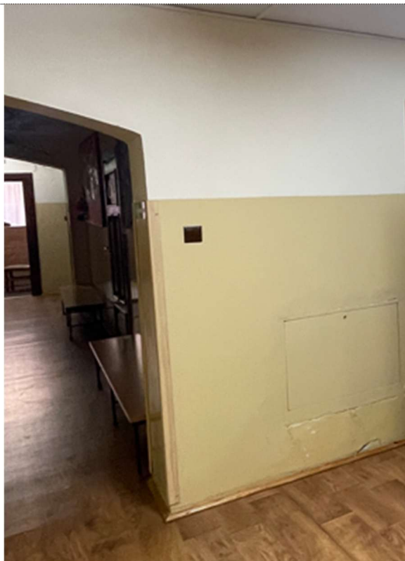
Fot. 118. Poziom „+1” starej części szkoły – widok na uszkodzenie spowodowane użytkowaniem.
