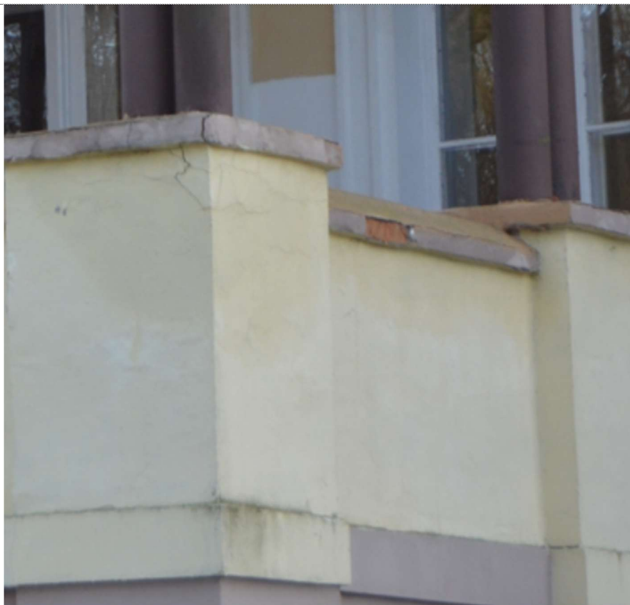
Fot. 24. Elewacja północno zachodnia – weranda – widoczne spękanie tynku, odprysnięcie
