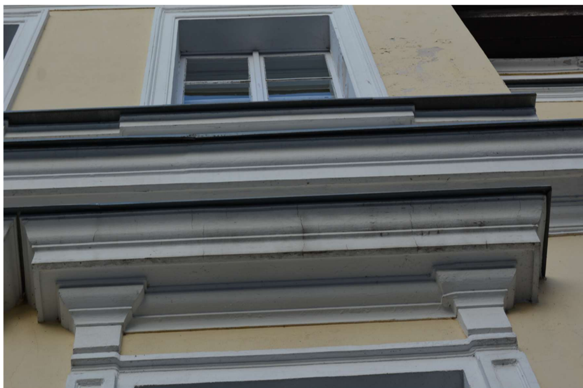
Fot. 48. Widoczne odprysnięcia powłoki malarskiej. We wnętrzu okiennej, na powierzchni ścian i na detalach architektonicznych.
