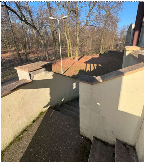
Fot. 13. Widok z werandy ogrodowej zabytkowej części. Widoczne spękania, naprawy prowizoryczne.
