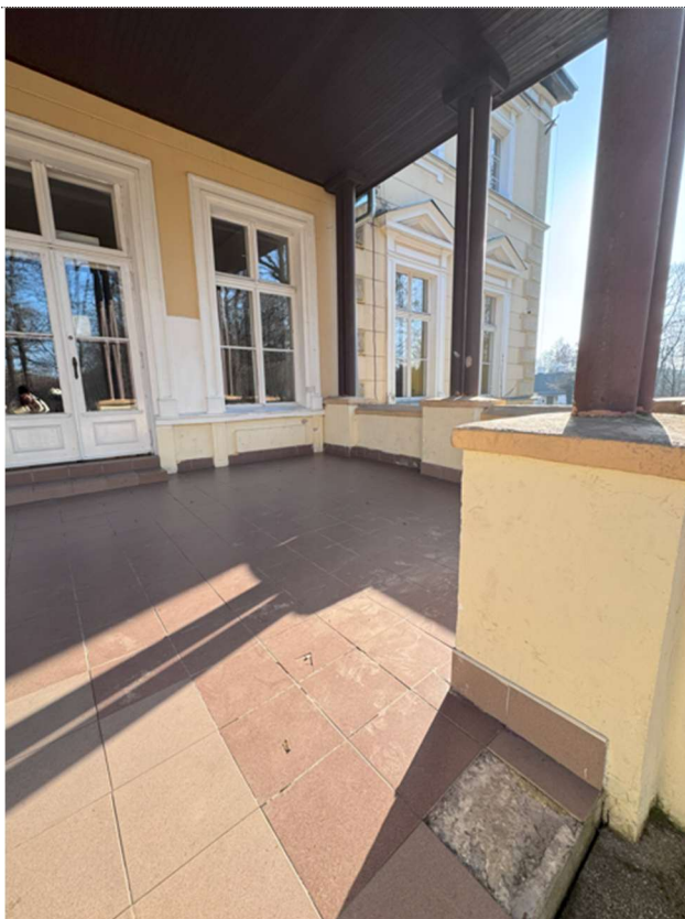
Fot. 12. Widok na werandę ogrodową zabytkowej części obiektu. Widoczne ubytki i uszkodzenia wykończenia nawierzchni. Zabrudzenia, odspojenia powłoki malarskiej na elewacji oraz metalowych słupach werandy.
