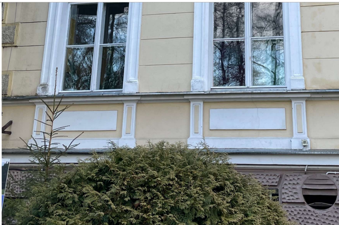
Fot. 32. Elewacja północno zachodnia – widoczne spękanie tynku.
