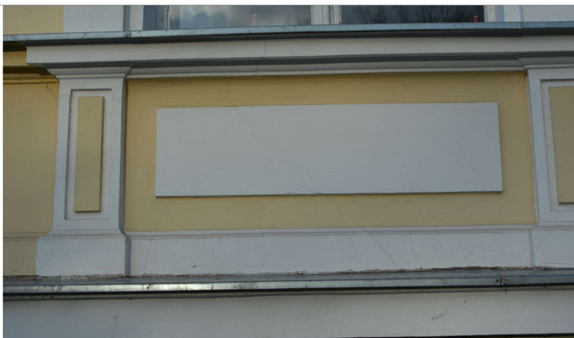
Fot. 40. Widoczne spękania, zwłaszcza przy obróbkach blacharskich. Elewacja południowo-
