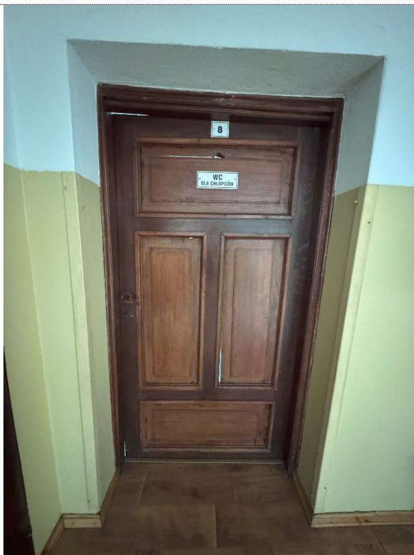
Fot. 109. Poziom „+1” zabytkowej części DR9 – drzwi drewniane renowacja lub rekonstrukcja. Widoczne pęknięcia i uszkodzenia.
