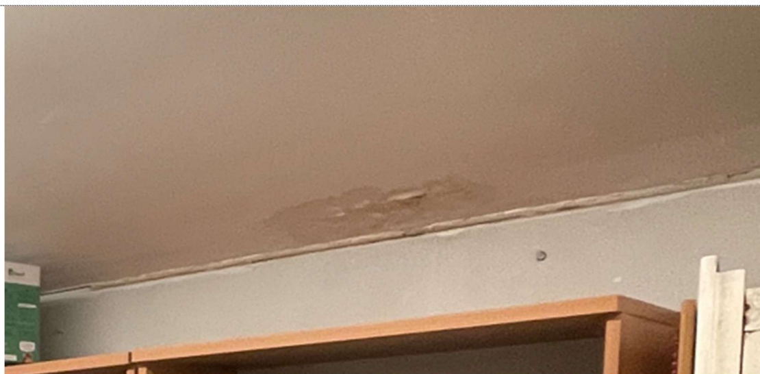
Fot. 119. Poziom „+2” odpryśnięcie powłoki malarskiej, widoczne zawilgocenie.
