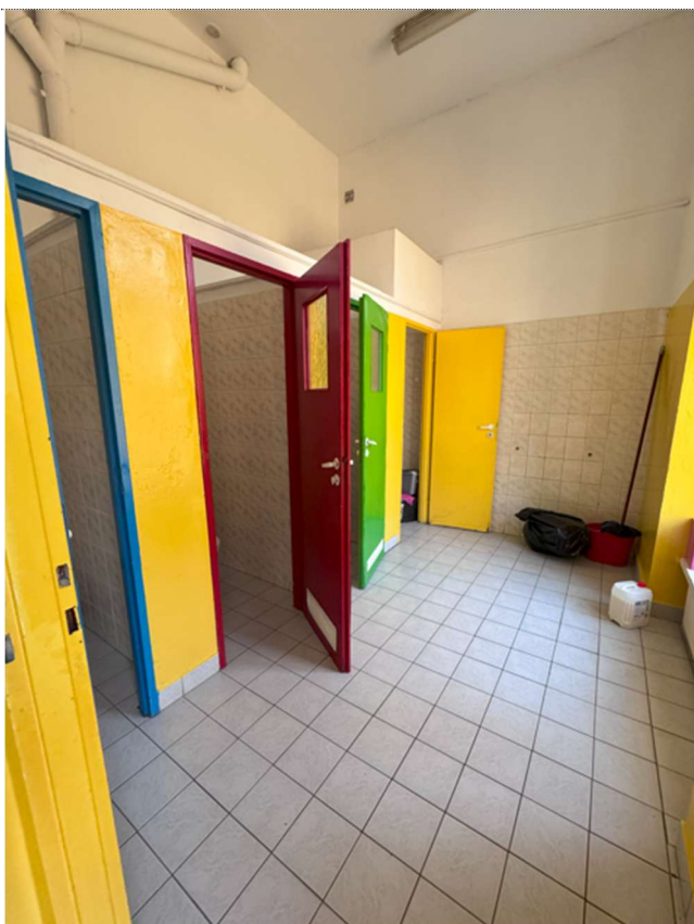
Fot. 74. Poziom wysokiego parteru – toaleta – widok na kabiny. Brak drzwi pomiędzy toaletą a przedsionkiem.
