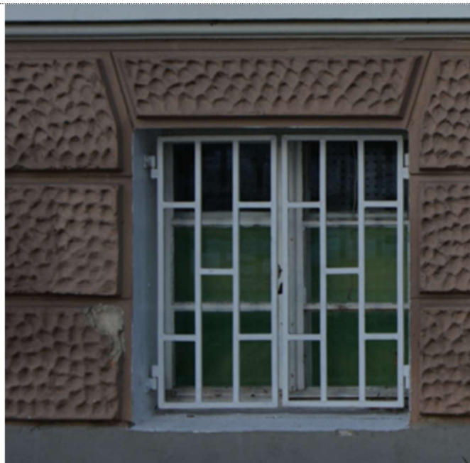
Fot. 46. Elewacja południowo-wschodnia. Stolarka okienna liczne odspojenia, spękania powierzchni drewnianej. Boniowanie cokołu uszkodzenie.
