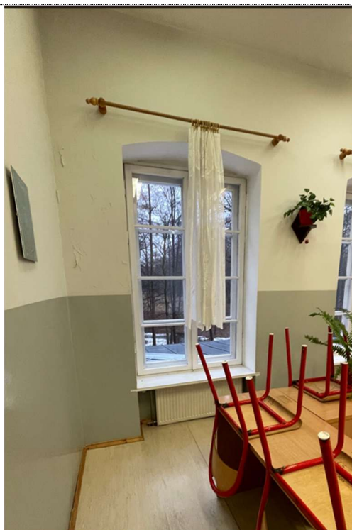
Fot. 115. Pom. oznaczone. Widoczne odpysknięcia powłoki malarskiej.
