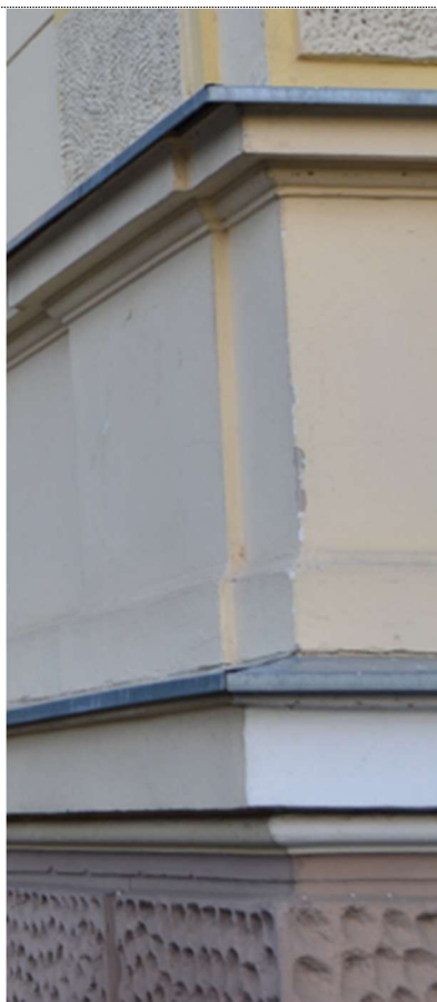
Fot. 51. Widoczne odprysnięcie powłoki malarskiej.
