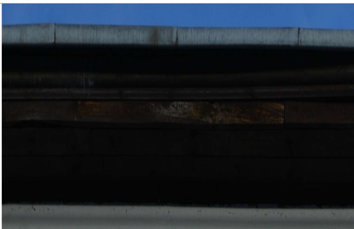
Fot. 44. Elewacja południowo-wschodnia. Gzyms kordonowy – widoczna korozja biologiczna.
