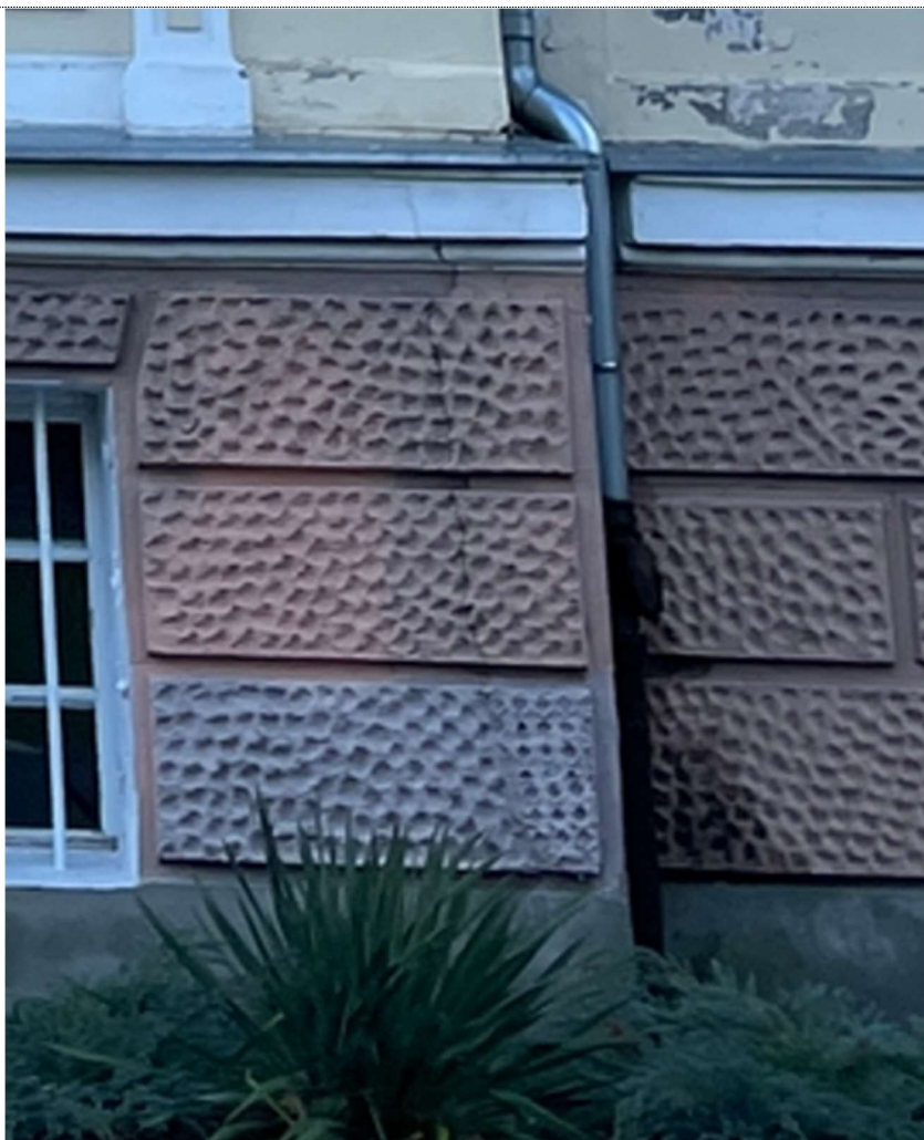
Fot. 49. Elewacja południowo-wschodnia. Widoczna rysa/ spękanie na boniowaniu.
