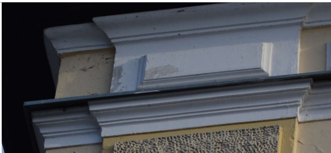
Fot. 37. Elewacja południowo - zachodnia – widoczne odspojenia powłoki malarskiej.
