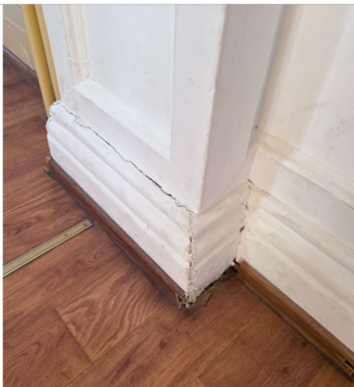
Fot. 76. Detal architektoniczny – widoczne uszkodzenie/ pęknięcie. Ubytek listwy przypodłogowej.
