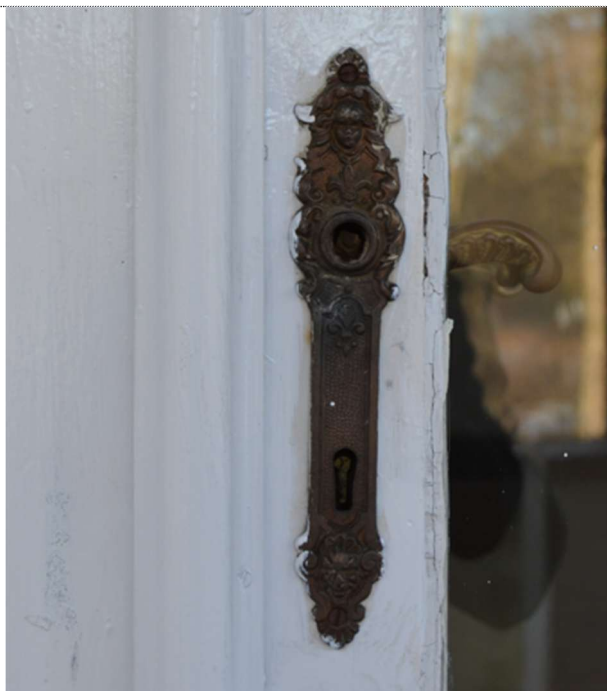
Fot. 19. Stolarka drzwiowa zabytkowej części prowadzona na werandę. Klamka zdobiona, dekoracyjna – ubytek pochwyty.
