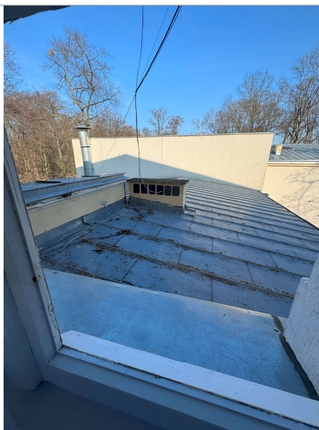
Fot. 116. Widok z poziomu „+1” starej części szkoły na dach łącznika pozostałej części szkoły. Widoczne pęknięcia, odpsojenia tynków.
