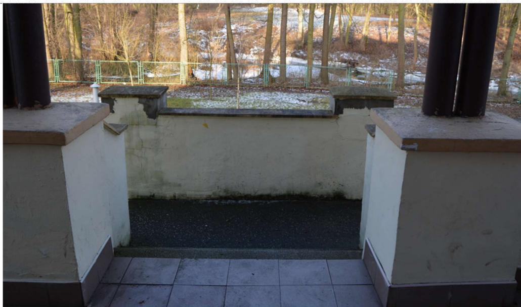
Fot. 14. Widok z werandy. Widoczne naprawy prowizoryczne, porażenia biologiczne, odspojenia tynku.
