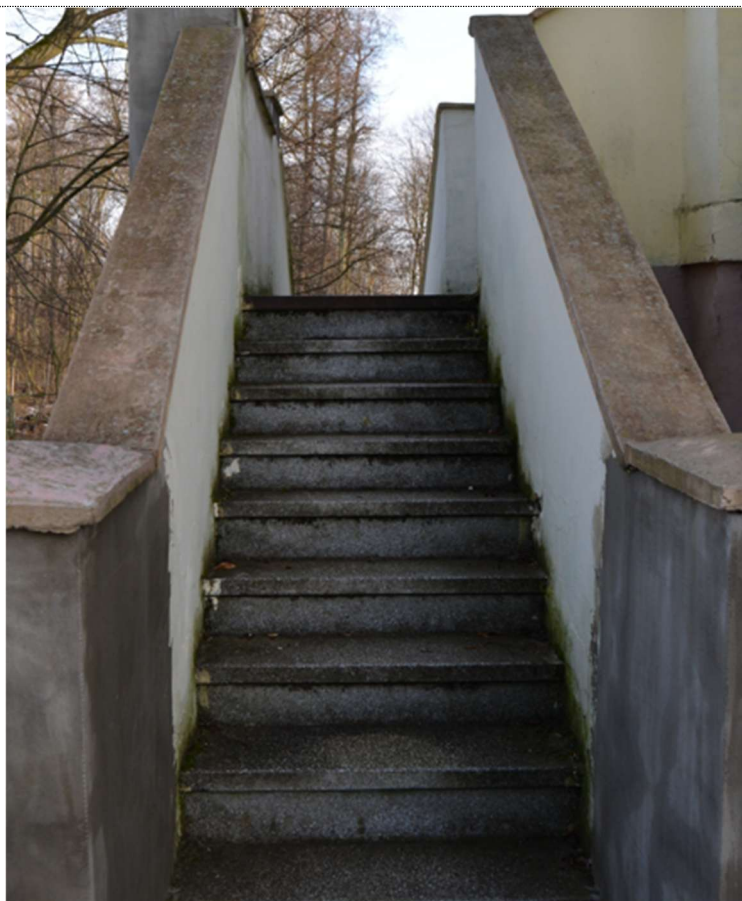
Fot. 25. Elewacja północno zachodnia – weranda – widoczne prowizoryczna naprawa, zielony nalot (korozja biologiczna), spękanie i ubytek tynku.
