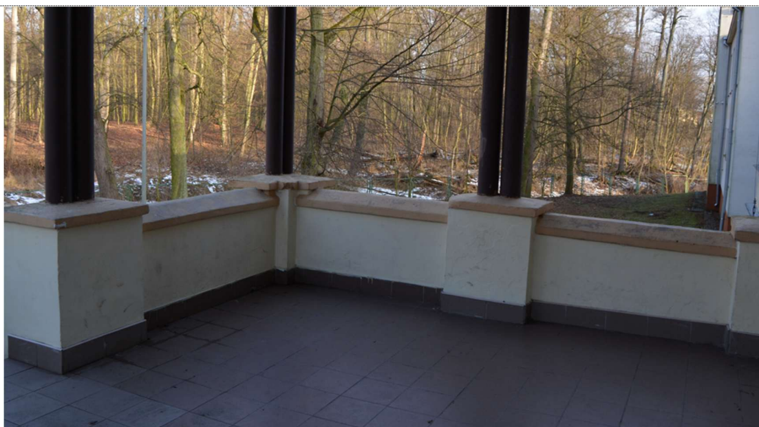
Fot. 15. Widok z werandy. Widoczne uszkodzenia, spękania tynku, porażenia biologiczne, odspojenia tynku.
