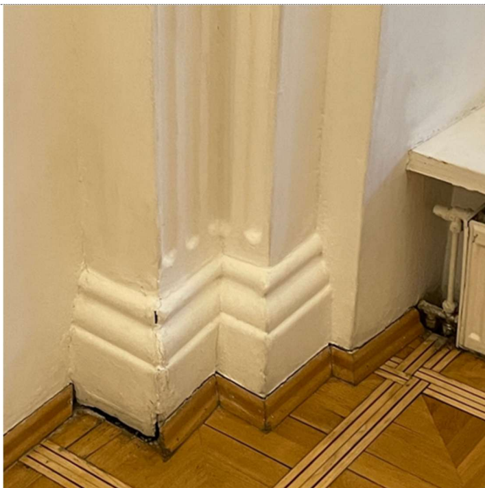
Fot. 85. Pilastry wewnętrzne widoczne ubytki (pom. oznaczone w załączniku graficznym 0.7; poziom wysokiego parteru).
