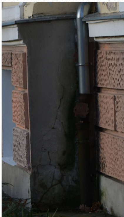
Fot. 22. Elewacja południowo wschodnia – części zabytkowej – ryzalit – widoczne porażenie biologiczne i spękanie tynku.
