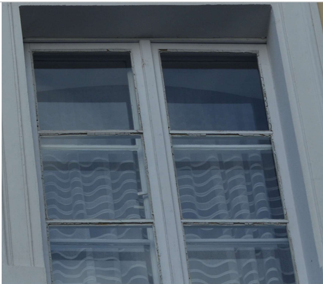
Fot. 45. Elewacja południowo-wschodnia. Stolarka okienna liczne odspojenia, spękania powierzchni drewnianej.
