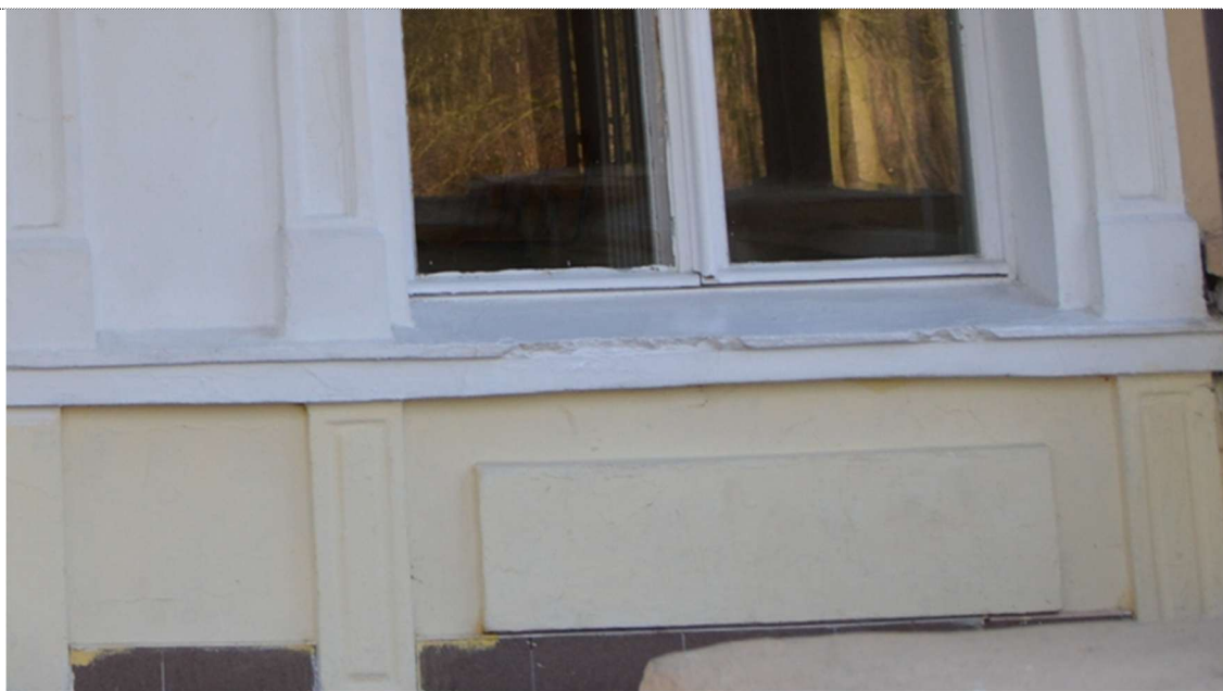
Fot. 26. Elewacja północno zachodnia – weranda – ubytek gzymsu podokiennego.
