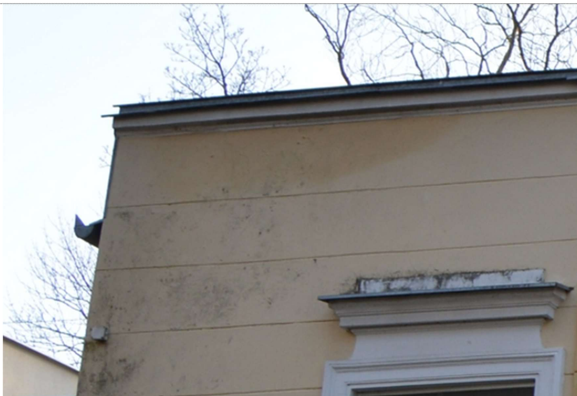
Fot. 34. Elewacja północno zachodnia – widoczne zawilgocenie ściany.
