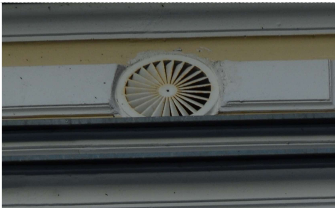
Fot. 42. Widoczne uszkodzenie. Elewacja południowo-wschodnia.
