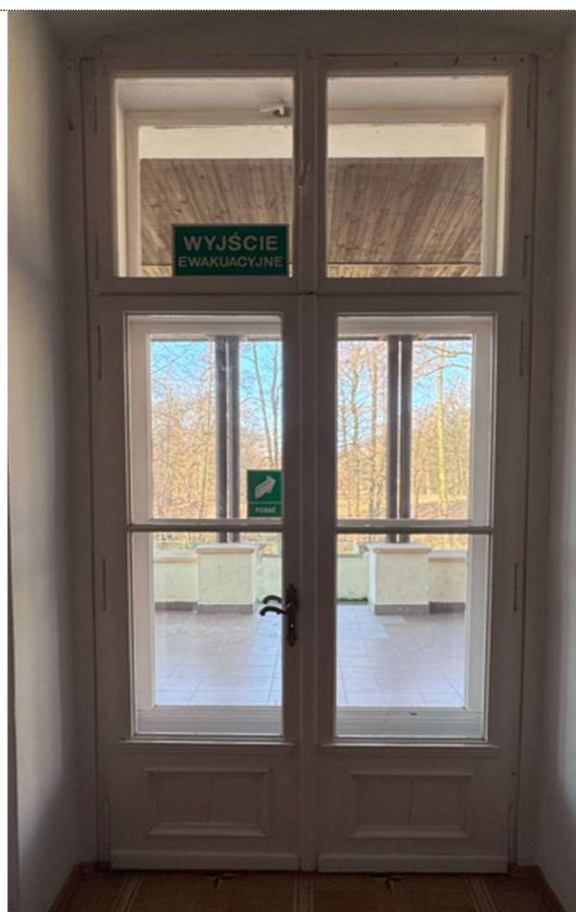
Fot. 78. Widok na drzwi prowadzące na werandę (pom. 0.7). Widoczne pęknięcia powierzchni drzwi w części dolnej.
