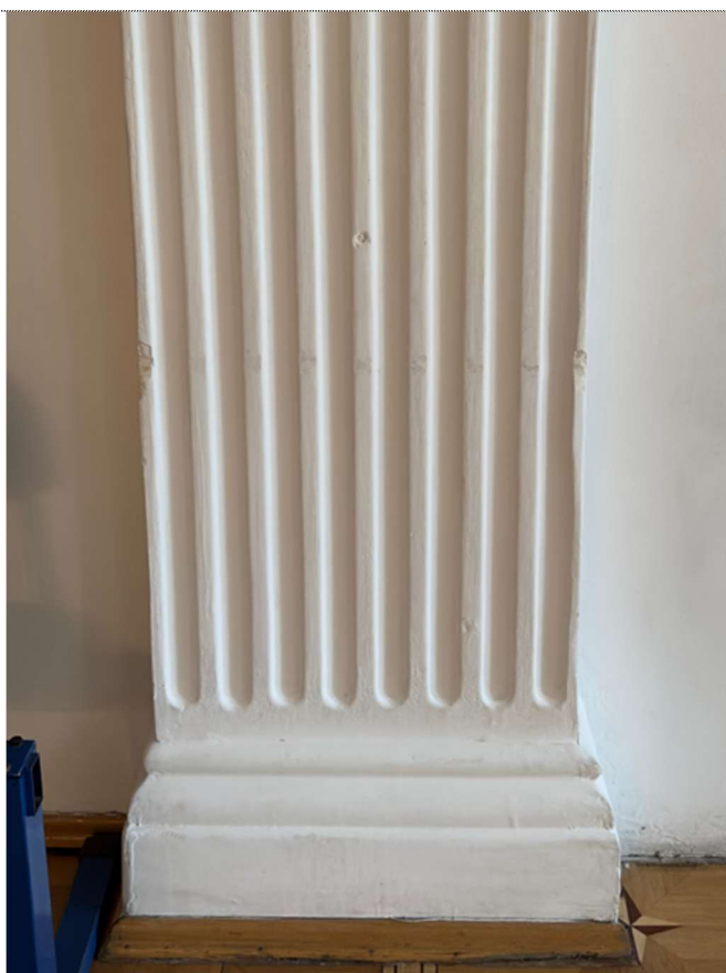
Fot. 84. Pilastry wewnętrzne widoczne ubytki (pom. oznaczone w załączniku graficznym 0.7; poziom wysokiego parteru).
