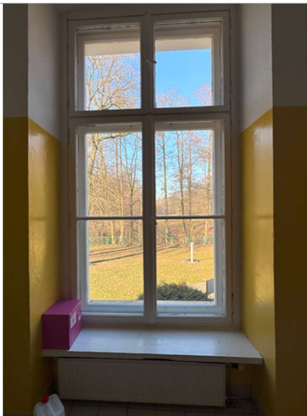
Fot. 73. Widok na okno w toalecie pom. ozn.0.5 oraz 0.6. Wysokość parapetu nie spełnia obecnych wymogów.
