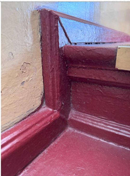
Fot. 68. Widok klatka schodowa A, poziom wysoki parter. Widoczne odprysnięcia powłoki malarskiej. Detal trepów schodowych (stopnica i podstopnica oraz cokolik).
