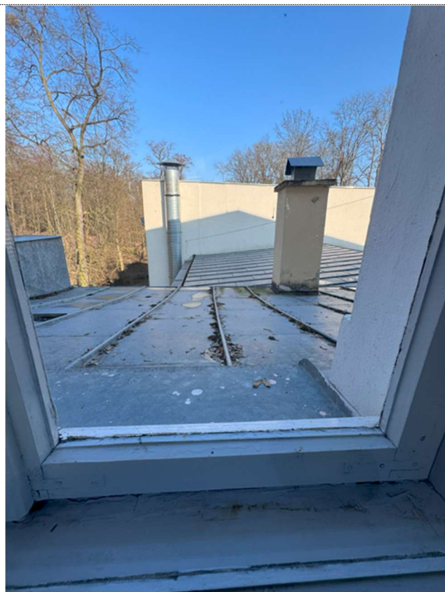
Fot. 117. Widok z poziomu „+1” starej części szkoły na dach łącznika pozostałej części szkoły. Widoczne pęknięcia, odspojenia tynków, zawilgocenia blachy. Widoczne zawilgocenia i odspojenia powłoki malarskiej stolarki okiennej.
