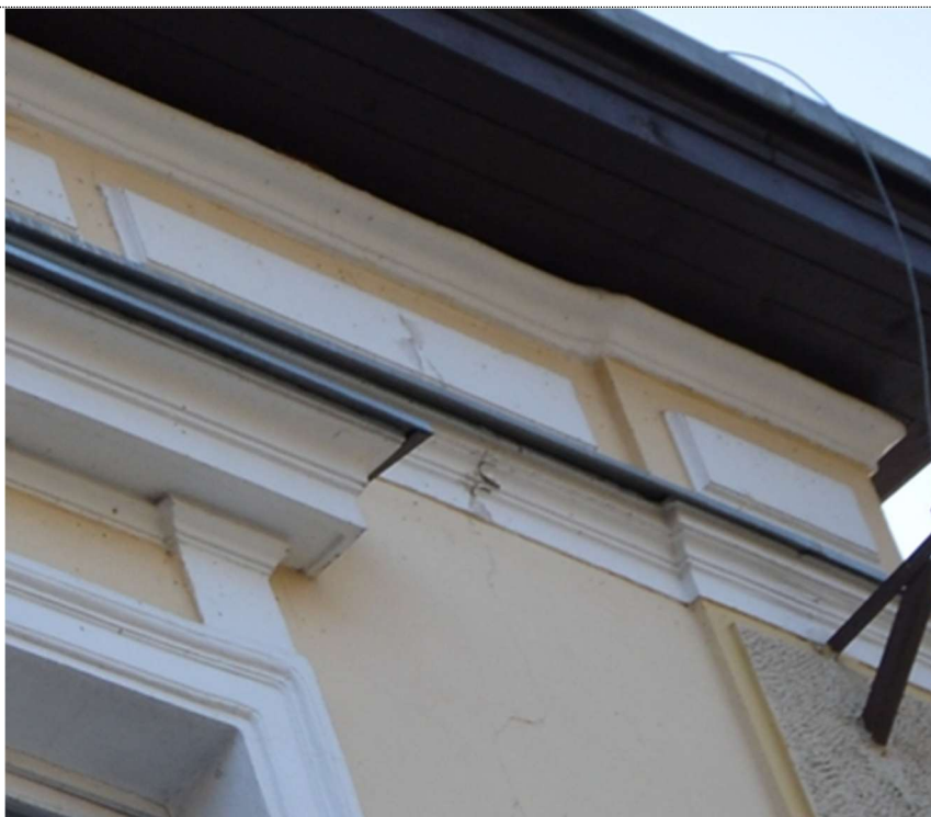
Fot. 17. Widok z werandy. Widoczne uszkodzenia, spękania tynku, porażenia biologiczne, odspojenia tynku.
