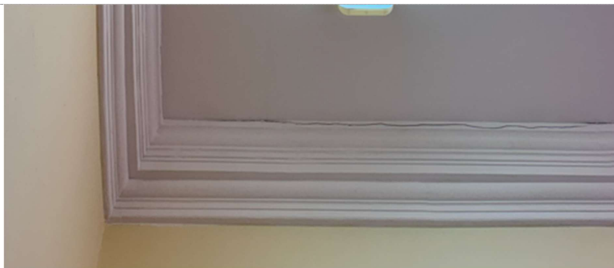
Fot. 83. Pom. 0.2. Widoczne pęknięcie sufitu przez detal podsufitowy.
