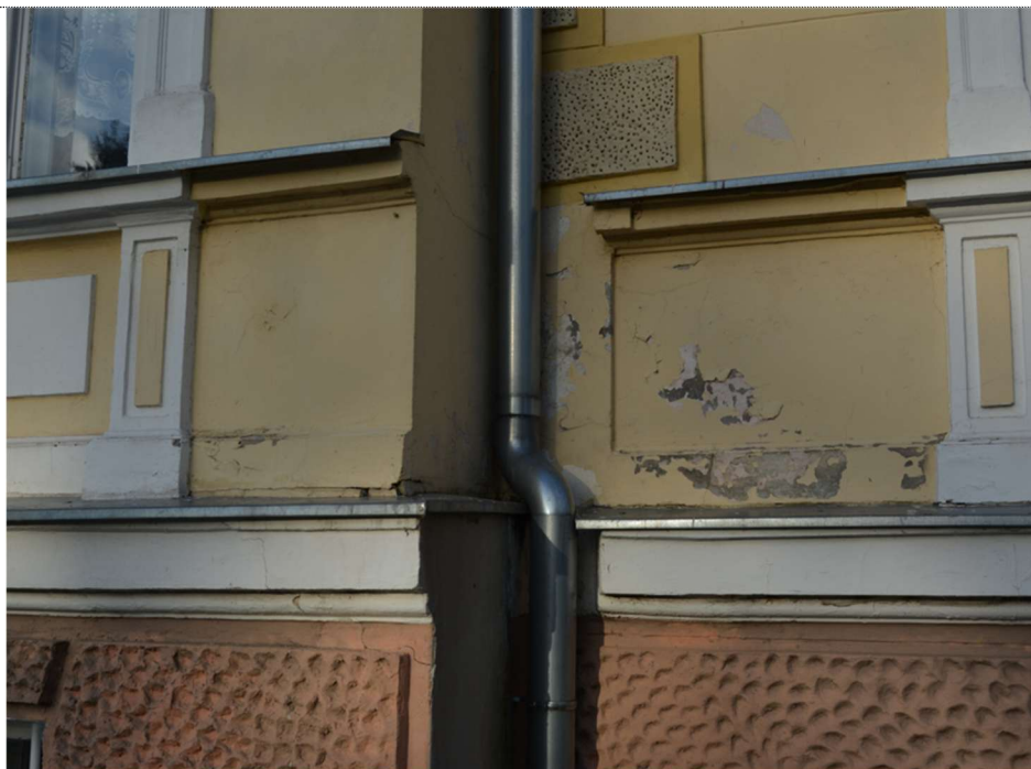
Fot. 21. Widok na elewację południowo – wschodnią części zabytkowej – widoczne odspojenia powłoki malarskiej i tynku. Widoczne uszkodzenia i ubytki. Warunki atmosferyczne spowodowały złuszczenie farby, które odsłoniło nawarstwienia malarskie i cienkie zacierki tynkarskie.
