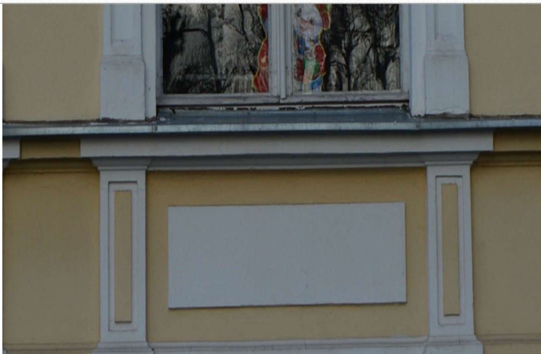
Fot. 47. Elewacja południowo-wschodnia. Stolarka okienna liczne odspojenia, spękania powierzchni drewnianej. Odprysnięcie tynku przy obróbce blacharskiej.
