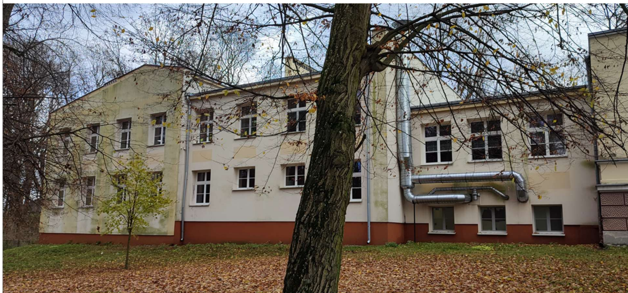
Fot. 9. Część dobudowana do zabytkowej szkoły – widok od strony północno - zachodniej. Od lewej sala gimnastyczna 1 kondygnacja, część 2 kondygnacyjna. Widoczny równy podział. Widoczny zielony nalot na elewacji.
