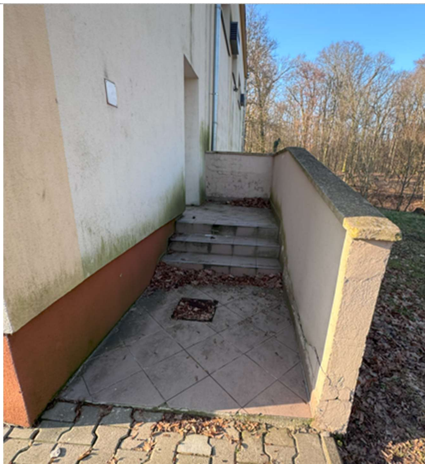
Fot. 10. Schody zewnętrzne prowadzące do Sali gimnastycznej. Widoczne porażenia biologiczne elewacji. Uszkodzenia, odspojenia barierki murowanej, porażenia biologiczne. Uszkodzenia i ubytki płytek gresowych.
