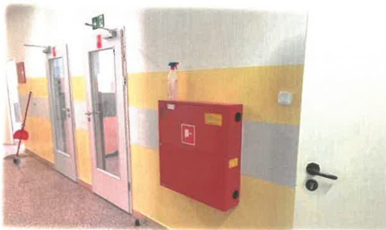
Budynek A, piętro 1 - hydrant przy wejściu do klatki schodowej K1
