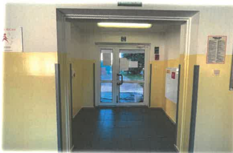
Budynek B, parter - hydrant w wiatrociąpie
