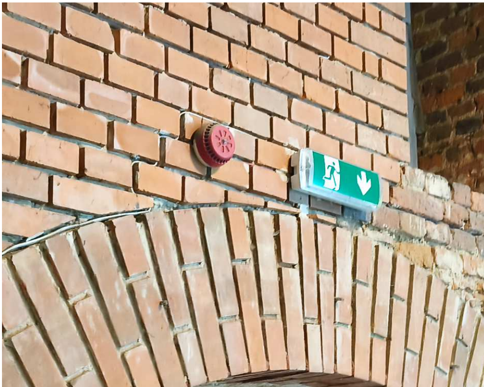
System sygnalizacji pożaru SSP i oświetlenie ewakuacyjne.
