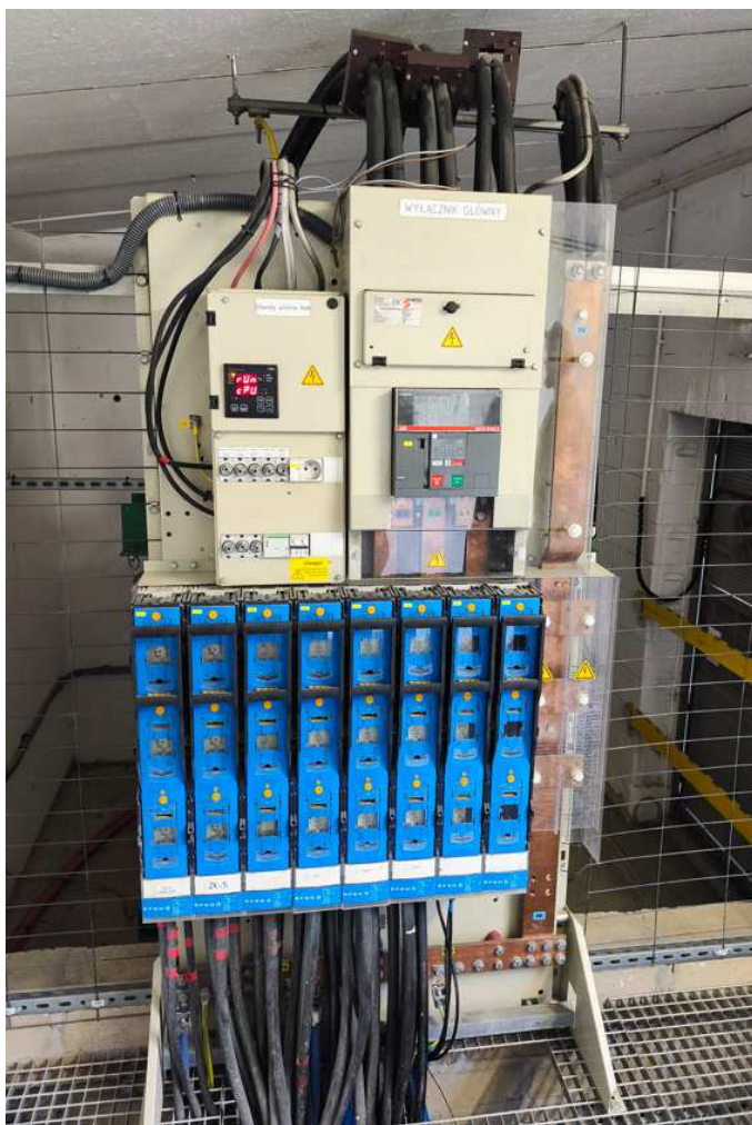
Rozdzielnia nN stacji transformatorowej.
