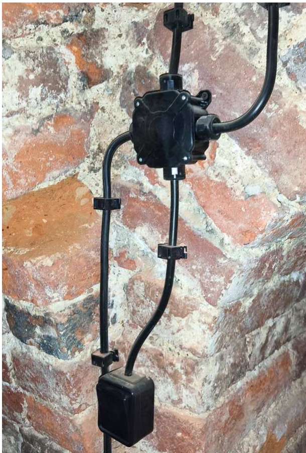
Osprzęt natynkowy, montaż przewodów, puszka łączeniowa.
