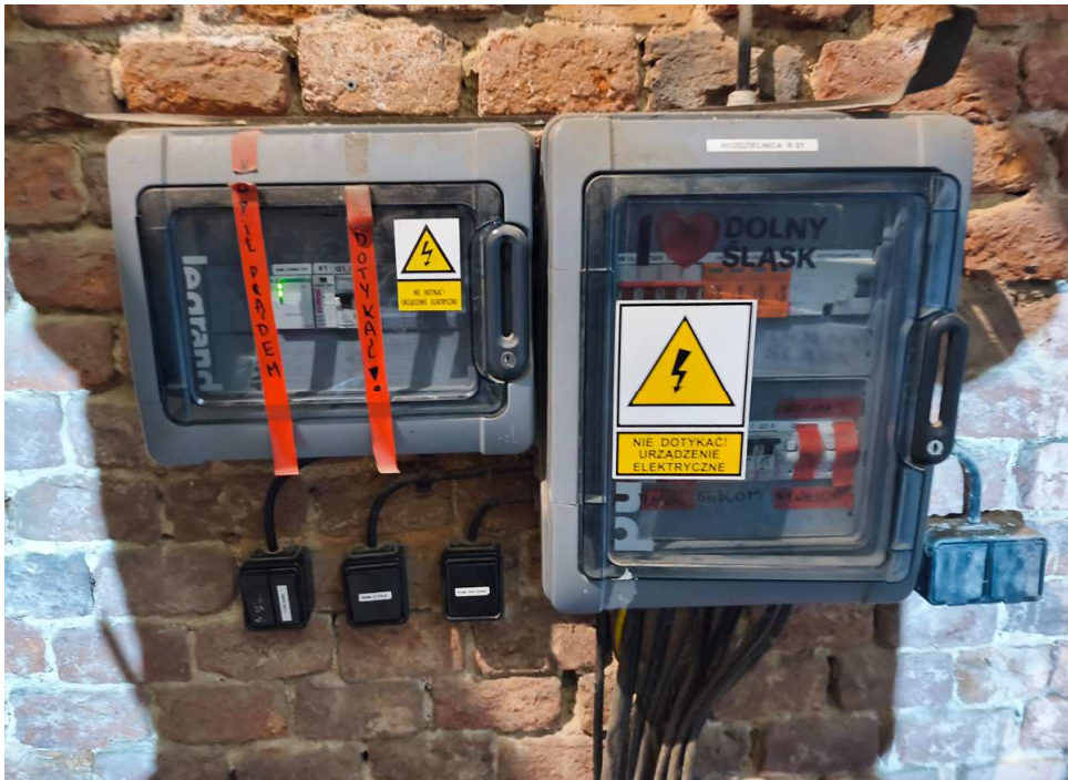
Istniejąca rozdzielnica nN.
