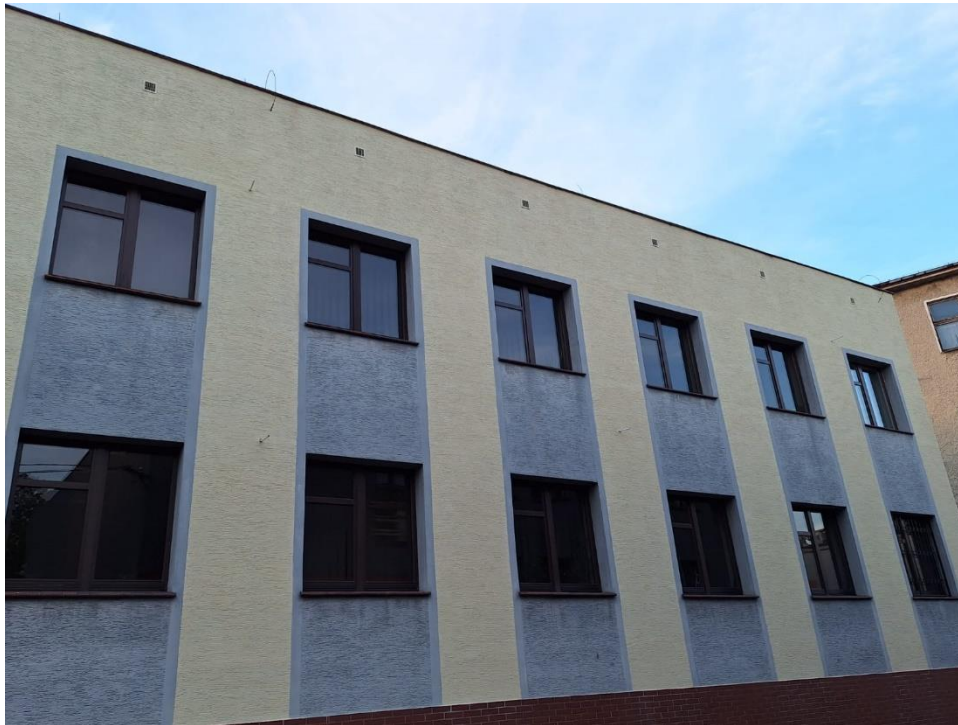
Fot. Przykładowe otwory wentylacyjne zabezpieczone kratkami.
