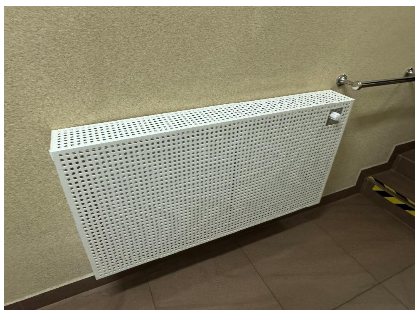
Fragmenty instalacji grzewczej
