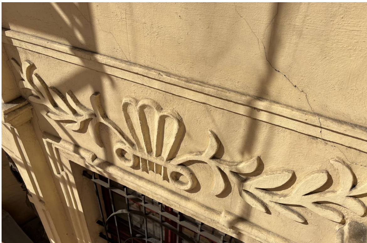
Fot. 4. Elewacja wschodnia, frontowa. Widoczne pęknięcie tynku pomiędzy kondygnacjami biegnące przez ozdobny detal.
