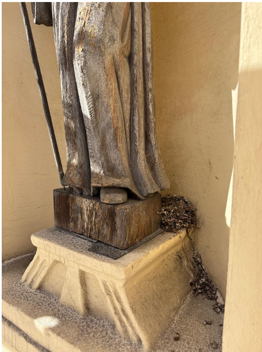
Fot. 5. Nisza z rzeźbą, widoczne gniazda ptactwa oraz szkodliwe odchody, które mogą powodować nadtrawianie struktury materiałów budowlanych.
