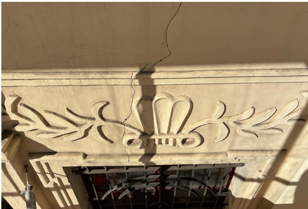
Fot. 3. Elewacja wschodnia, frontowa. Widoczne pęknięcie tynku pomiędzy kondygnacjami biegnące przez ozdobny detal.
