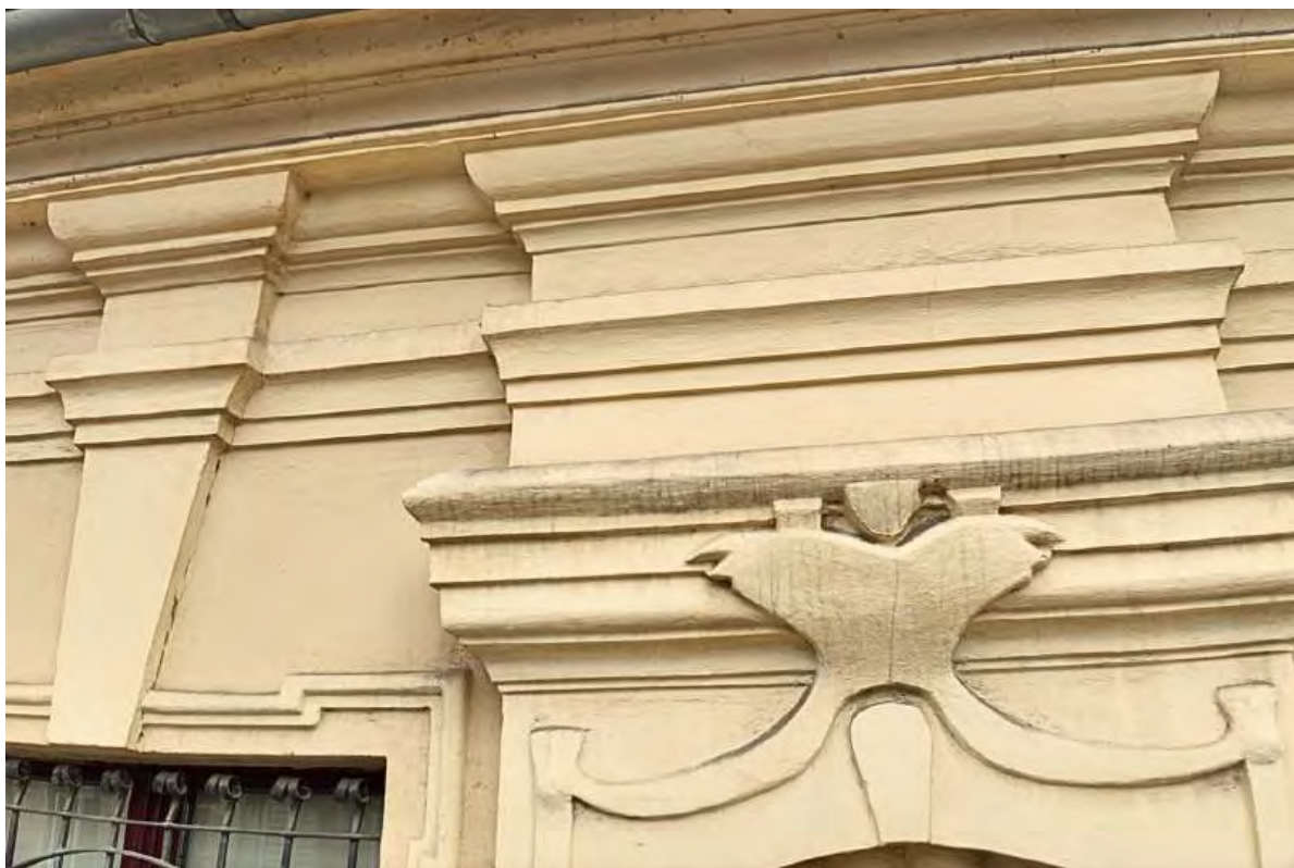
Przykłady zacieków wymagających oczyszczenia, powstałych z tytułu osadów atmosferycznych. Przy braku obróbek okapowych na kapitelach pilastrów oraz parapetach okiennych w układzie detalu architektonicznego.
