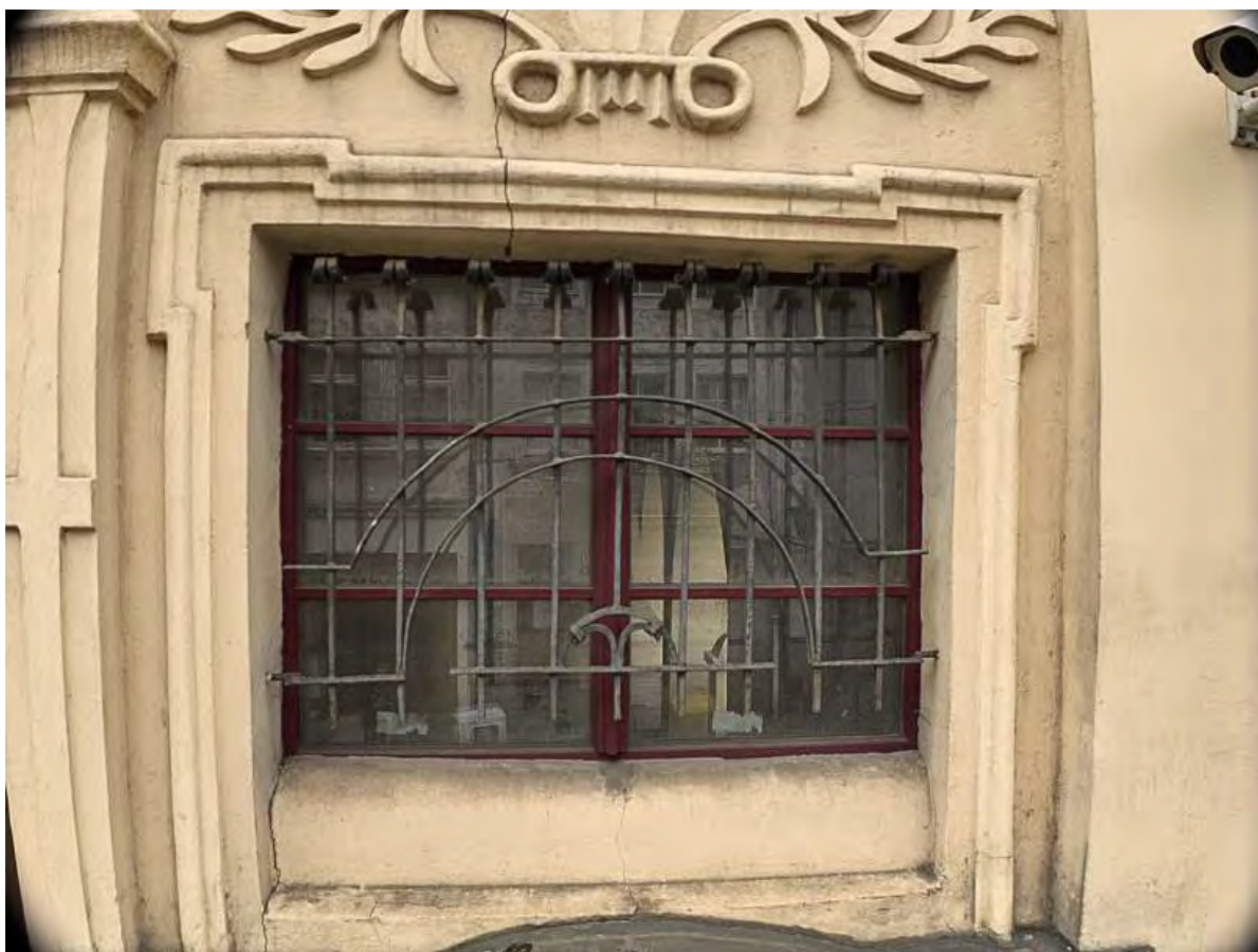
Przykłady nagromadzenia zabrudzeń do oczyszczenia i dalszej rewizji zakresu napraw. Zbliżenia zdjęć z drona.
