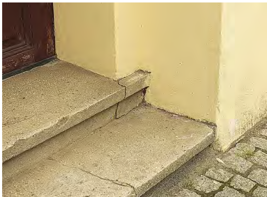
Wtórne schody z lastryko, kolejnym świadectwem odbudowy, wymagającym też naprawy iniekcyjnej rys.
