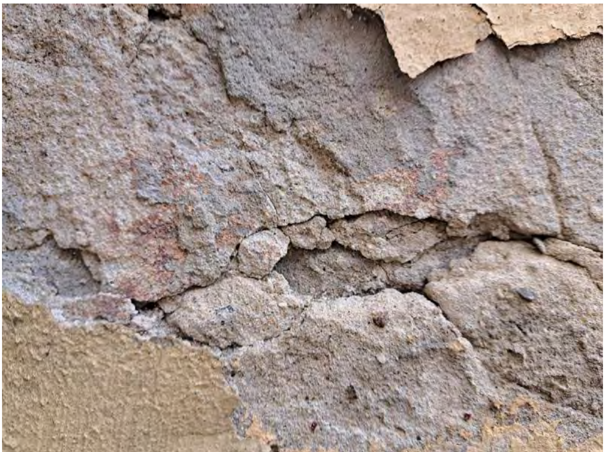
Stan lokalnej degradacji wtórnych wypraw cementowo-pochodnych w partiach cokołowych. Kwalifikującej cokoły do wymiany tynków na kompresowe, również z uwagi na znane wcześniejsze problemy kondensacyjne.
