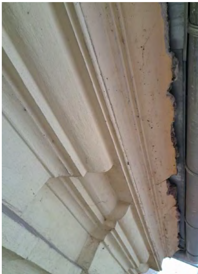
Powyżej odlupana krawędź gzymsu koronnego na elewacji frontowej, zapewne w wyniku wymiany poszycia. Kwalifikacją do napraw i uzupełnień poprzez reprofilację ubytków z narzutu oraz metodami ciągnionymi.
