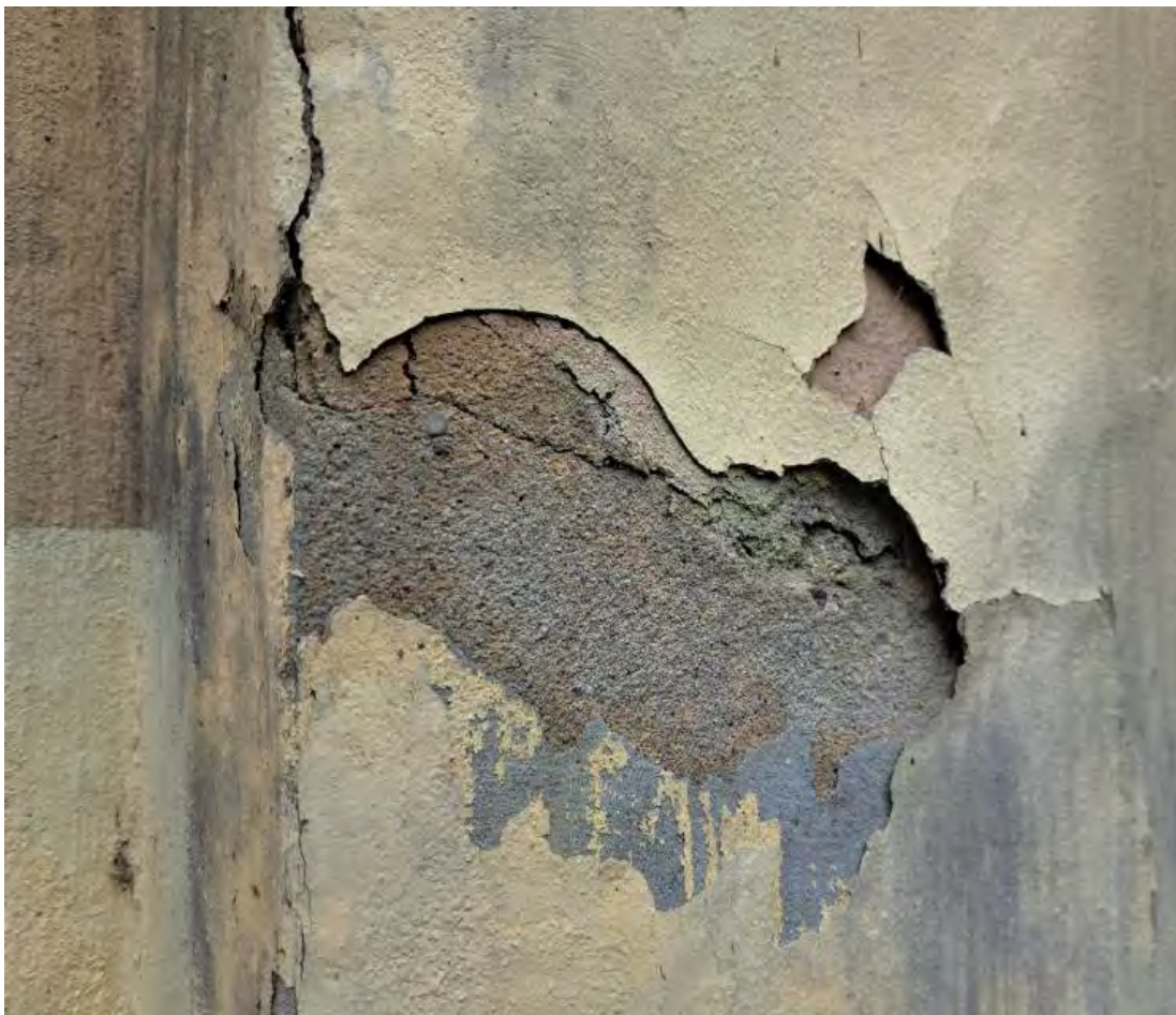
Przykłady uszkodzeń i odkrywek samoistnych, odsłaniające wtórne substancje tynków cementowych. Widoczne na narożu gzymsu wysokiego cokołu, elewacji frontowej z boczną oraz na 1 pilastrze elewacji od kościoła św. Ducha.
