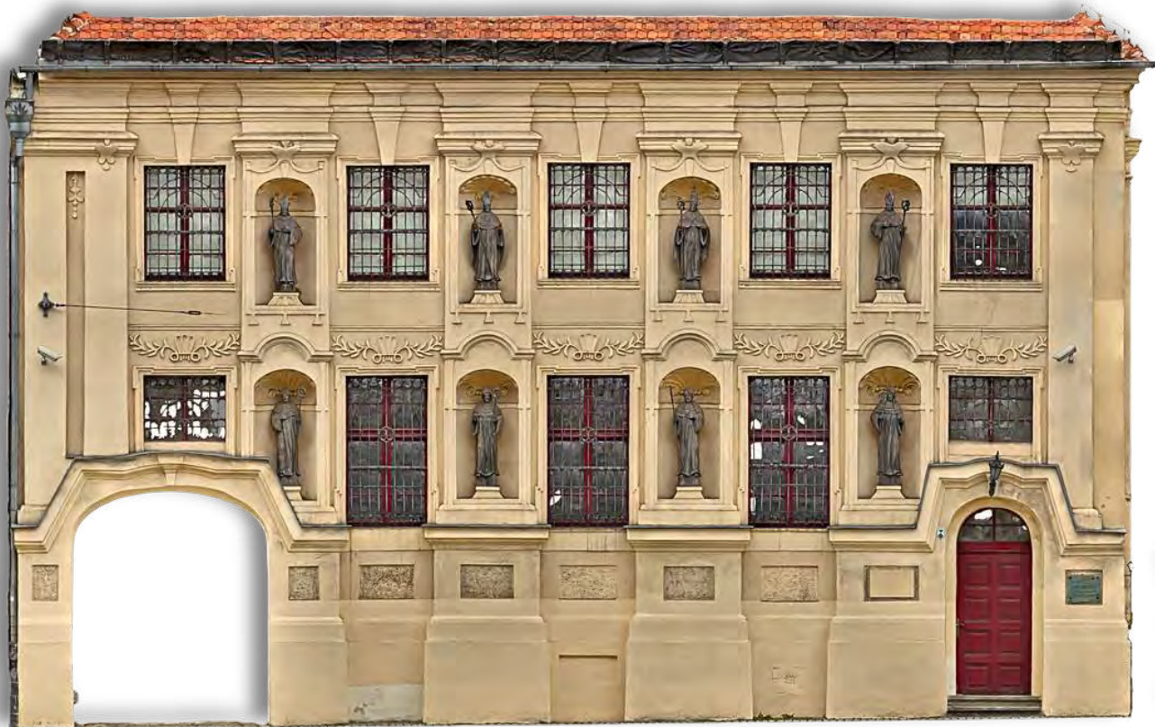
Ortofotomapa kładu elewacji, obrazuje widoczny zakres zniszczeń.
