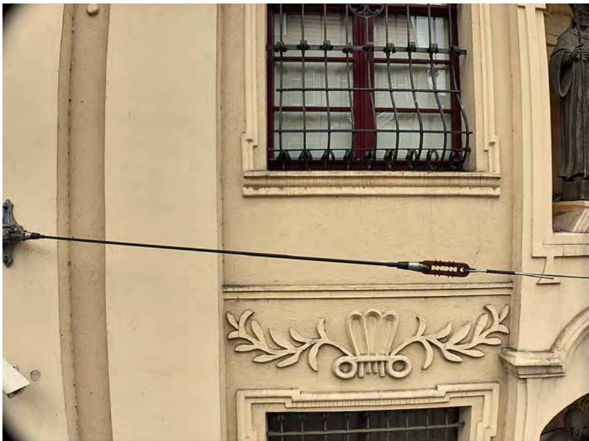
Stan osadów zabrudzeń na krawędziach detalu elewacji, na zbliżeniach zdjęć z drona. Kwalifikuje elewacje do mycia hydrodynamicznego jak i selektywnych doczyszczeń krawędzi reliefu detali, możliwie bezinwazyjnie.
