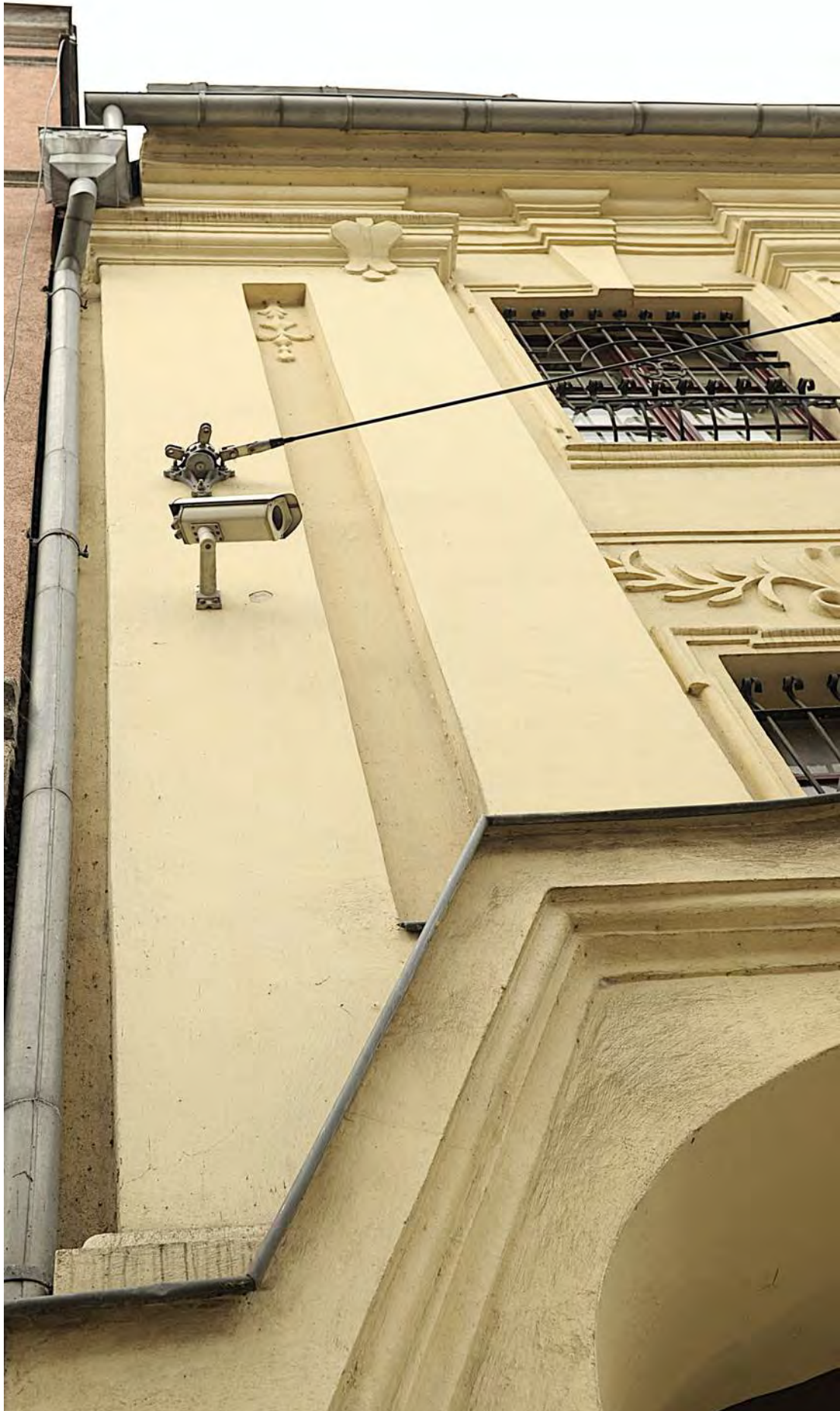
Fragment elewacji frontowej. Elementy współczesnych, niezbędnych instalacji bezpieczeństwa do zachowania. Zbliżenie na stan osadów zabudzeń w fakturze przecierek i duktu powłok renowacyjnych do umycia.
