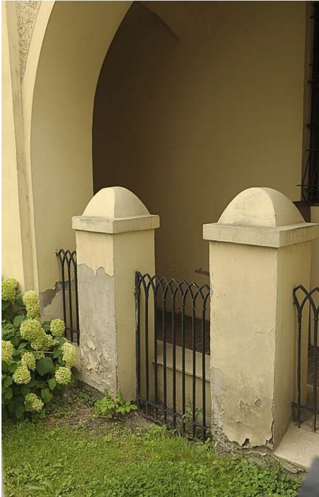
Historyczne wygrozdzenie dawnego wirydarza o przetworzonych już powojennie wyprawach i bryle pokryw słupków. Narażone jest na stałe zawilgocenie od strony gruntu. Wymaga renowacji strefy przyziemia i tynków, ale i wariantu drenażu strefy obryzgowej oraz zagospodarowania odpływów od strony działki kościoła św. Ducha.
