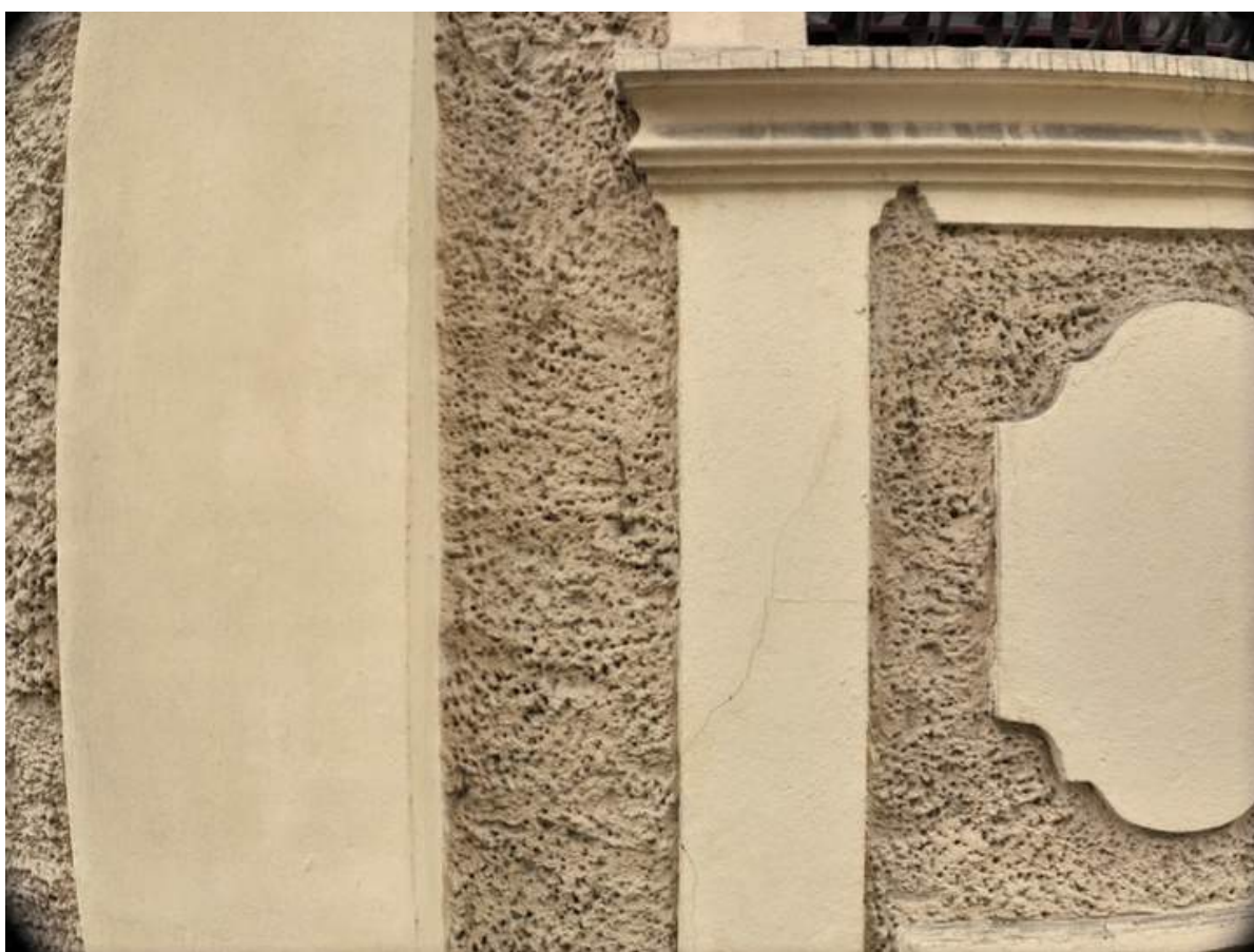
Stan zabrudzeń tynków rustykalnych i spękania wymagające weryfikacji zakresu napraw po myciu i stosownych przygotowaniach podłoża. Fragmenty elewacji bocznej w ujęciach z drona.
