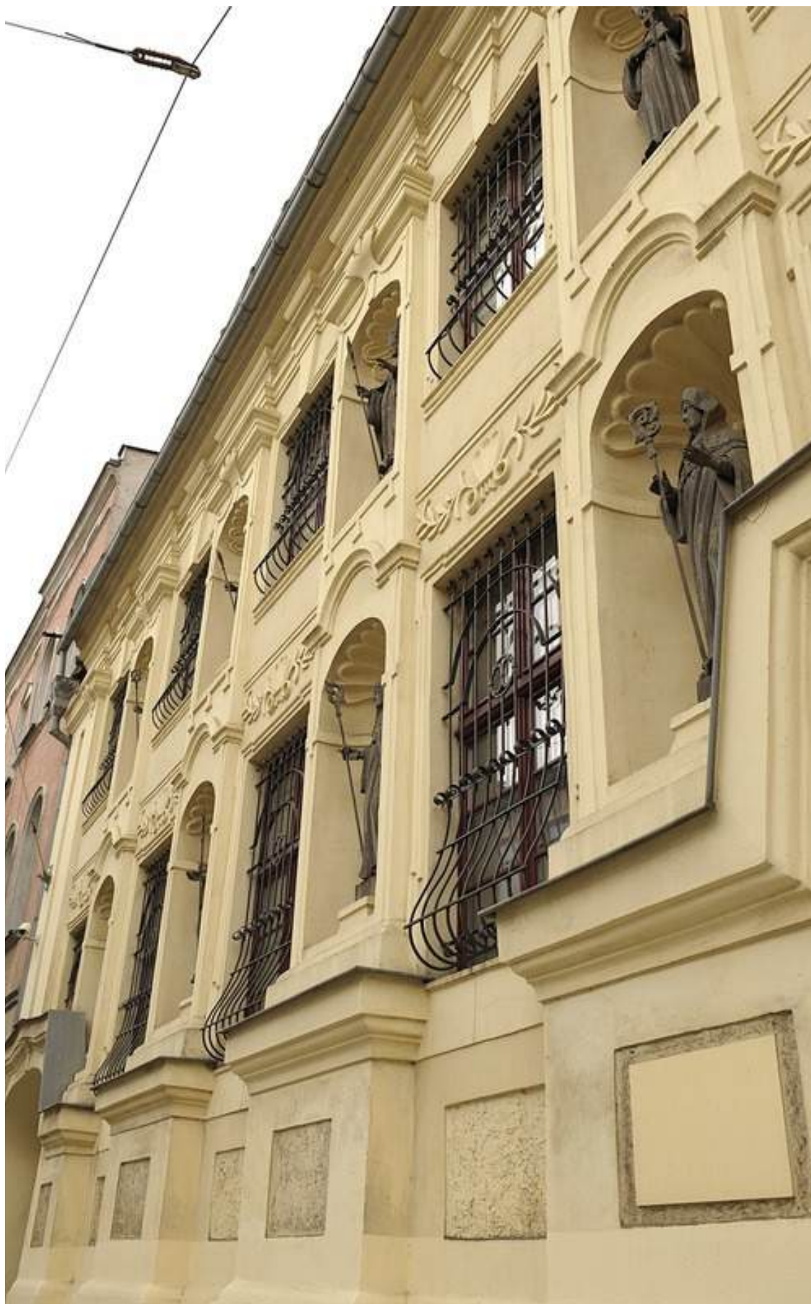
Stan eskalacji zabrudzeń powierzchni zaciekami i osadami atmosferycznymi, wymaga oczyszczenia do renowacji elewacji.
