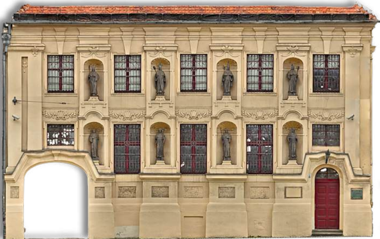
Ortofotomapa kładu elewacji, obrazuje widoczny zakres zniszczeń.
