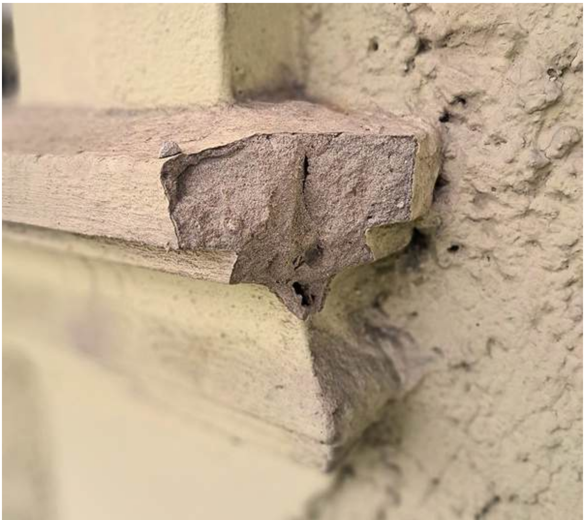
Lokalne ubytki w detalach, jak odpryski z tyt. szkód mrozowych, objawiają wtórne cementowe wyprawy, np. parapetów. Wymagające napraw zaprawami renowacyjnymi z narzutu oraz ewentualnie ciągnionymi "in situ".
