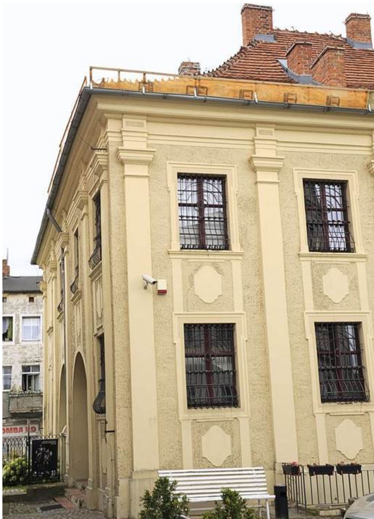
Całokształt stanu elewacji na przykładzie naroża od dziedzińca z powtarzalną problematyką uszkodzeń, np. wypraw parapetów, zacieków, rys i lokalnych ubytków czy destruktywów na wszystkich elewacjach. Wymagający powtarzalnych zabiegów w zakresie prac konserwatorsko -restauratorskich dla renowacji dobrego stanu elewacji.
