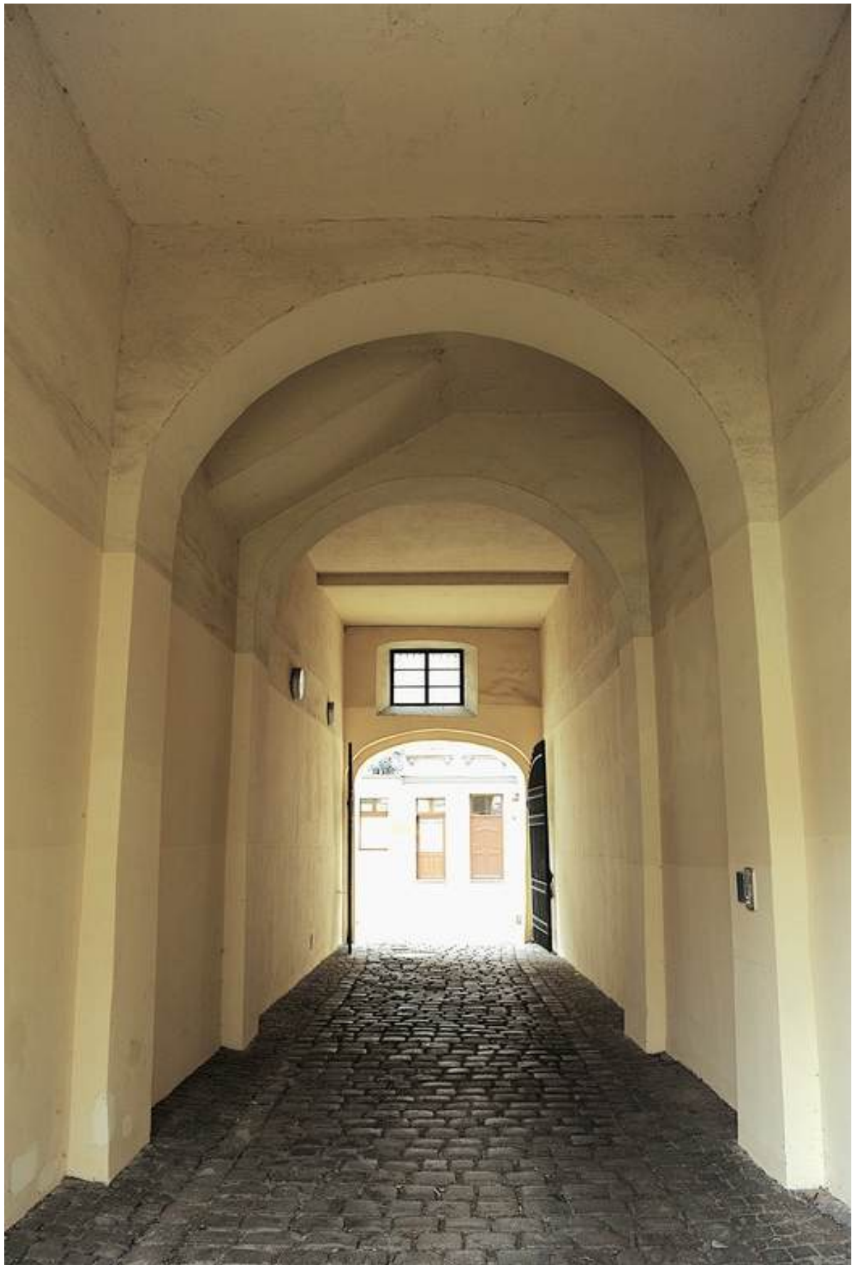
Względnie dobry stan renowacji remontowych przejazdu bramnego poza widocznymi zabrudzeniami osadami. Kwalifikuje powierzchnie głównie do oczyszczenia i przemalowania unifikującego. Widok przejazdu od strony dziedzińca.
