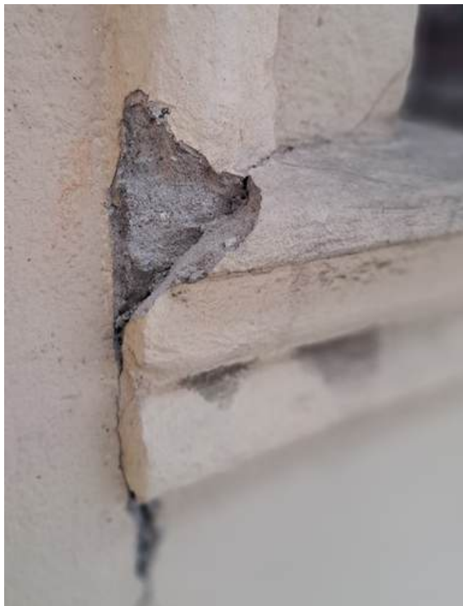
Przykłady uszkodzeń, ubytków a zarazem odkrywek odsłaniających wtórne substancje tynków cementowych.
