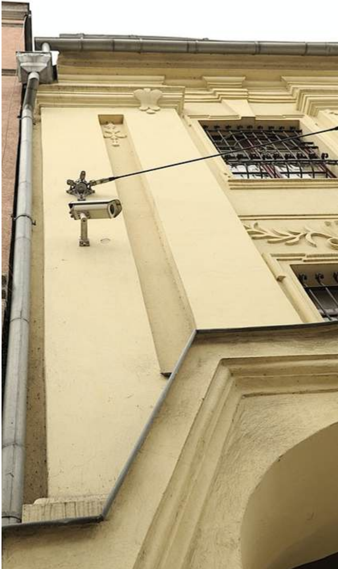
Fragment elewacji frontowej. Elementy współczesnych, niezbędnych instalacji bezpieczeństwa do zachowania. Zbliżenie na stan osadów zabudzeń w fakturze przecieków i duktów powłok renowacyjnych do umycia.
