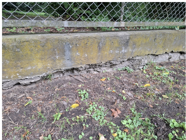
FOTO NR 1 – odcinek 1
