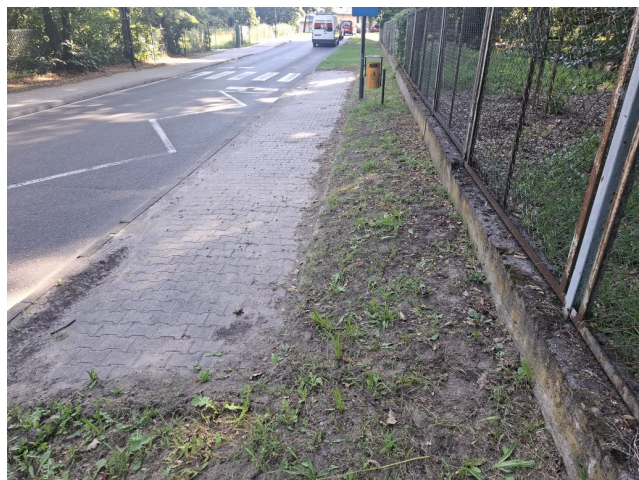
FOTO NR 16 – odcinek 13
