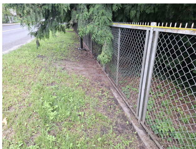
FOTO NR 4 – odcinek 2
