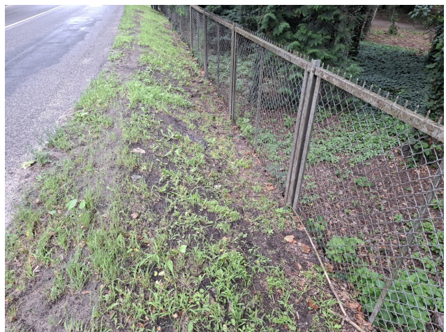
FOTO NR 8 – odcinek 5
