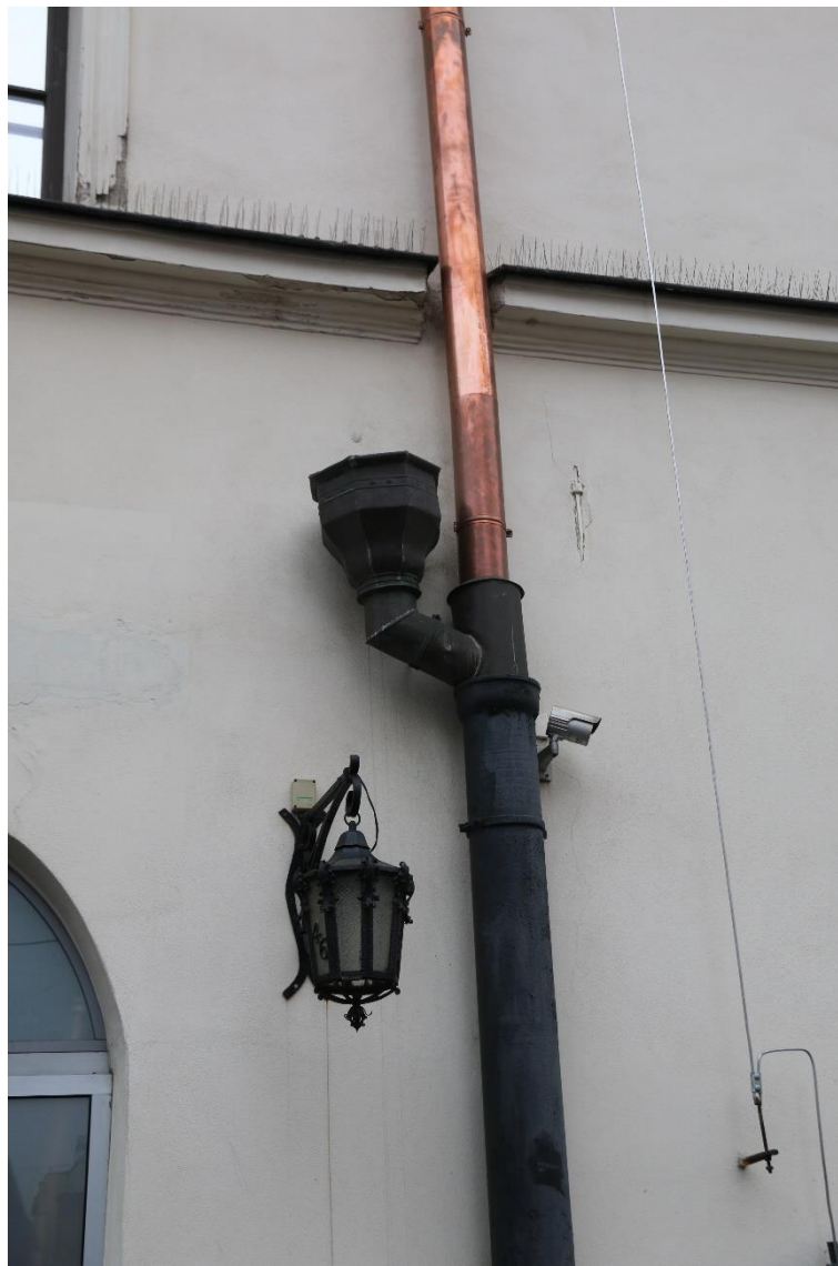
Fot. nr 11 Budynek Muzeum Etnograficznego „Dom Esterki” przy ul. Krakowskiej 46 w Krakowie. Widok profilowanego gzymsu nad parterem na elewacji zachodniej. Widoczne liczne ubytki tynku. Stan przed konserwacją. Kraków, luty 2026 r.
