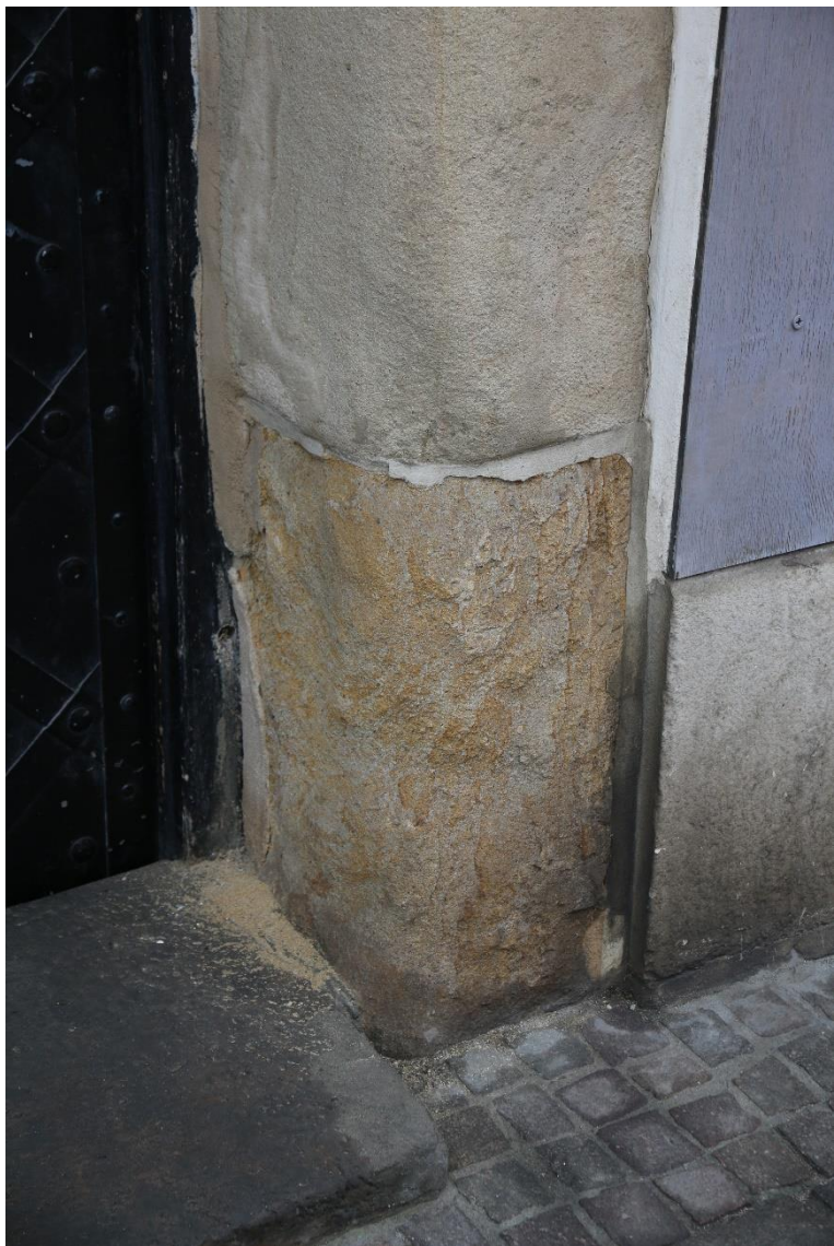
Fot. nr 6 Budynek Muzeum Etnograficznego „Dom Esterki” przy ul. Krakowskiej 46 w Krakowie. Widok dolnej części węgara portalu z piaskowca na elewacji zachodniej. Widoczne osłabienie strukturalne kamienia. Stan przed konserwacją. Kraków, luty 2026 r.
