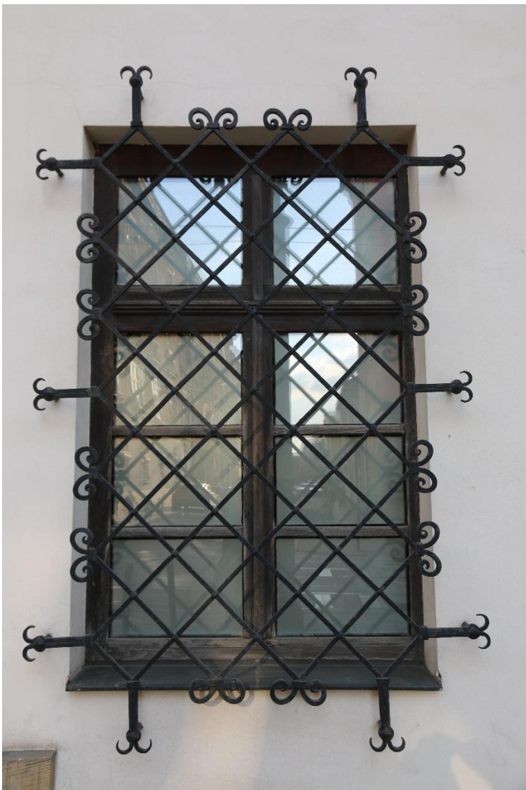
Fot. nr 12 Budynek Muzeum Etnograficznego „Dom Esterki” przy ul. Krakowskiej 46 w Krakowie. Widok okna parteru na elewacji zachodniej. Widoczna stylizowana stolarka okienna w złym stanie technicznym. Stan przed konserwacją. Kraków, luty 2026 r.
