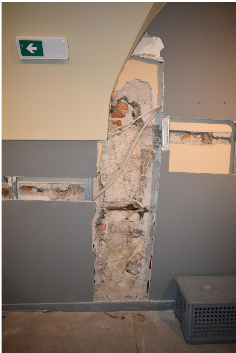
Fot. nr 41 Budynek Muzeum Etnograficznego „Dom Esterki” przy ul. Krakowskiej 46 w Krakowie. Pomieszczenie wystawiennicze. Odkrywka na ścianie południowej. Widoczny zachowany kamienny węgarka. Stan przed konserwacją. Kraków, luty 2026 r.
