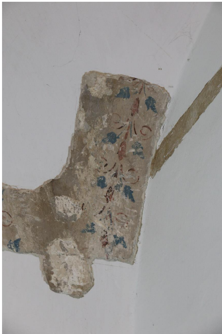
Fot. nr 21 Budynek Muzeum Etnograficznego „Dom Esterki” przy ul. Krakowskiej 46 w Krakowie. Pomieszczenie biblioteki. Odkrywka na wysklepce. Widoczny zachowany roślinny ornament. Stan przed konserwacją. Kraków, luty 2026 r.
