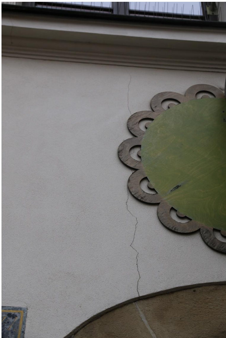
Fot. nr 10 Budynek Muzeum Etnograficznego „Dom Esterki” przy ul. Krakowskiej 46 w Krakowie. Widok pęknięcia tynku nad wejściem głównym na elewacji zachodniej. Stan przed konserwacją. Kraków, luty 2026 r.
