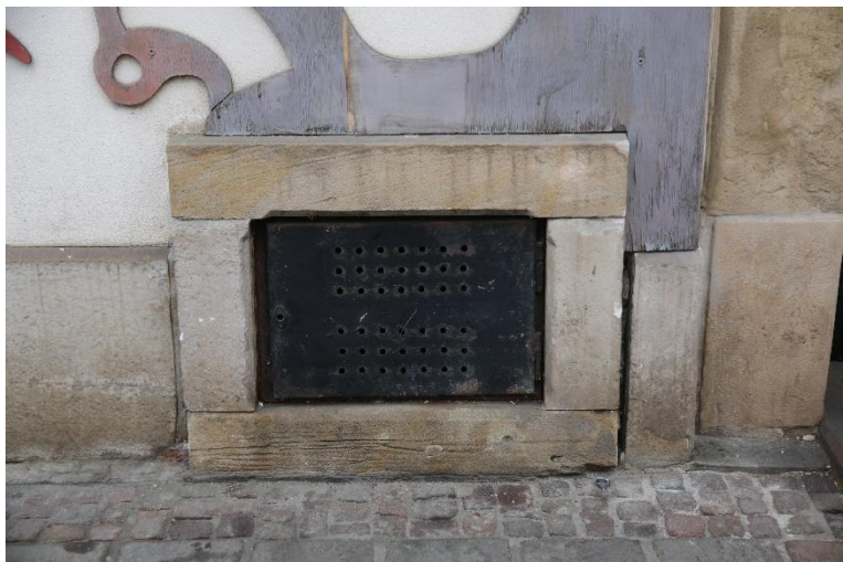
Fot. nr 14 Budynek Muzeum Etnograficznego „Dom Esterki” przy ul. Krakowskiej 46 w Krakowie. Widok okna piwnicznego na elewacji zachodniej. Widoczne uszkodzenia obramienia kamiennego. Stan przed konserwacją. Kraków, luty 2026 r.
