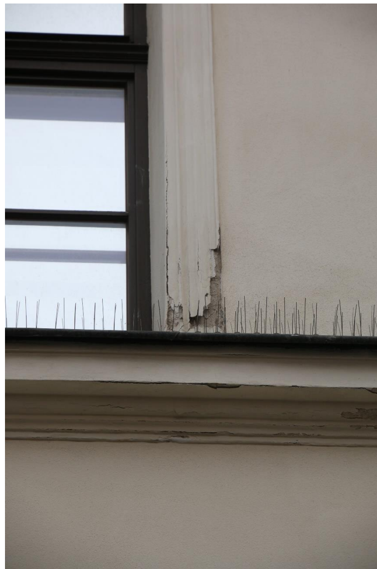
Fot. nr 9 Budynek Muzeum Etnograficznego „Dom Esterki” przy ul. Krakowskiej 46 w Krakowie. Widok okna I piętra na elewacji zachodniej. Zbliżenie uszkodzeń tynkowanej profilowanej opaski okiennej. Stan przed konserwacją. Kraków, luty 2026 r.
