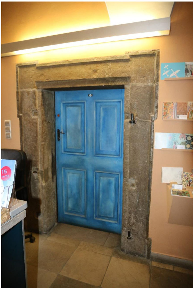
Fot. nr 24 Budynek Muzeum Etnograficznego „Dom Esterki” przy ul. Krakowskiej 46 w Krakowie. Widok drewnianych płycinowych drzwi do biblioteki od strony sieni. Widoczny także historyczny kamienny portal. Stan przed konserwacją. Kraków, luty 2026 r.
