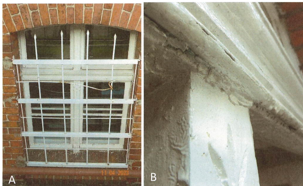
fot 19. Okno w kondygnacji piwnicy – jadalnia: A – widok ogólny z zewnątrz; B – fragment skrzydła zewnętrznego – widoczne zniszczenia.
