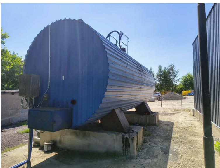
PRZEDMIOTOWY ZBIORNIK NA EMULSJĘ ASFALTOWĄ
