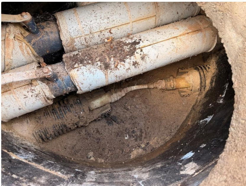
Przewężenie rurociągu wodnego.
