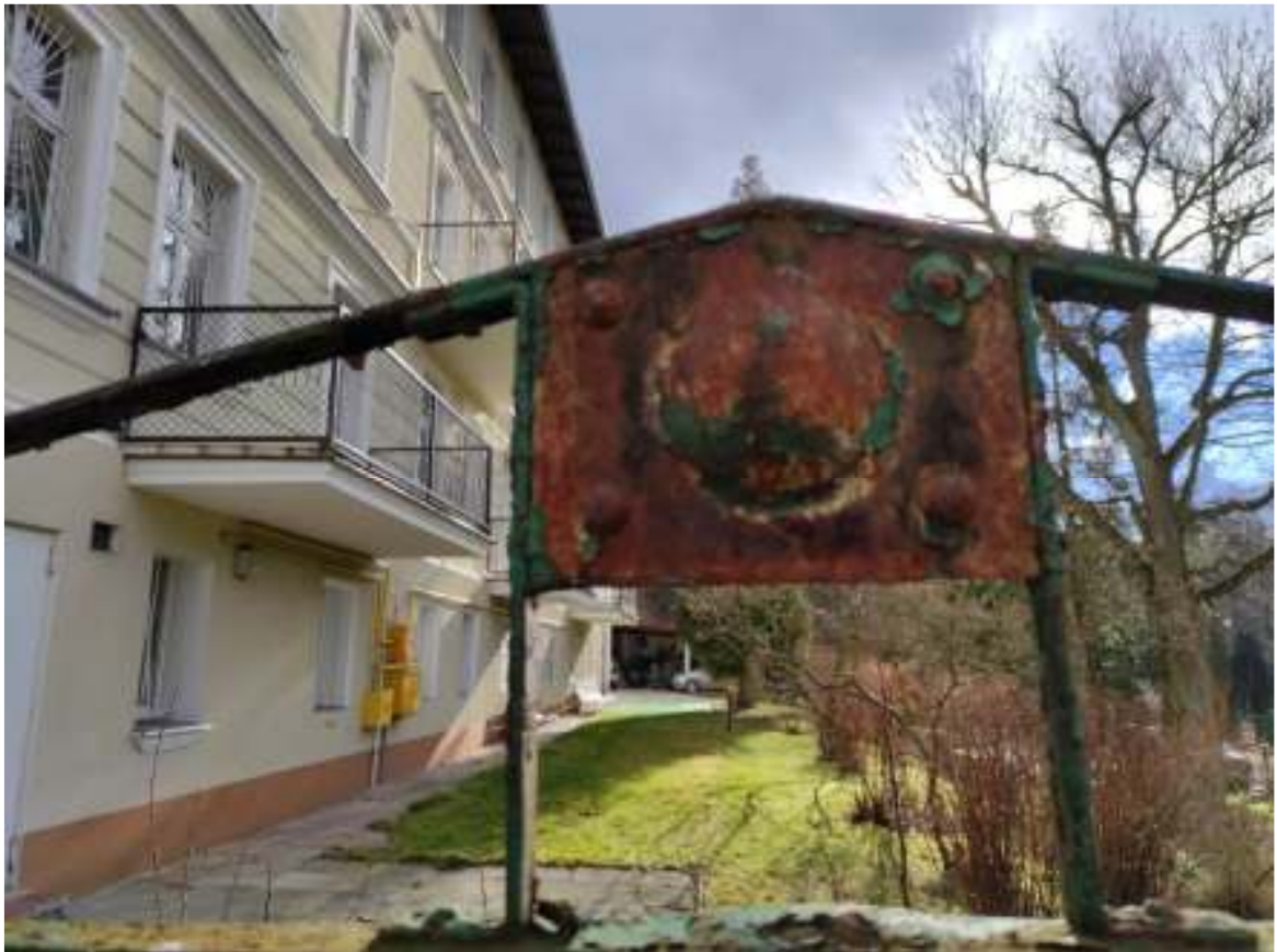
Zdj.4. Detal przęsła ogrodzenia historycznego (widoczna wyraźna korozja).
