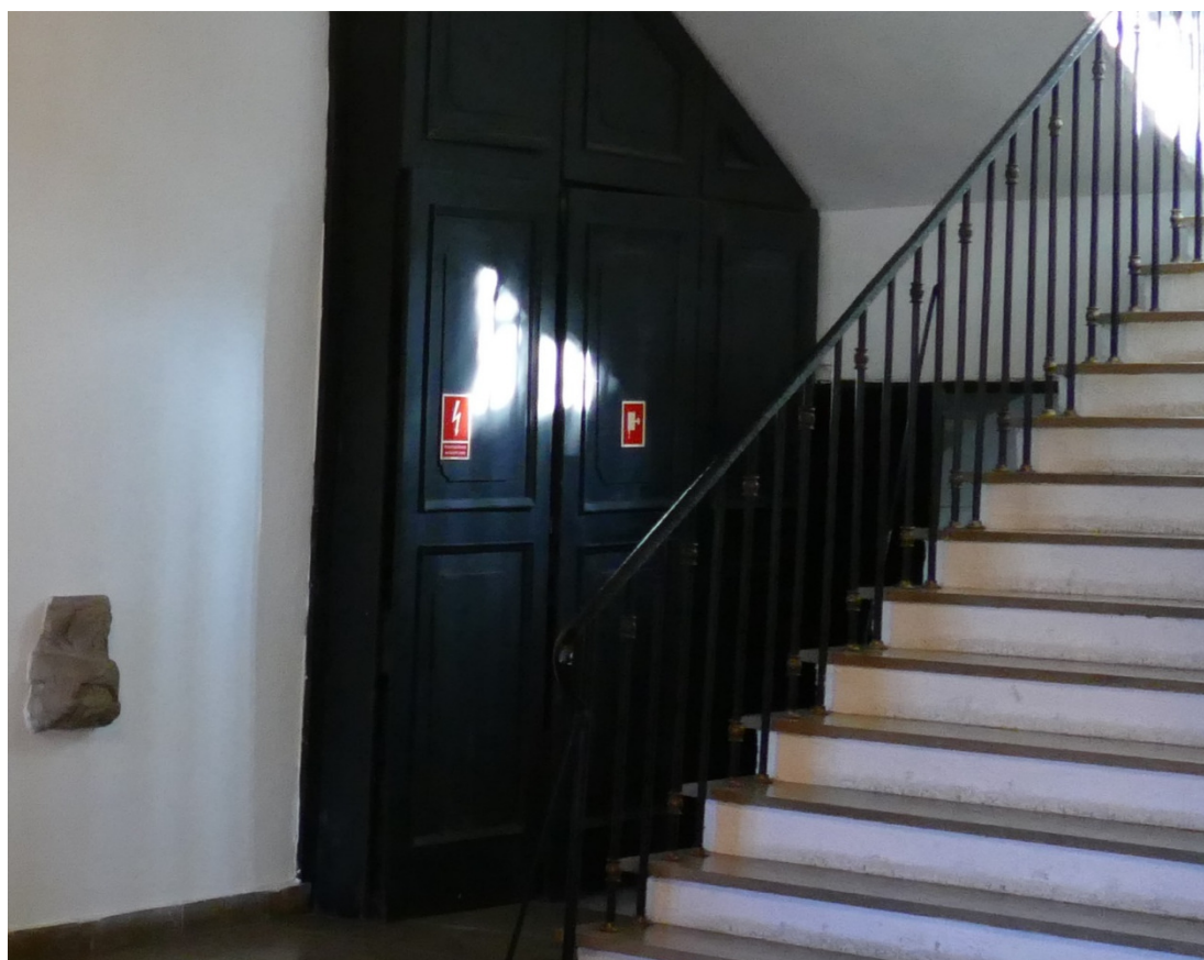
Fot. 13 Widok z holu w kierunku korytarza, na szafy z licznikami i hydrantem, pom. nr D/0/003
