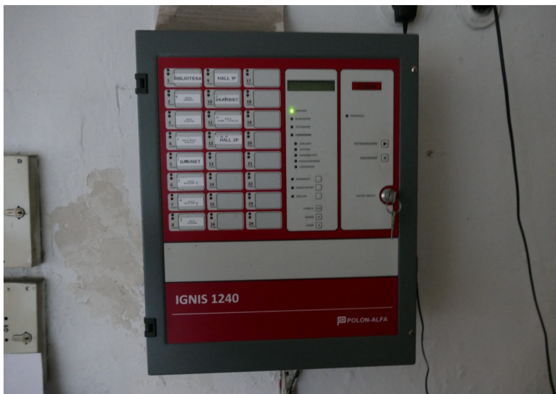
Fot. 12 Centrala sygnalizacji pożarowej POLON, w korytarzu, pom. nr D/0/003
