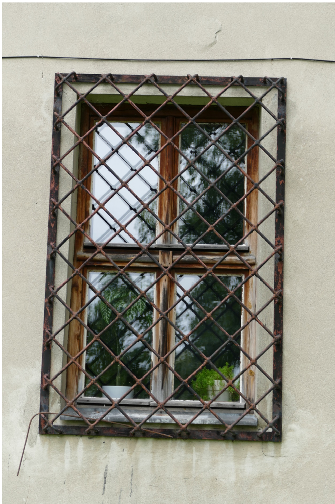
Fot. 39 Stolarka okienna przeznaczona do wymiany
