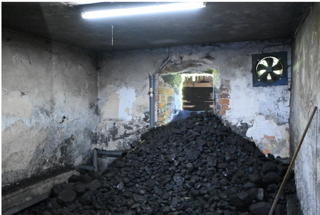
Fot. 10 Pomieszczenie kotła nr D/0/001 wraz ze składem opału
