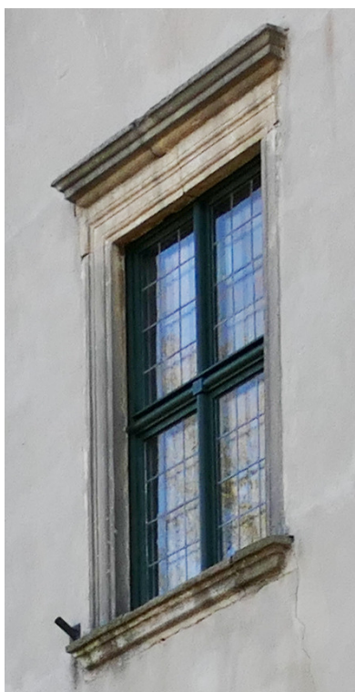
Fot. 4 Okno wymienione (jedno z 10)
