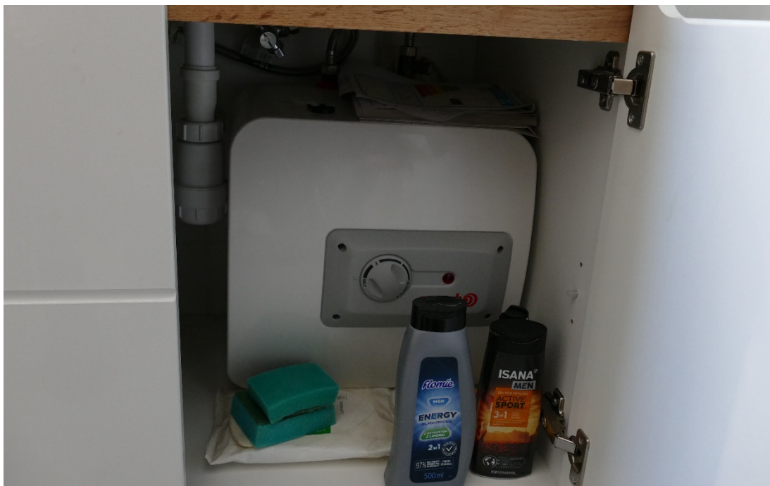
Fot. 18 Podgrzewacz wody w łazience, pom. nr D/2/208
