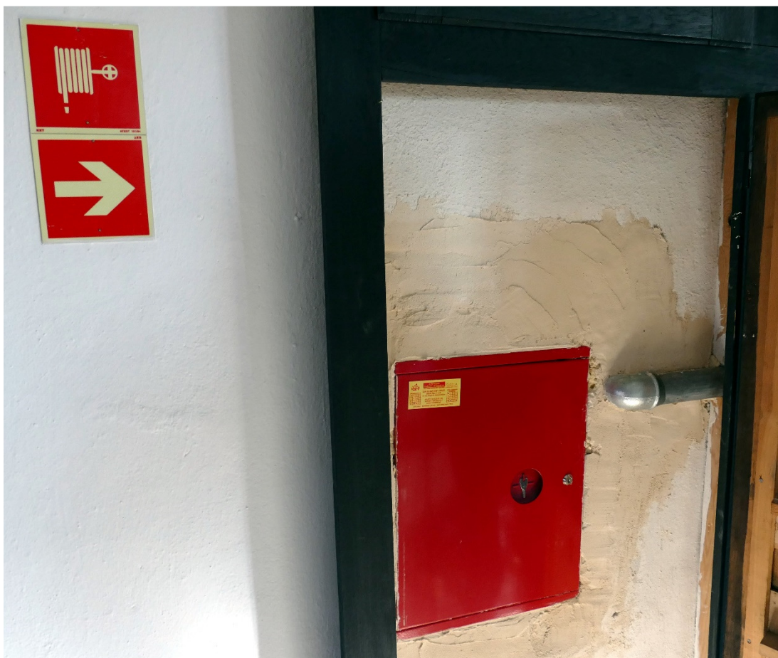
Fot. 16 Przykładowy hydrant, w korytarzu, pom. nr D/2/311 (wnęka)
