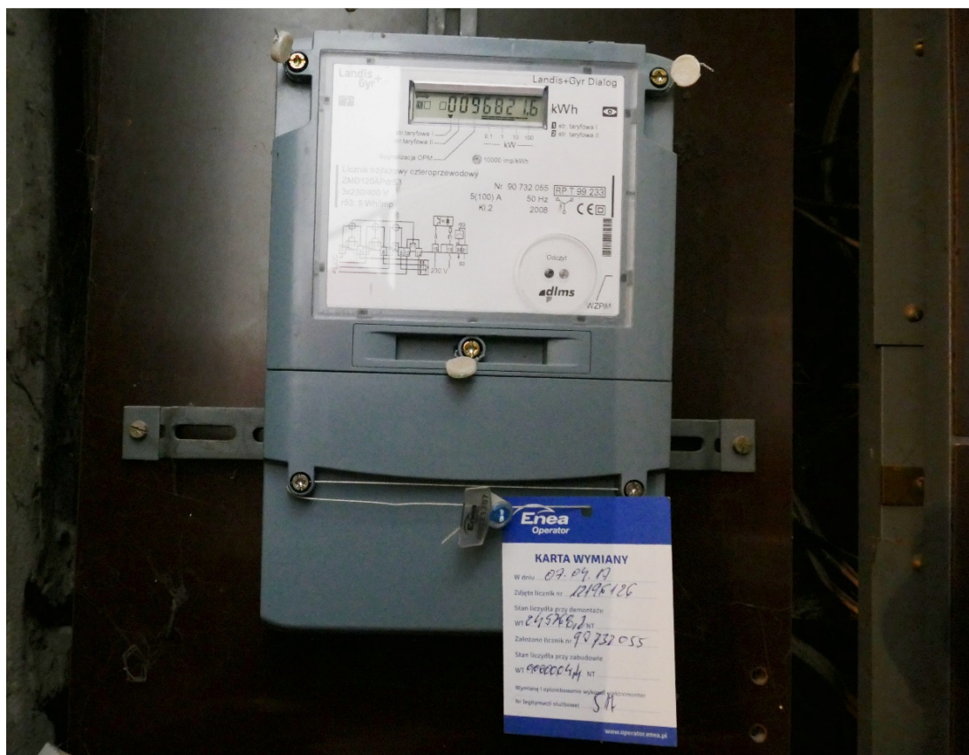
Fot. 14 Licznik energii, w korytarzu, pom. nr D/0/003 (wnęka)
