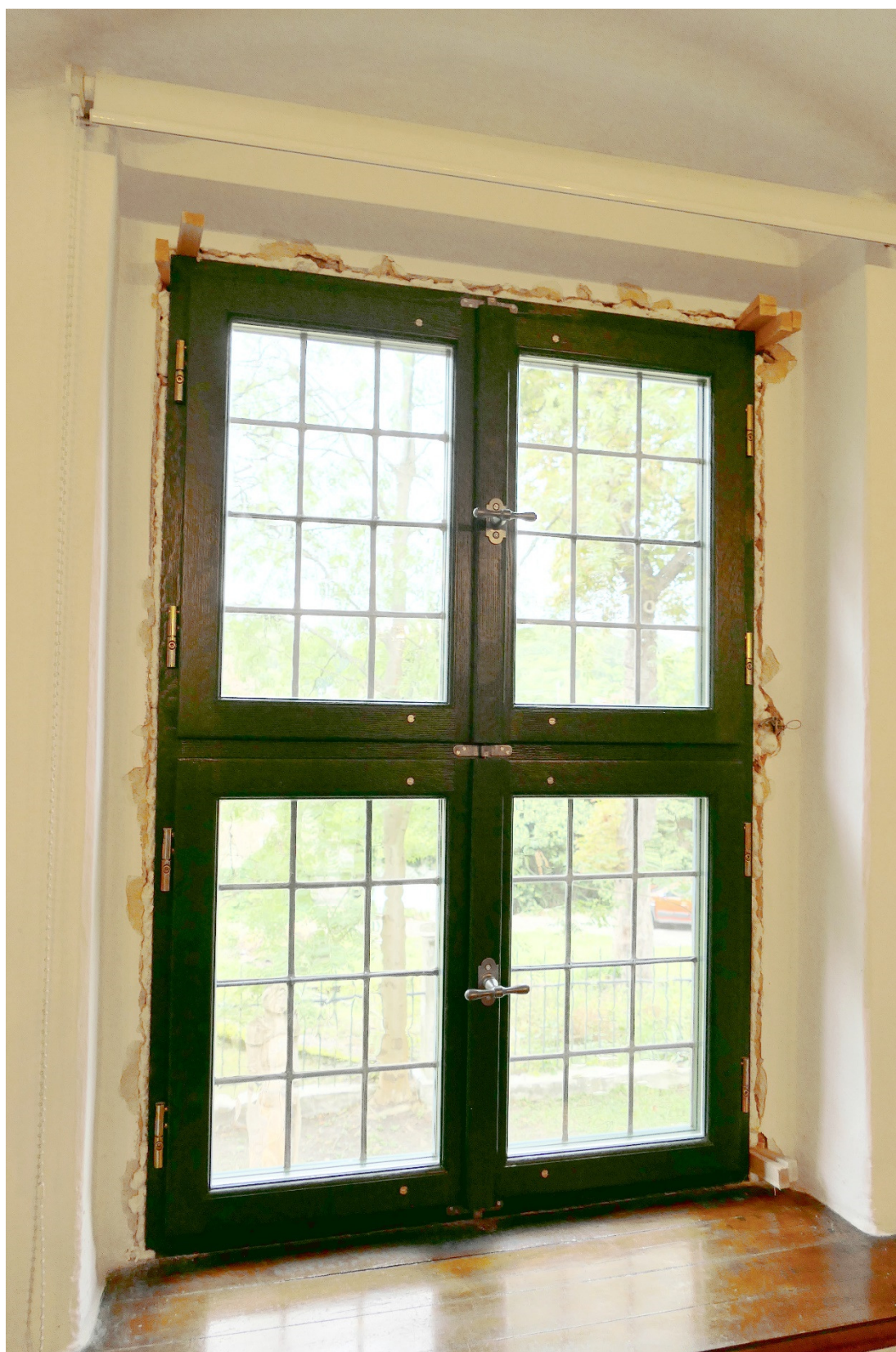
Fot. 35 Przykładowe okno wymienione w 2024 r.
