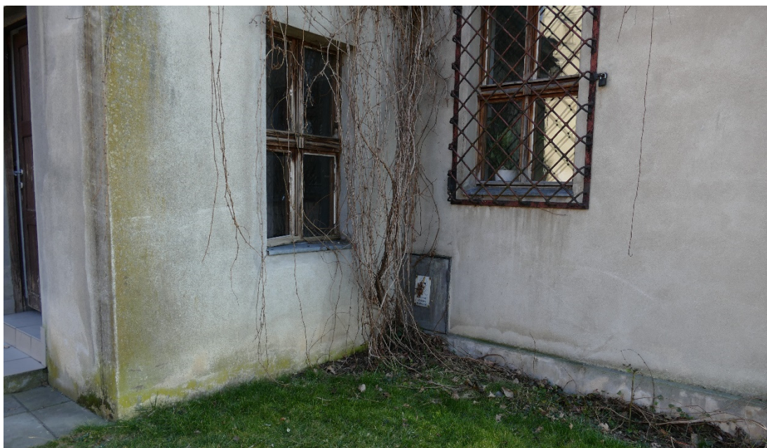
Fot. 40 Szafka elektryczna
