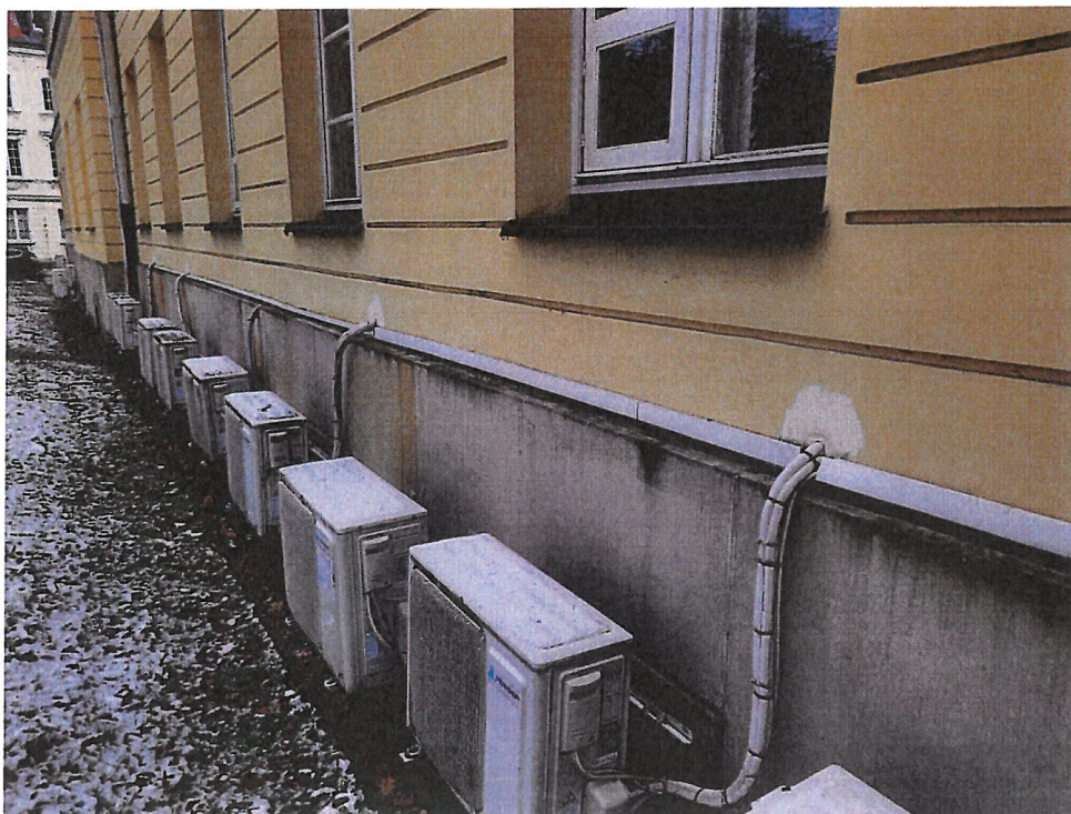
Fot. 38. Klimatyzatory na całej szerokości ściany północnej. Widoczne uszkodzenia tynku przy mocowaniach rur.
