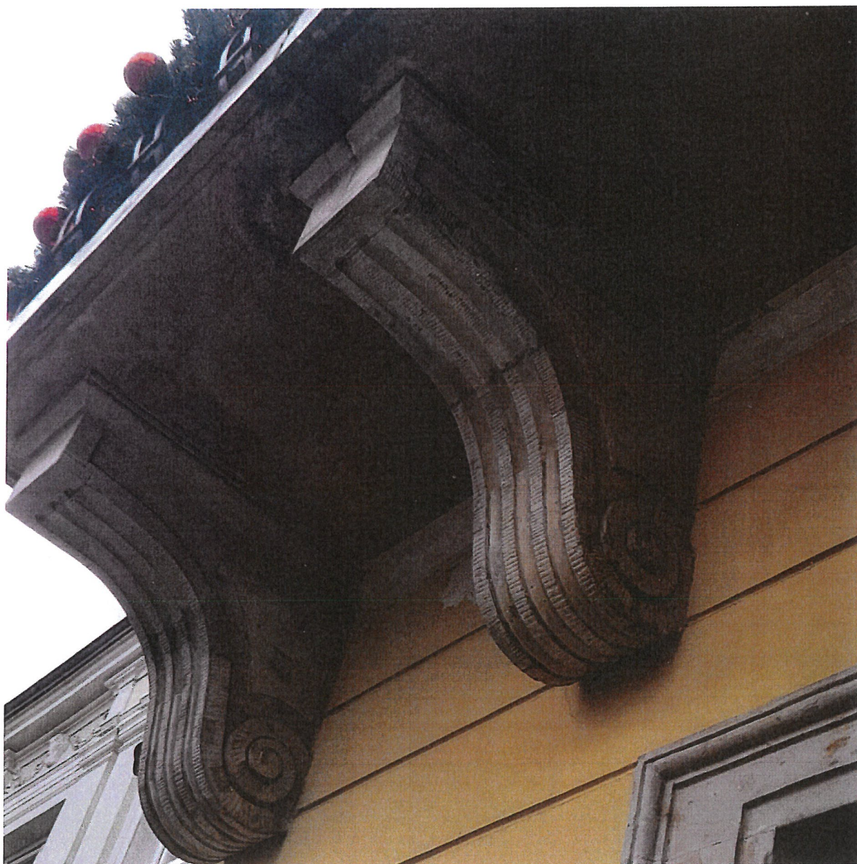
Fot. 69. Kamienna płyta balkonu ryzalitu frontowego, widok od dołu. Widoczne zabrudzenie, zawilgocenie, spękania i nieestetyczne uzupełnienia konsol.
