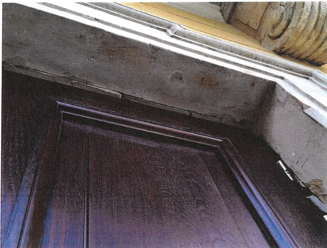
Fot. 67. Górna belka glifu portalu. Widoczne odspojenia i wykruszanie się kamienia przy skrzydłach drzwiowych.
