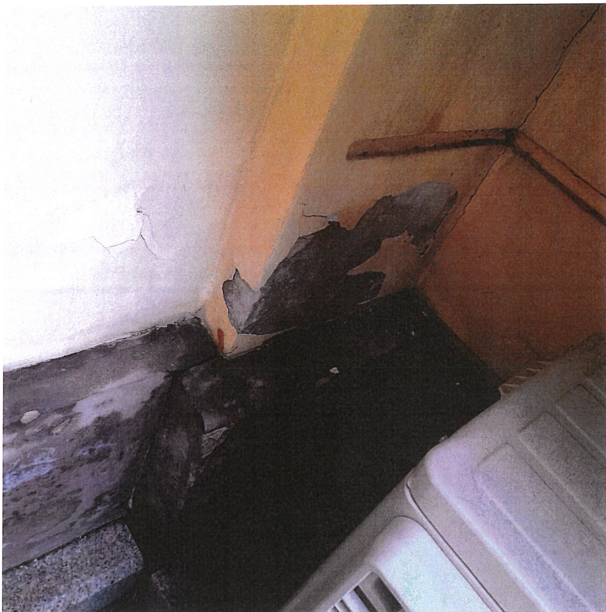
Fot. 34. Dolna część elewacji od strony dziedzińca. Zawilgocony kamień cokołu oraz spękania i odspojenia tynku spowodowane wilgocią podciąganą kapilarnie.
