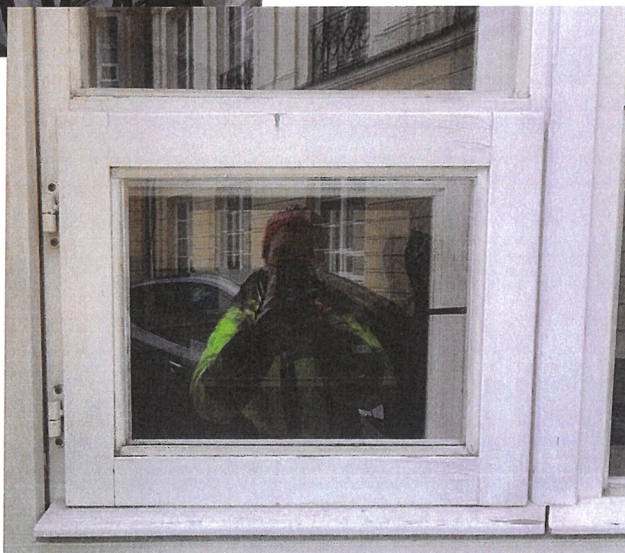
Fot. 74. Zbliżenie na okno parteru oficyny od strony dziedzińca. Widoczne ubytki i spękania warstwy malarskiej.
