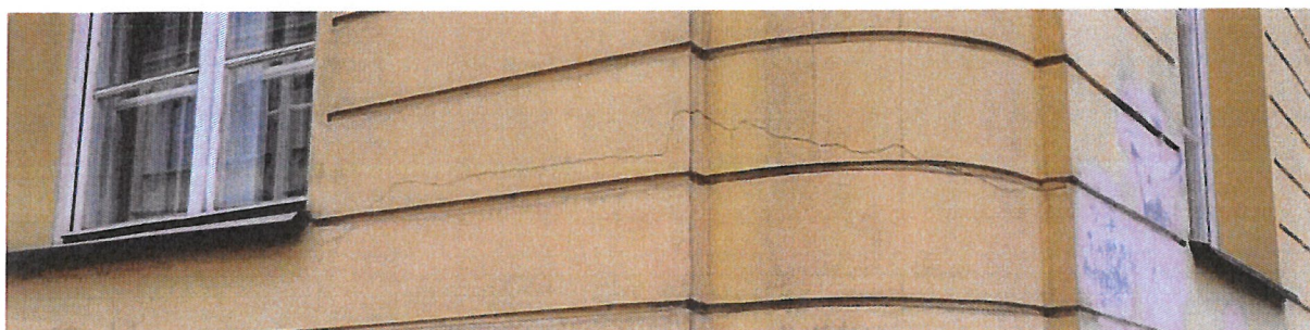
Fot. 82. Spękanie poprzeczne, łączące dolne glify okien na narożniku elewacji wsch. i pn.
