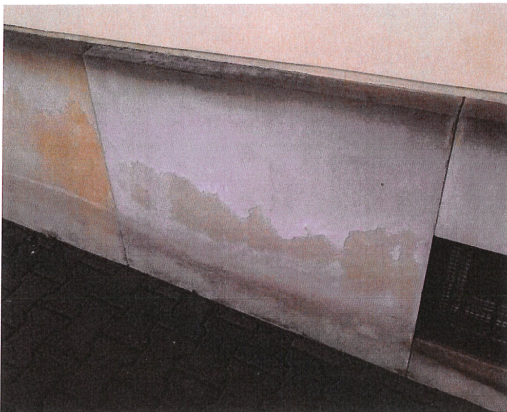
Fot. 30. Cokół oficyny zachodniej, od strony ul. Senatorskiej. Widoczne skutki zawilgocenia kapilarnego: linia podciąganej wilgoci i degradacja powierzchni kamienia.
