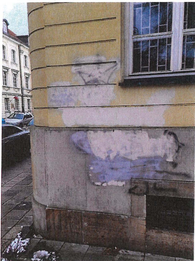
Fot. 85. Przejaw wandalizmu w postaci graffiti na elewacji północnej (tylnej), u zbiegu z ul. Nowy Przejazd.
