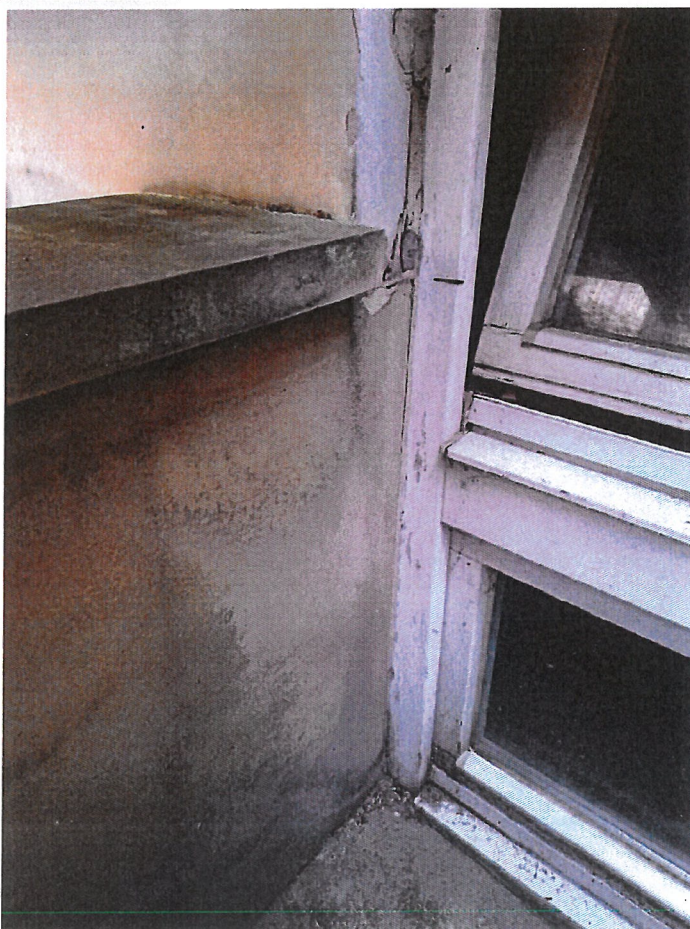
Fot. 61. Wnętrze studzienki. Widoczne uszkodzenia ściany przy osadzeniu ramy okiennej oraz linia podciągania kapilarnego wody na kamiennej ścianie studzienki.
