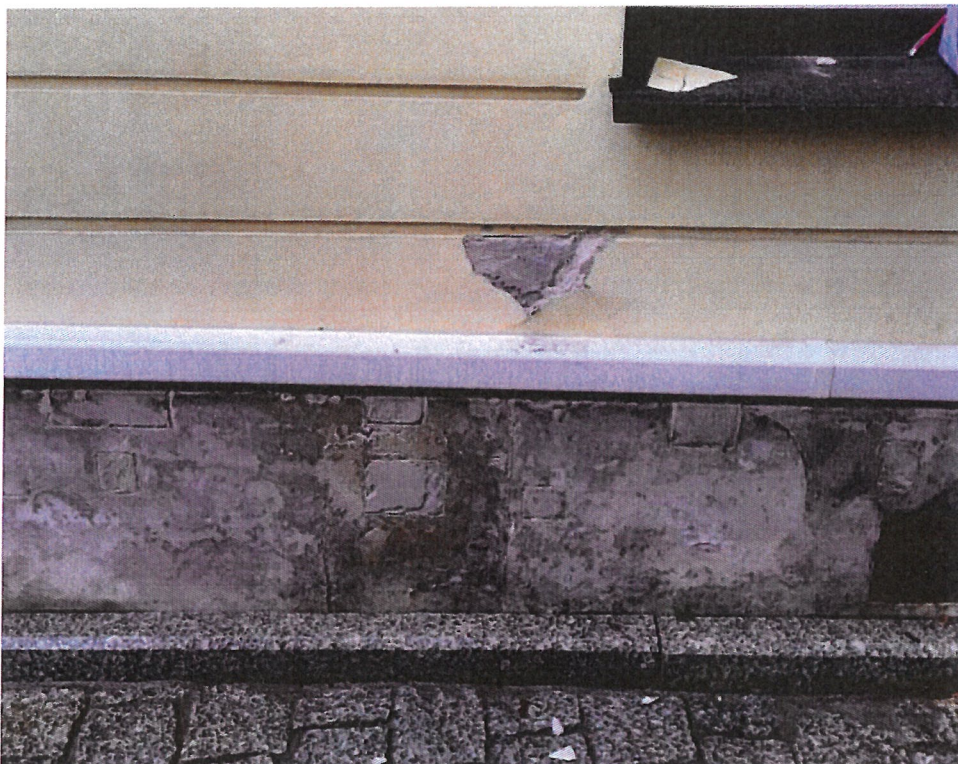
Fot. 158. Uszkodzenie wykorzystane do wykonania odkrywki nr 20.
