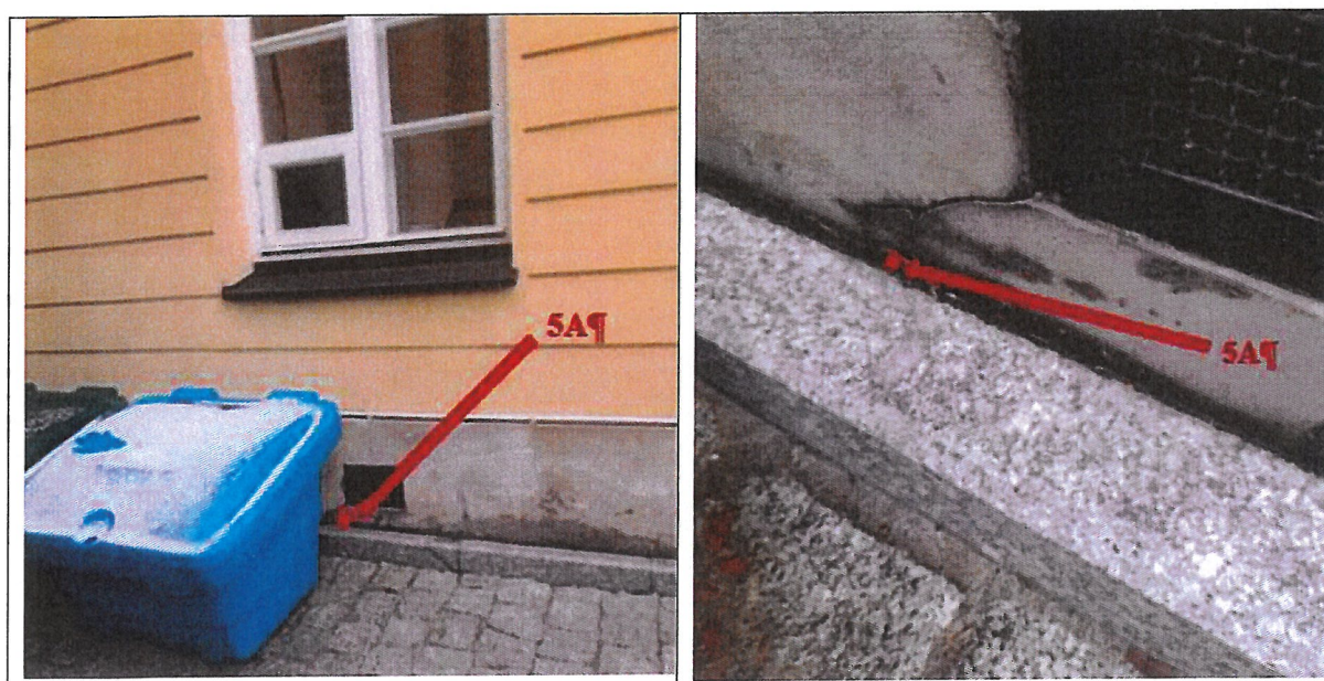
Fot. 109 i 110. Elewacja zach. skrzydła korpusu głównego od strony dziedzińca. Zbliżenie na miejsce pobrania próbki nr 5A.
