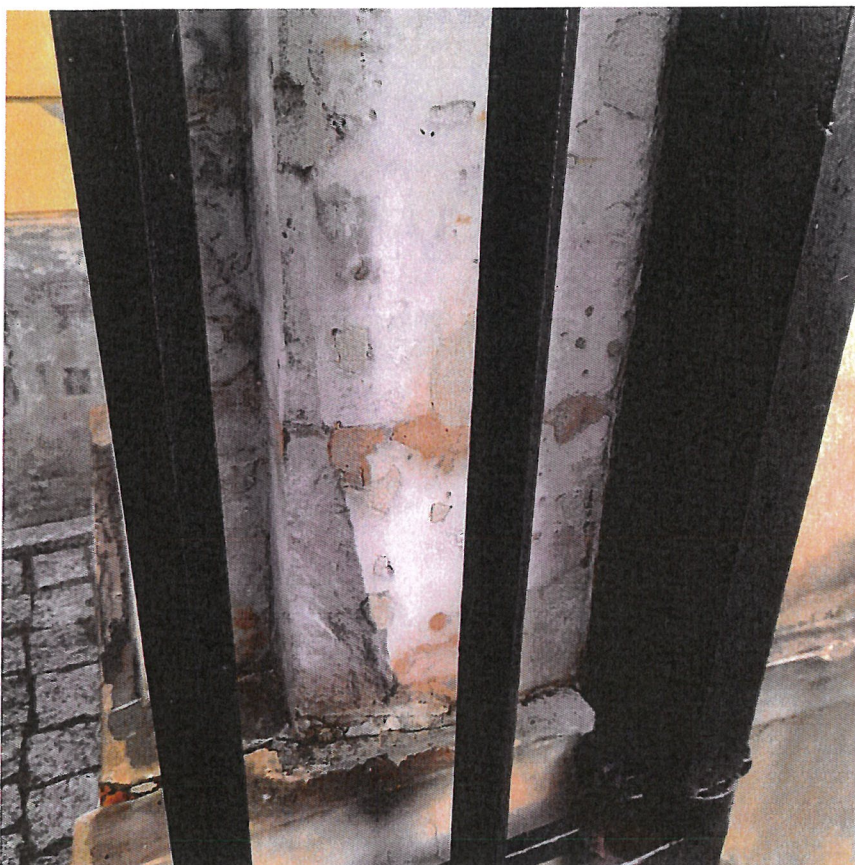
Fot. 52. Filar wschodni od strony przejazdu. Widoczne ubytki kamienia i nieestetyczne uzupełnienia.
