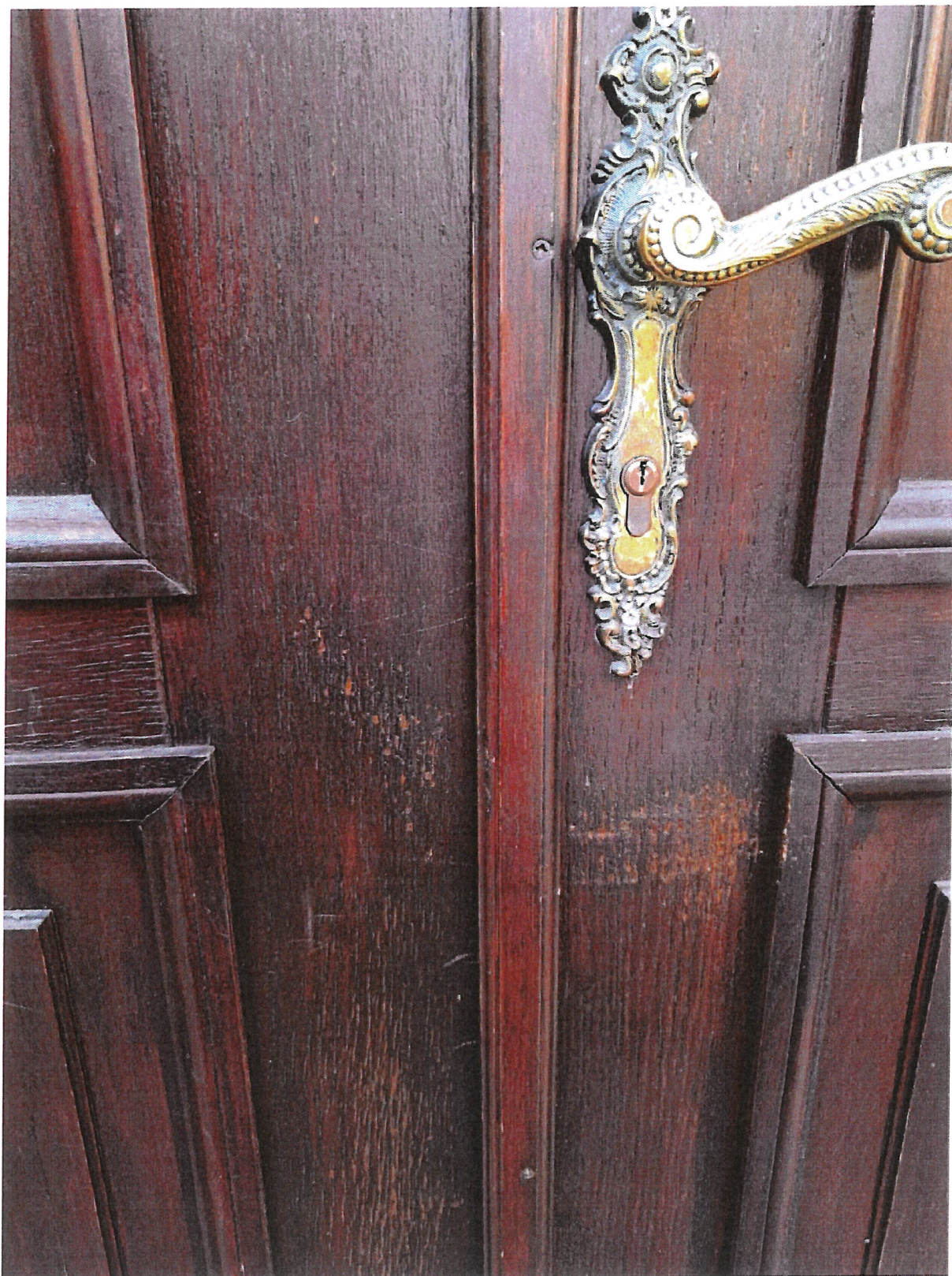
Fot. 71. Widoczne spękania i otarcia warstw lakieru i bejcy na listwie przymykowej oraz po obu jej stronach.
