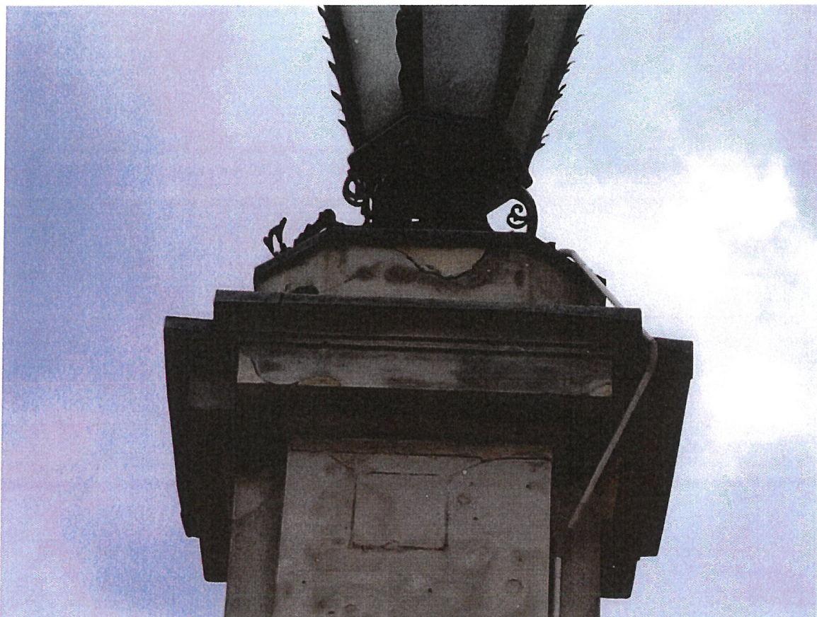
Fot. 54. Gzyms wieńczący filar wschodni, widok od strony ul. Senatorskiej. Widoczne zabrudzenia, spękania i nieestetyczne uzupełnienia.
