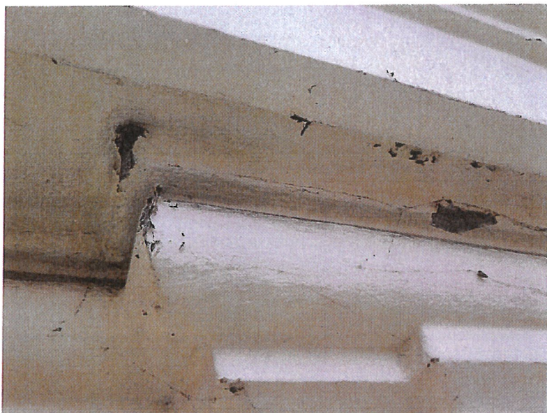
Fot. 76. Zbliżenie na zabrudzenia oraz spękania i ubytki farby na detalach architektonicznych.
