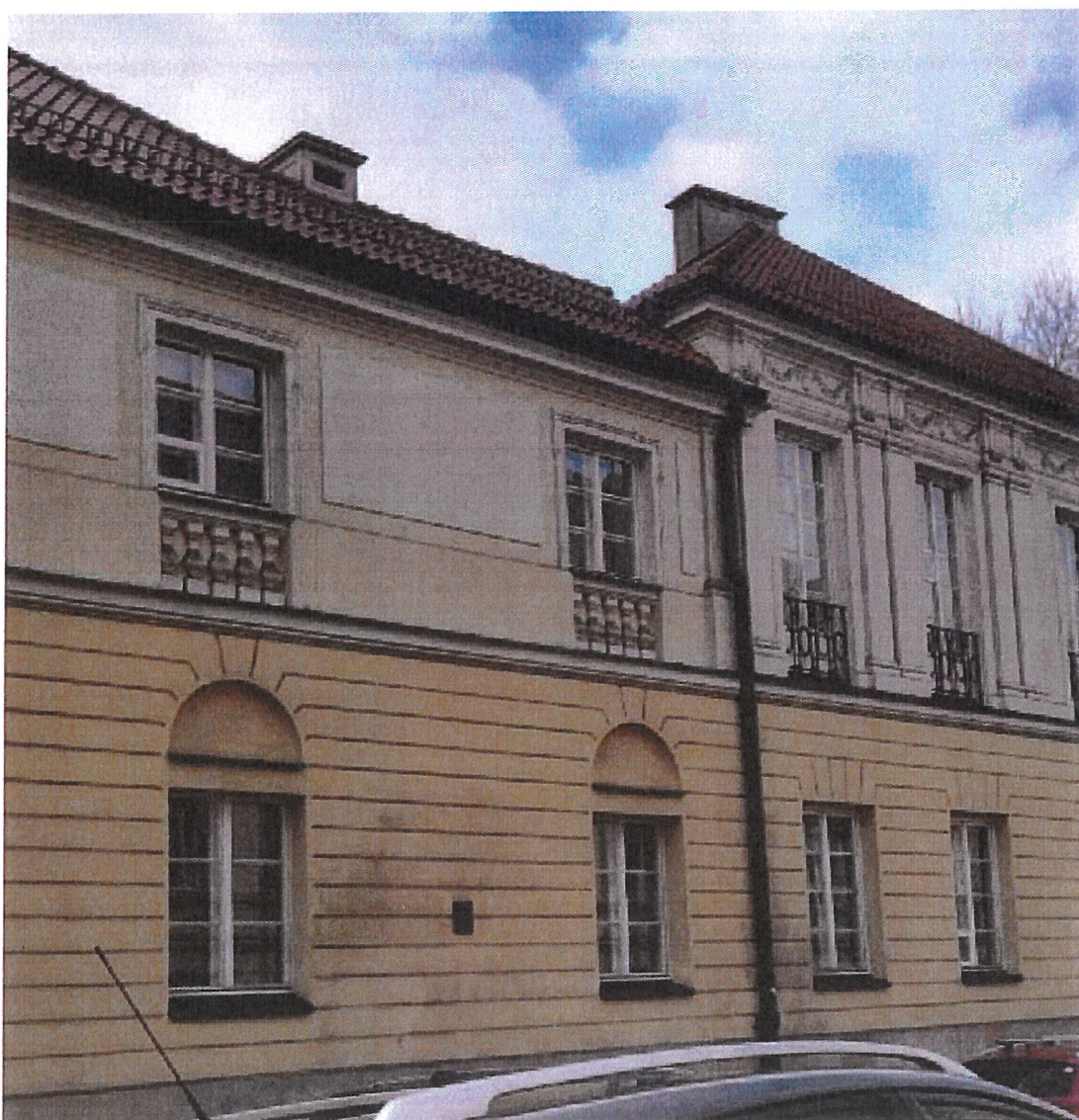
Fot. 77. Elewacja wschodnia. Widoczne silniej zabrudzone fragmenty w strefie parteru i brudne zacieki wody opadowej na cokole pierwszego piętra,
