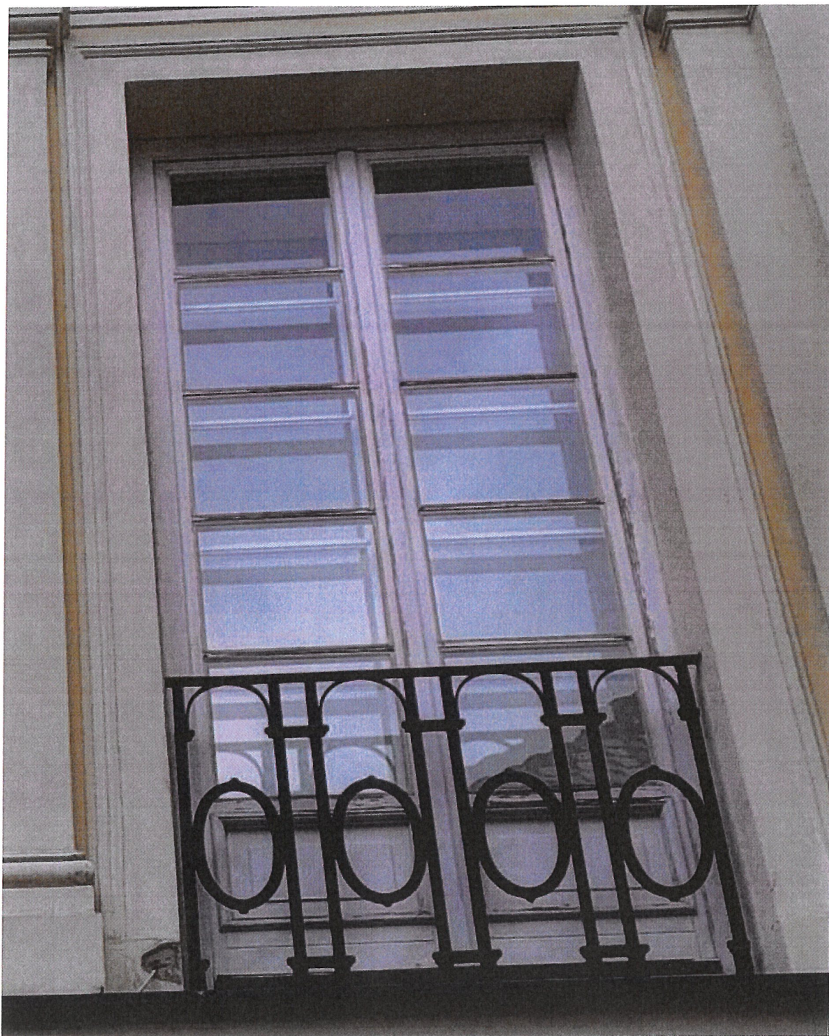
Fot. 72. Porte-fenêtre pierwszego piętra korpusu głównego od strony dziedzińca. Widoczne ubytki powłoki malarskiej na wszystkich elementach stolarki.
