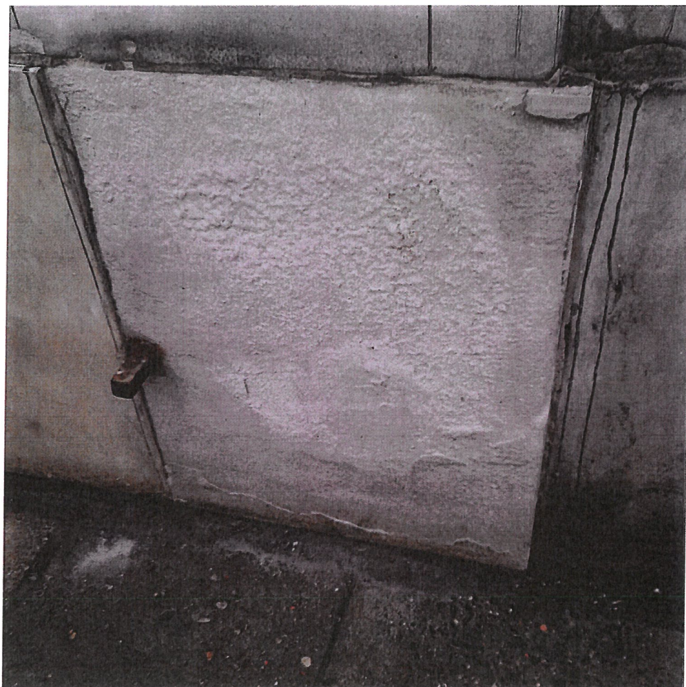
Fot. 32. Płyta cokołu od strony ul. Nowy Przejazd. Widoczne wykwity soli rozpuszczalnych w wodzie.
