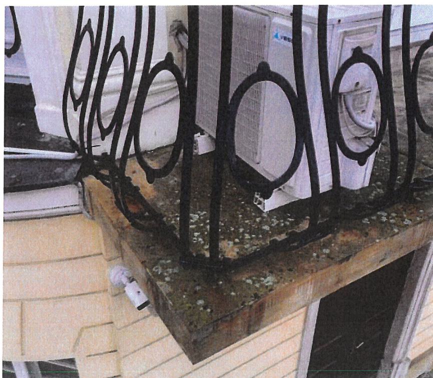
Fot. 68. Kamienna płyta balkonu ryzalitu frontowego, widok od góry. Widoczne silne porażenie mikrobiologiczne, występowanie mchów i porostów.
