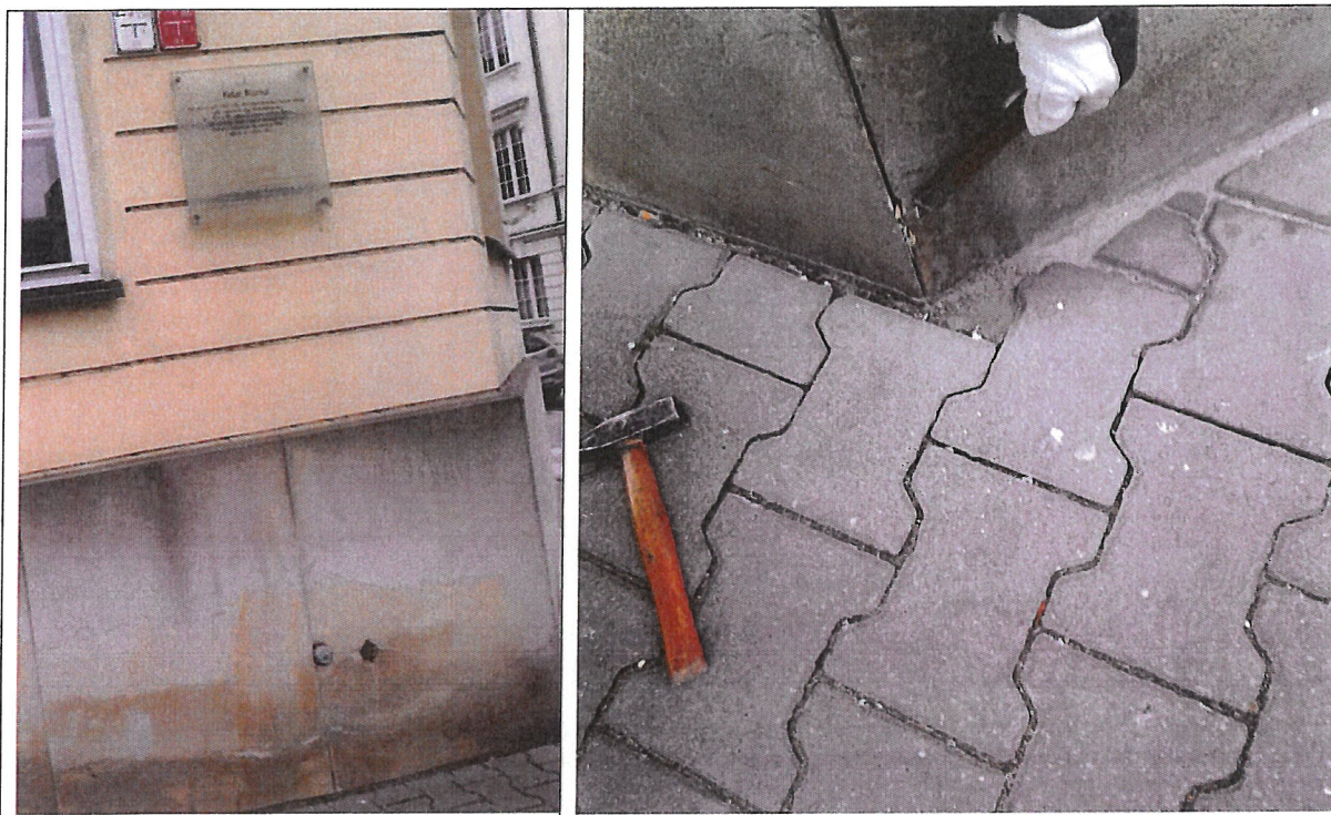
Fot. 121 i 122. Oficyna wsch. od strony ul. Senatorskiej, na narożniku z balkonem Zbliżenie na miejsce pobrania próbki nr 8.
