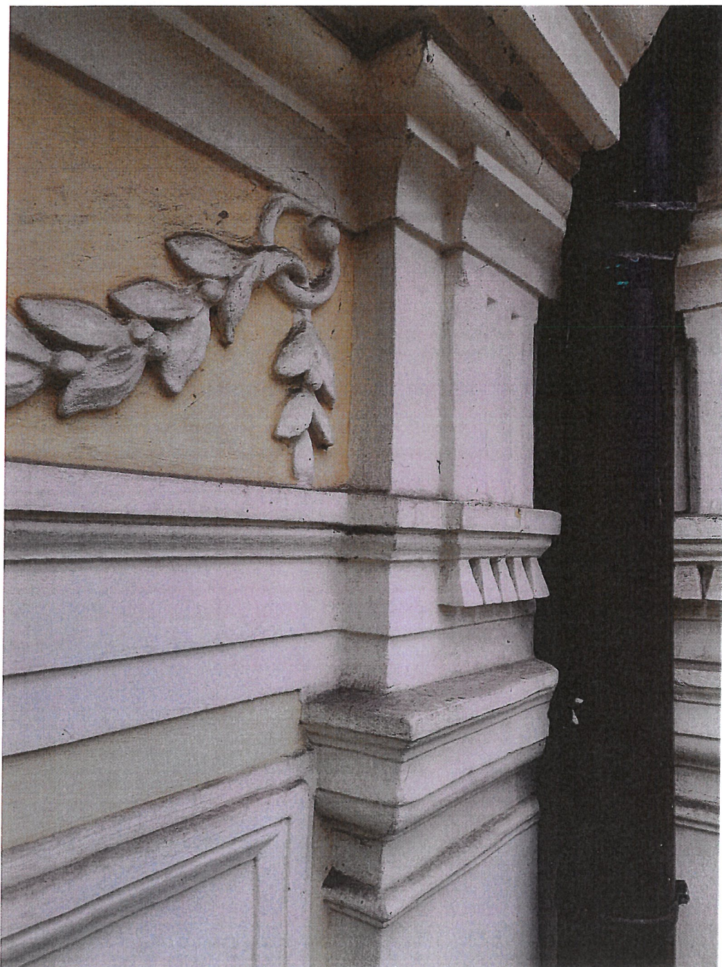
Fot. 75. Fragment fryzu elewacji pierwszego piętra korpusu głównego od strony dziedzińca. Widoczne zabrudzenia.
