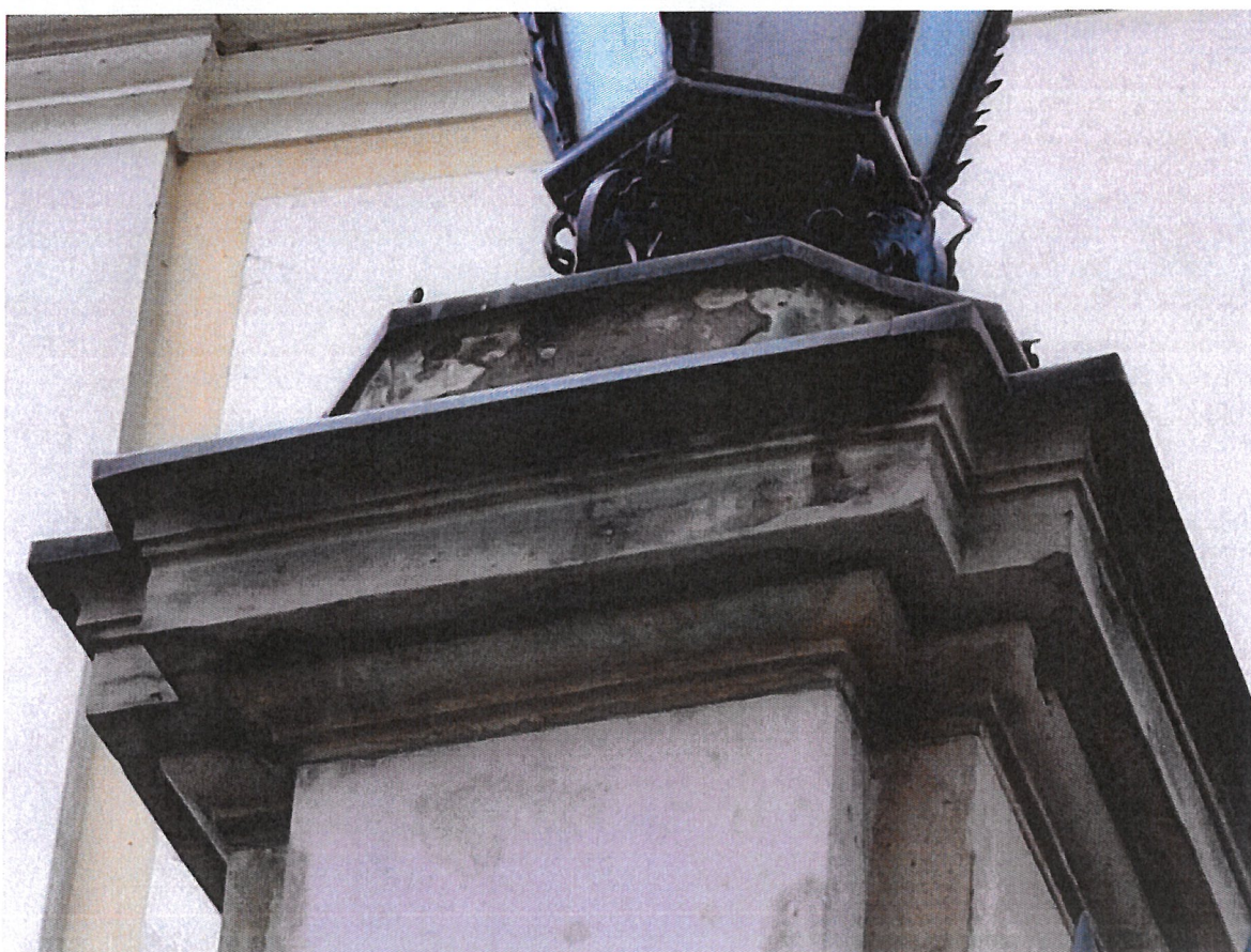
Fot. 53. Gzyms wieńczący filar zachodni, widok od strony prześwitu. Widoczna gruba skorupa zabrudzeń.
