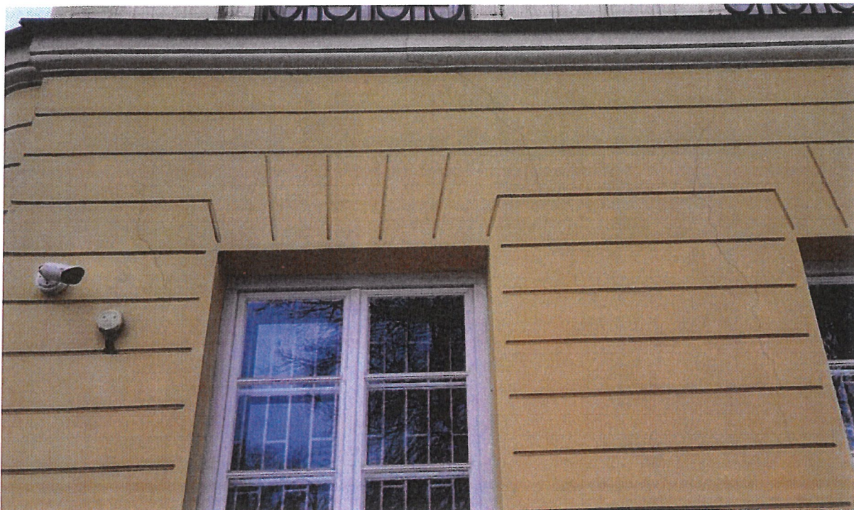
Fot. 81. Spękania tynku rozpoczynające się w środkowej części parteru, środkowe przechodzi na gzyms oddzielający parter od pierwszego piętra; skrajne urywają się niżej.
