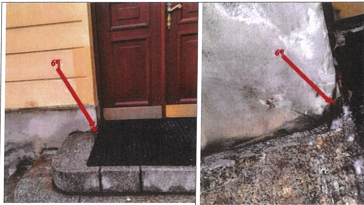
Fot. 111 i 112. Elewacja oficyny zach. od strony dziedzińca, na prawo od drzwi nr 1. Zbliżenie na miejsce pobrania próbki nr 6.
