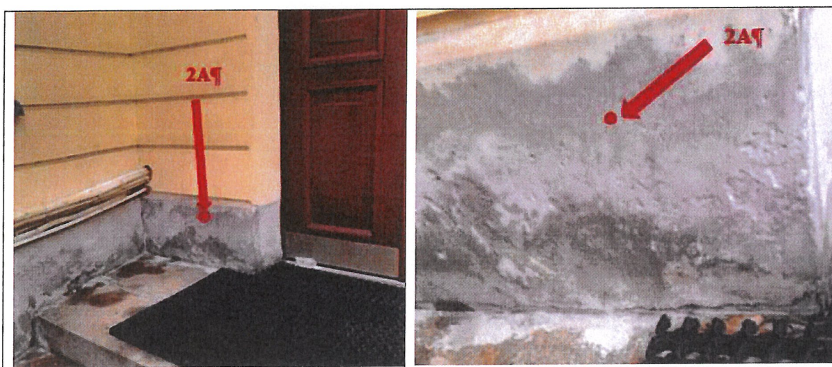
Fot. 96 i 97. Elewacja oficyny wschodniej od strony dziedzińca przy drzwiach nr 4. Zbliżenie na miejsce pobrania próbki nr 2 A.
