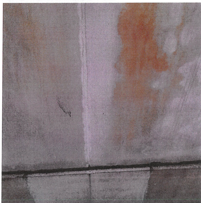
Fot. 36. Cokół od strony północnej. Widoczna niestarannie wykonana fuga.
