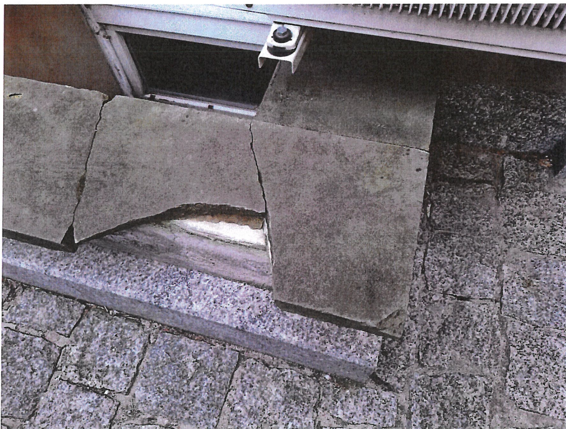
Fot. 63. Studzienka przy wejściu nr 1. Pomimo przymocowania płyt kamienia, widoczne spękania i ubytki.
