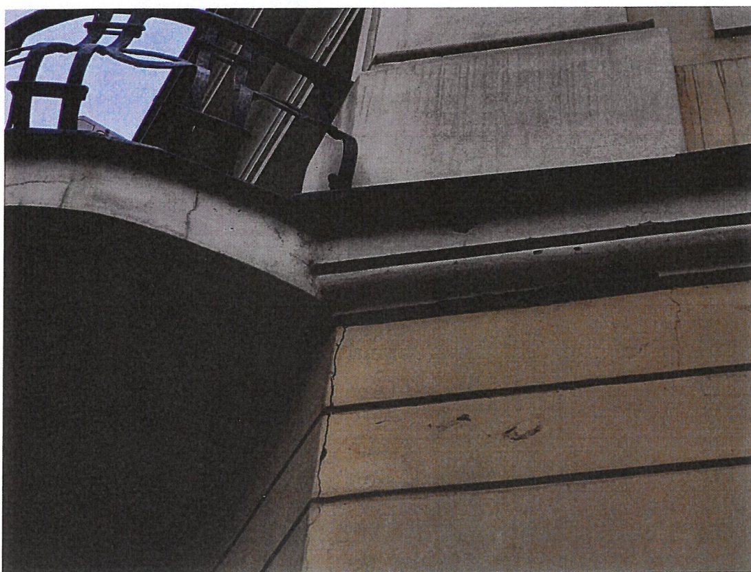
Fot. 84. Balkon na narożu u zbiegu ul. Senatorskiej i Nowy Przejazd, widok z boku. Poza spękaniami na krawędzi balkonu widoczne pęknięcie tynku na narożniku budynku, ubytki na gzymsie i zabrudzenia od wody opadowej.
