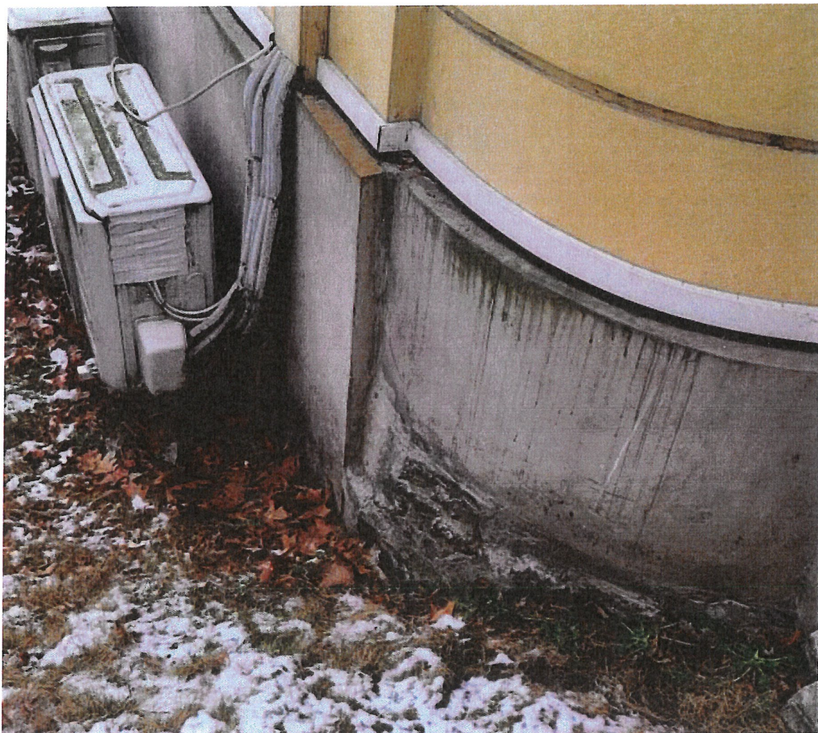
Fot. 41. Północno-zachodni narożnik cokołu elewacji. Widoczny odsłonięty fundament i zmiana wysokości gruntu. Obniżenie gruntu od strony Trasy W-Z powoduje spływanie wody do budynku, co skutkuje jego zawilgoceniem. Z kolei podniesienie gruntu przy elewacji, przylegającej do nowego budynku ratusza, również przyczynia się do przenikania wody w pory kamieni cokołu.
