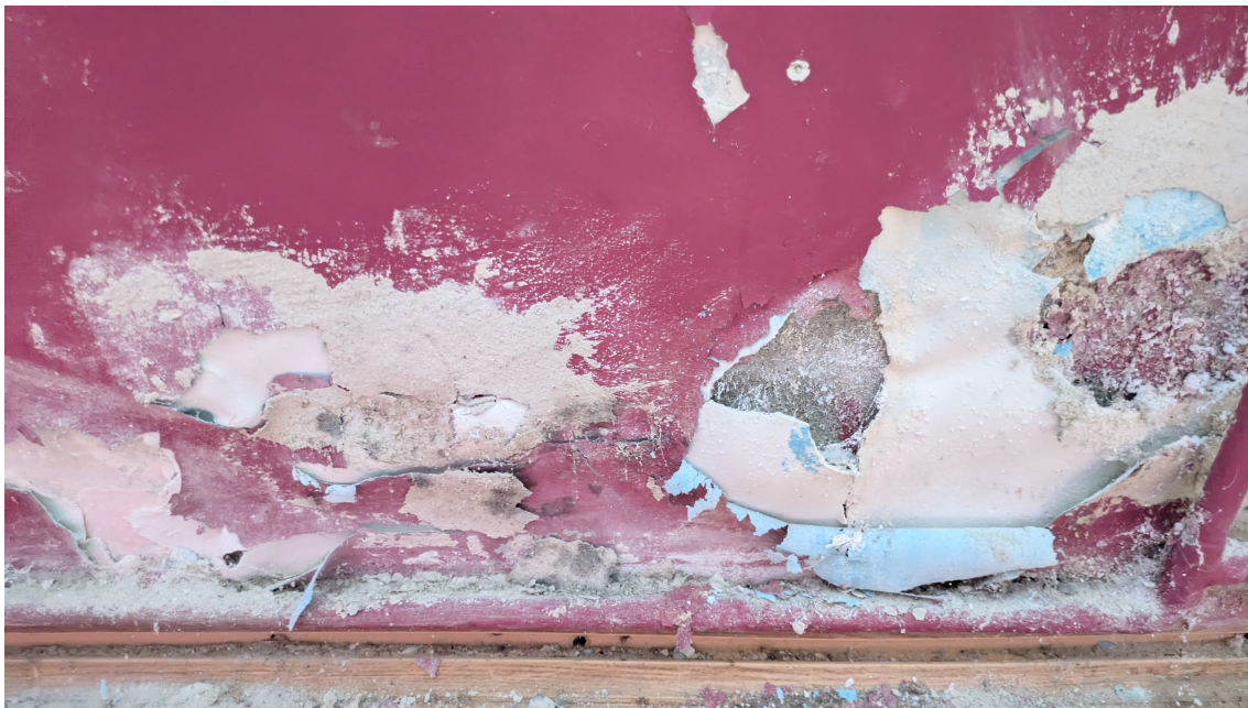
FOT. 2 Zawilgocenie tynków
