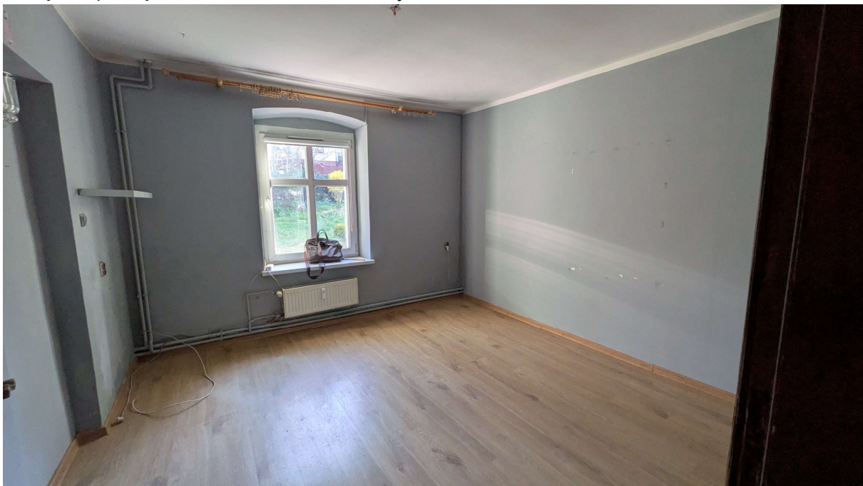
FOT. 3 Pokój od stron wejścia do budynku, wiodoczne "mniejsze" zawilgocenia przy posadzce
