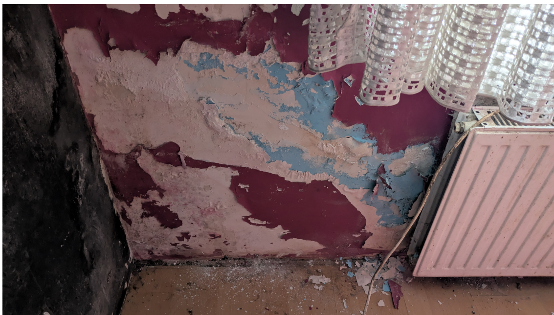
FOT. 1 Zawilgocenie tynków
