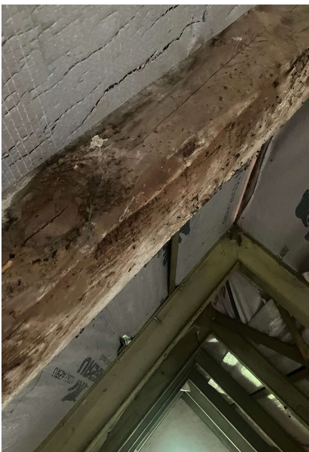
24. Strych – degradowana krokiew do wymiany
