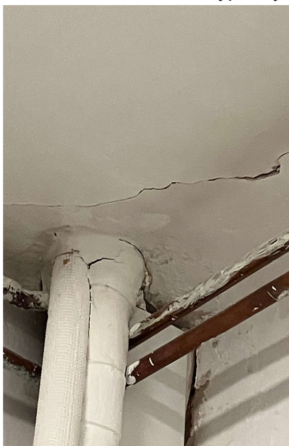
14. Piwnica – spękania stropu Kleina
