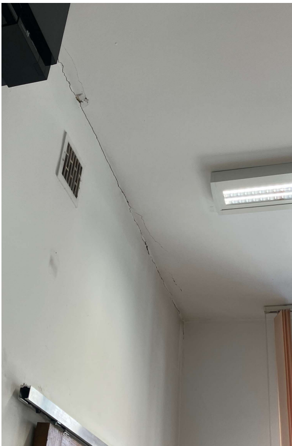
17. Parter – spękanie wzdłuż styku ściany z sufitem
