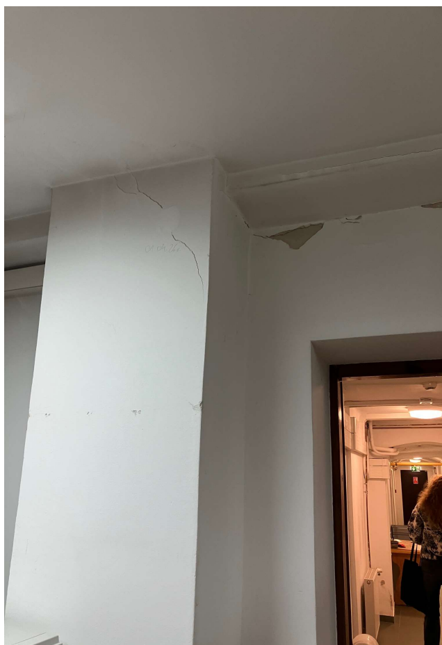
9. Piwnica – archiwum pod tarasem widoczne spękania ścian.
