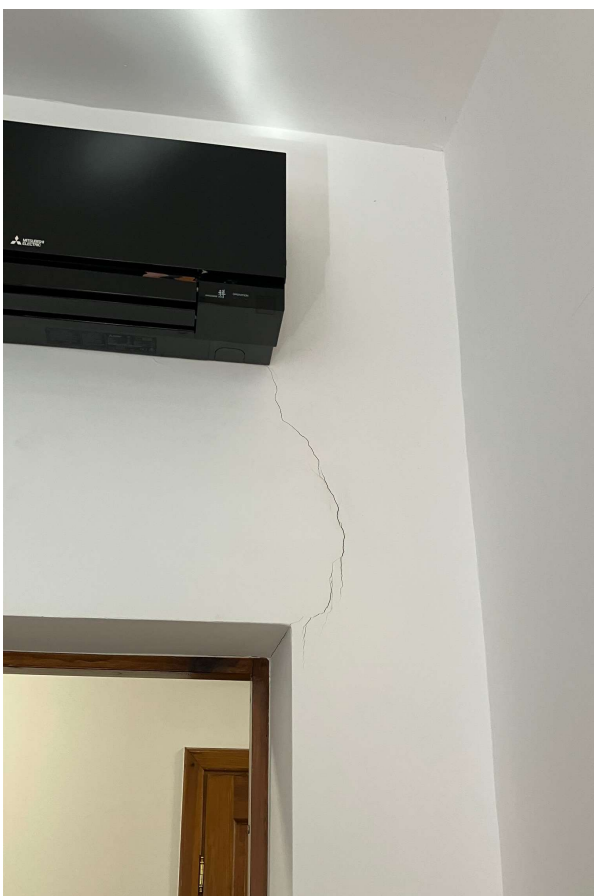
18. Parter – spękanie ściany nośnej
