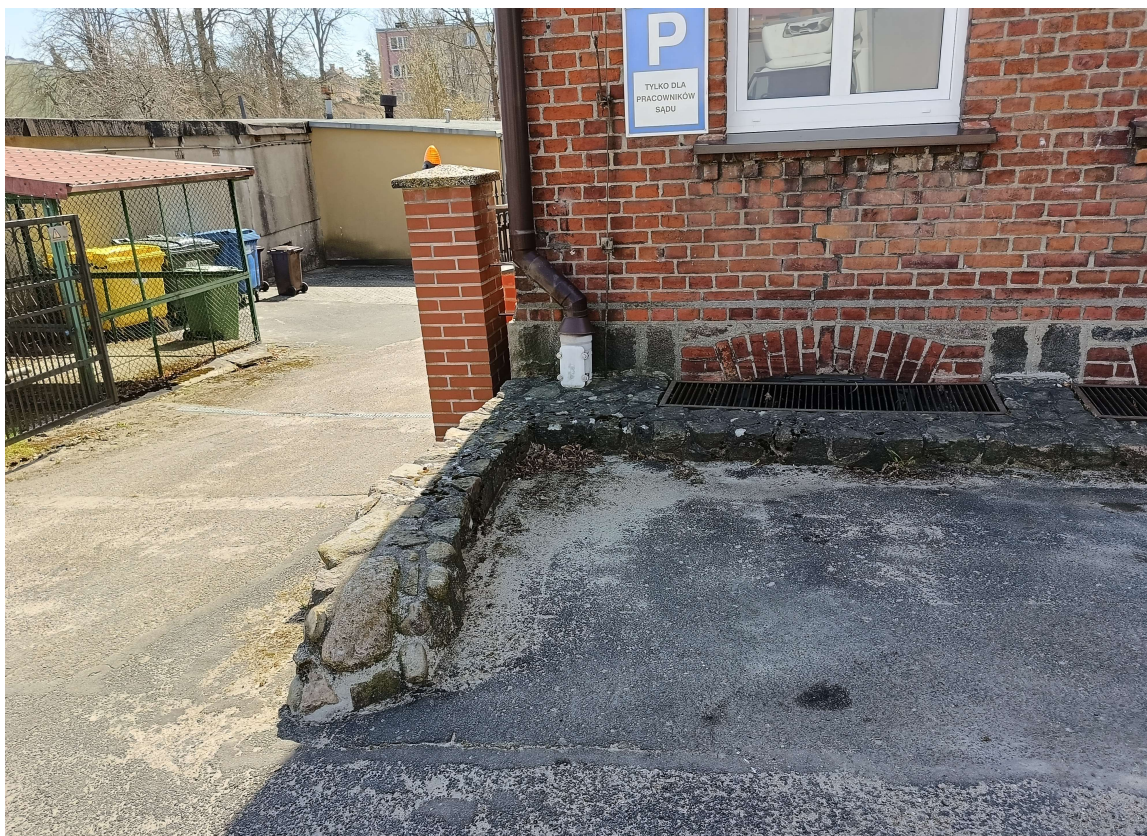
7. Elewacja północna – zjazd na teren posesji z murkiem oporowym. Widoczne spękania muru ceglanego.
