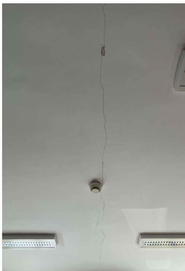
20. Piętro – pęknięcie sufitu na całej szerokości pomieszczenia
