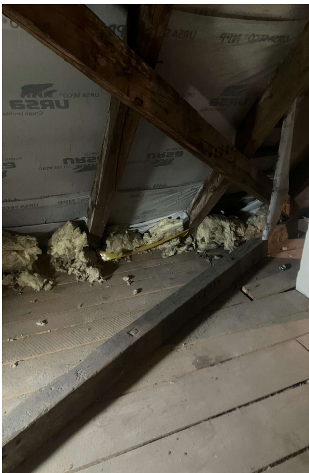
23. Strych – podwalina i belka do usunięcia
