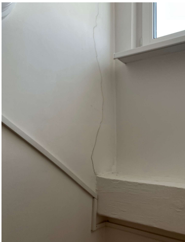
21. Klatka schodowa drewniana – pęknięcie ściany
