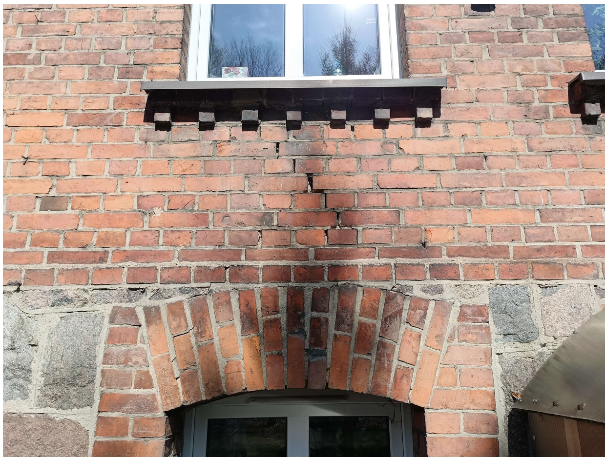
5. Elewacja południowa – widoczne spękanie muru ceglanego w części historycznej.
