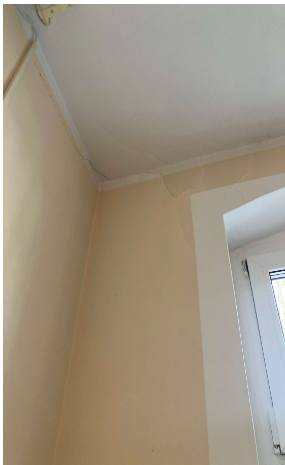
15. Parter – spękania ścian i sufitu
