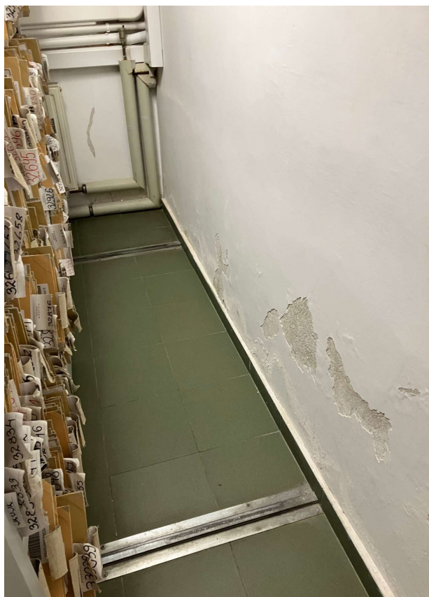
11. Piwnica – degradacja tynków
