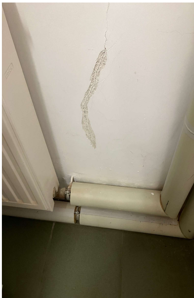
12. Piwnica – spękania ścian zewnętrznych
