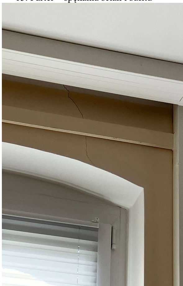
16. Parter – spękane nadproże okienne
