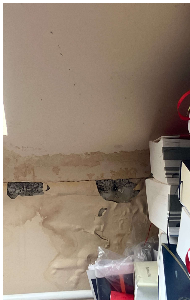
22. Poddasze – degradacja ścian w wyniku zalania pomieszczenia
