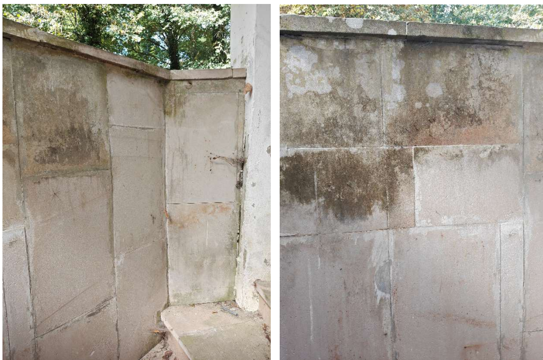
Fot 16. Zawilgocone ściany przy wejściach do pomieszczeń podziemnych od strony północnej
