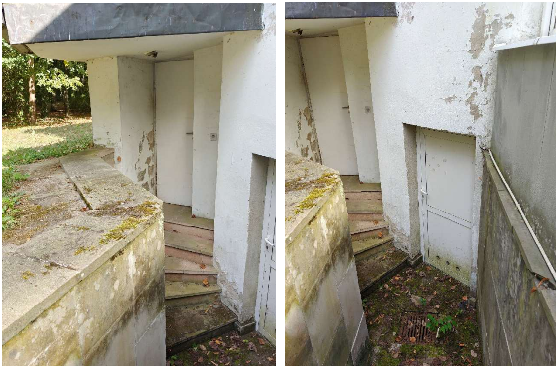
Fot 15. Wejścia do pomieszczeń technicznych od strony północnej (widoczne odparzenia farby na elewacji)
