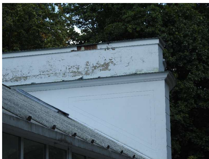
Fot 11. Odpryski farby na części południowo-wschodniej, widziany od strony północno zachodniej
