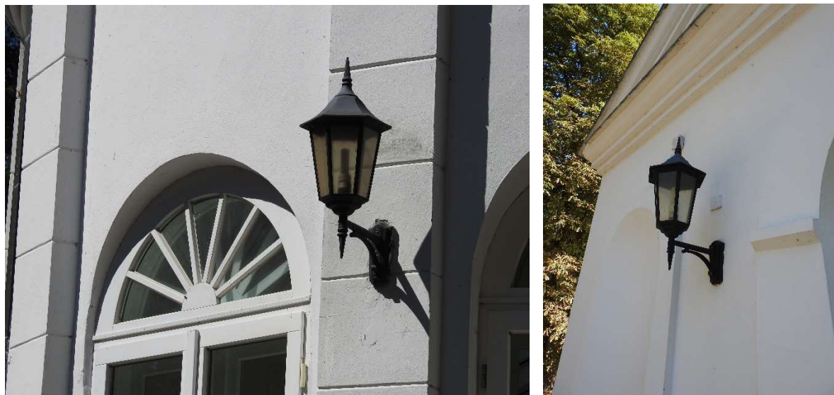
Fot 09. Oświetlenie zewnętrzne na elewacji budynku – po lewej oświetlenie elewacji południowo-wschodniej, po prawej elewacji północno zachodniej
